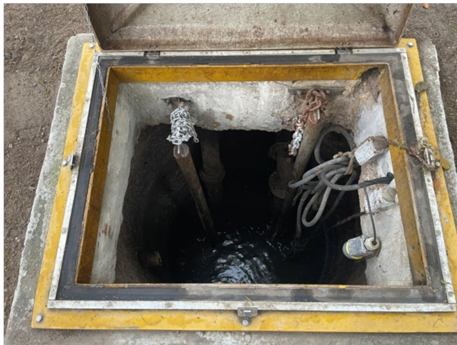
Foto 6 – Barrilete de recalque submerso
