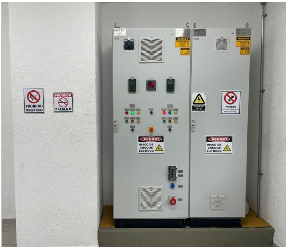
Foto 3 – Painel de comando
