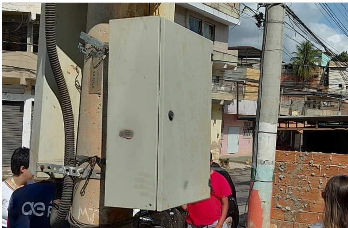
Foto 6 – Abrigo do painel de telemetria sem sinalização de risco de choque elétrico
