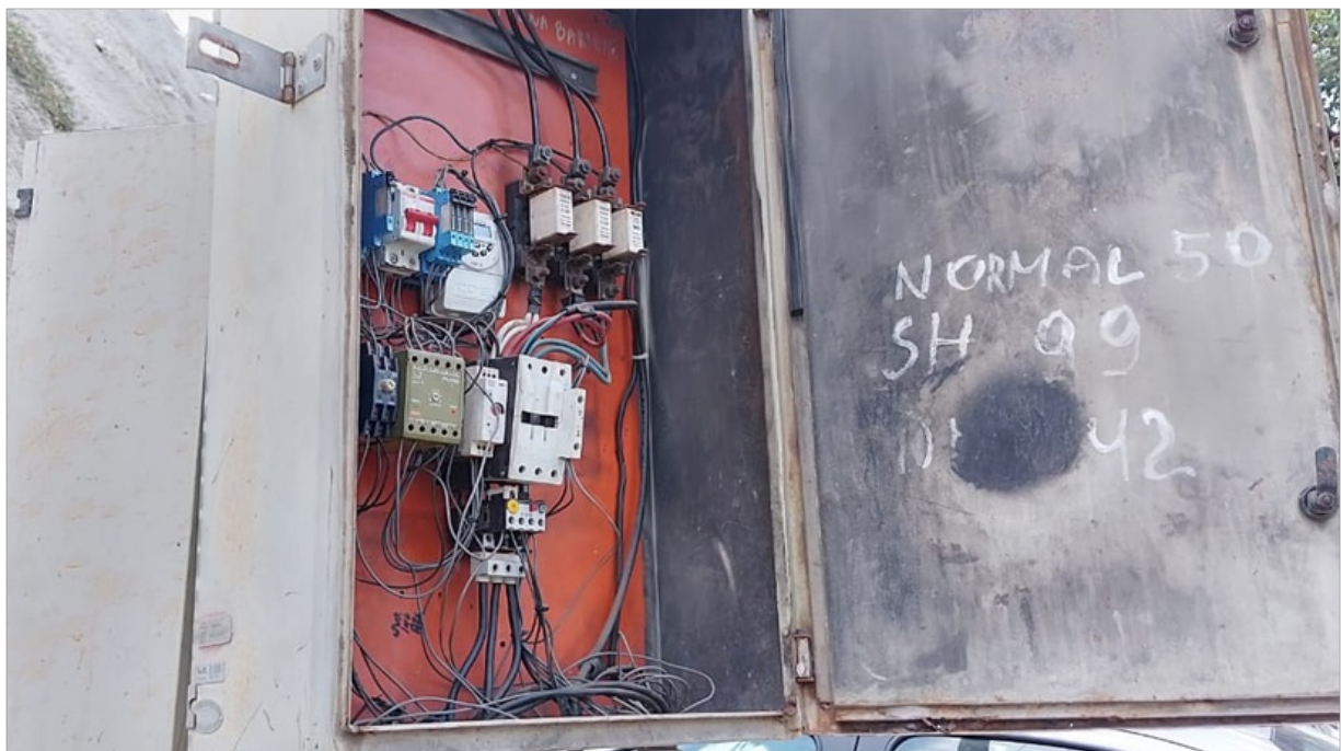
Foto 4 – Interior do abrigo do painel de automação em mau estado de conservação
