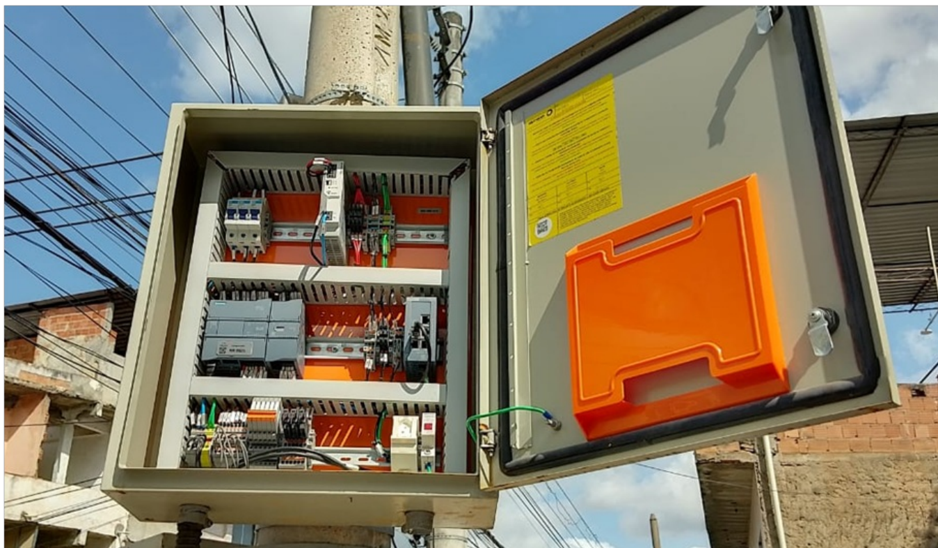
Foto 6 – Interior do painel elétrico com equipamentos em bom estado de conservação
