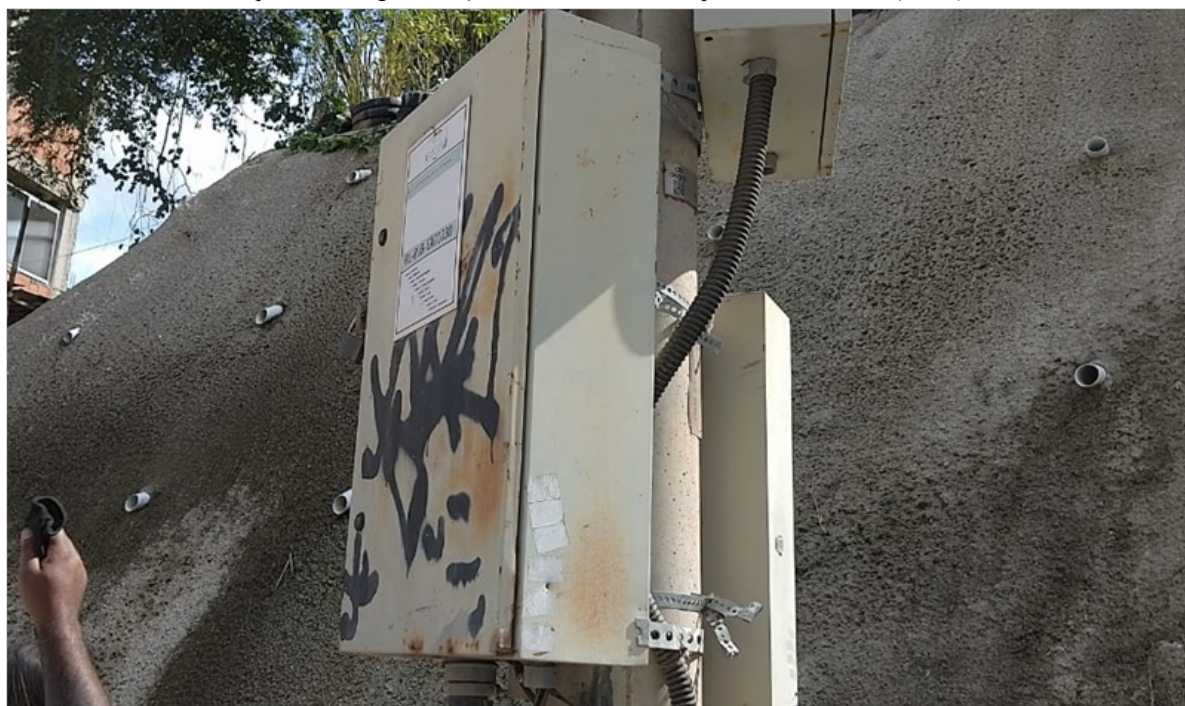
Foto 3 – Abrigo do painel de automação pichado, com identificação da EEAT e sem sinalização de risco de choque elétrico
