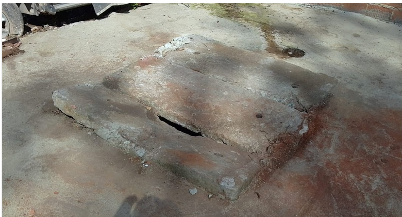
Foto 1 – Abrigo da EEAT com tampas comprometidas
