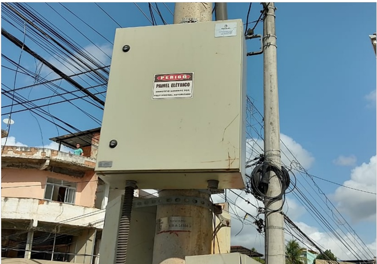
Foto 5 – Abrigo do quadro elétrico com sinalização de risco de choque elétrico
