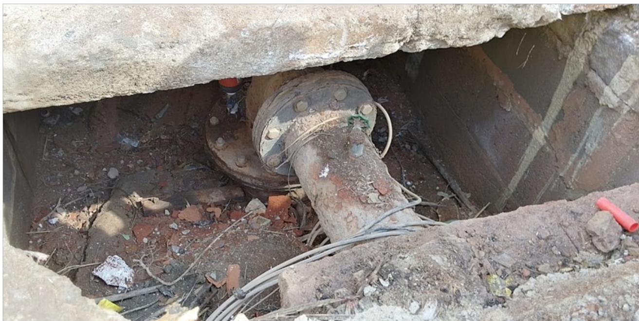
Foto 2 – Interior do abrigo subterrâneo com a visualização da jaqueta da motobomba bastante deteriorada e a presença de muitos resíduos
