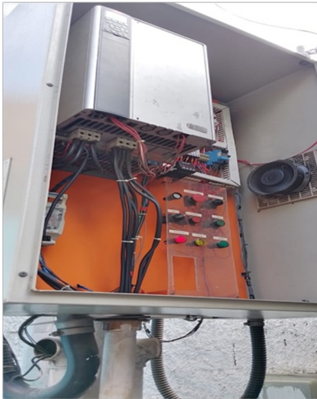
Foto 04 - Pannel de controle da EEAT.
