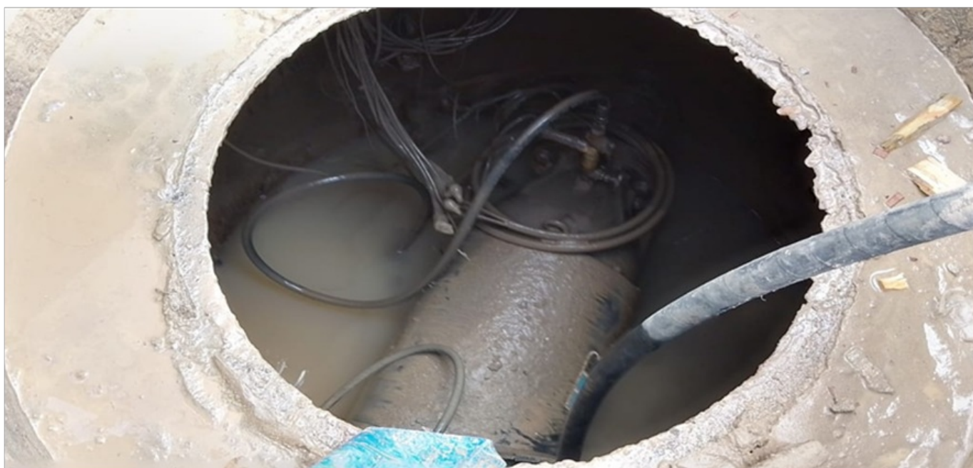
Foto 03 – Vista do interior do abrigo do conjunto motobomba.
