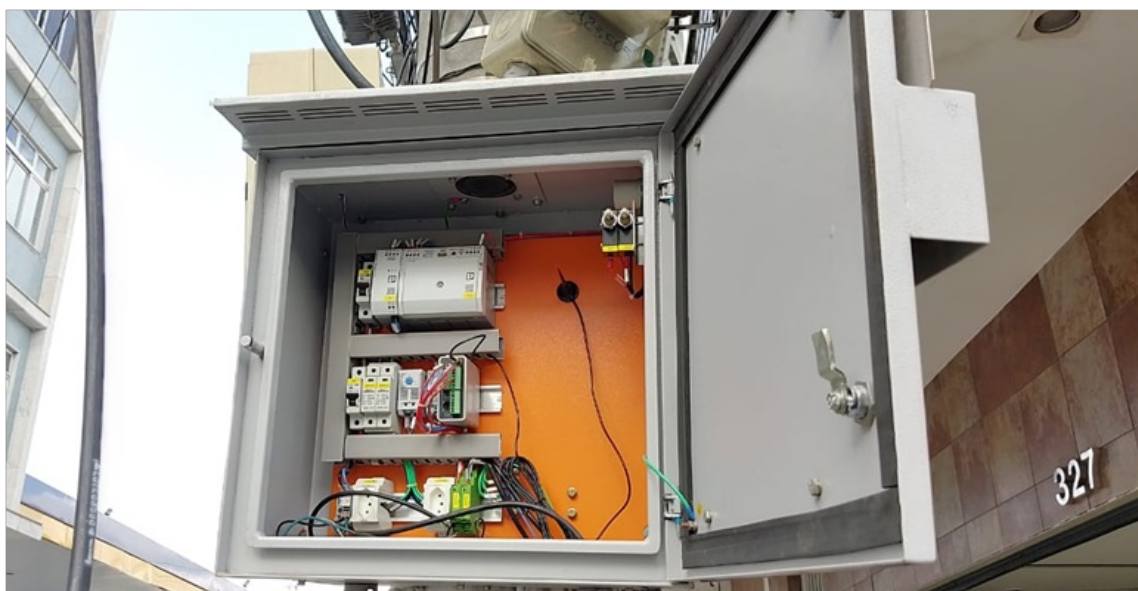
Foto 5 - Painél elétrico aberto sem sinalização de risco de choque elétrico
