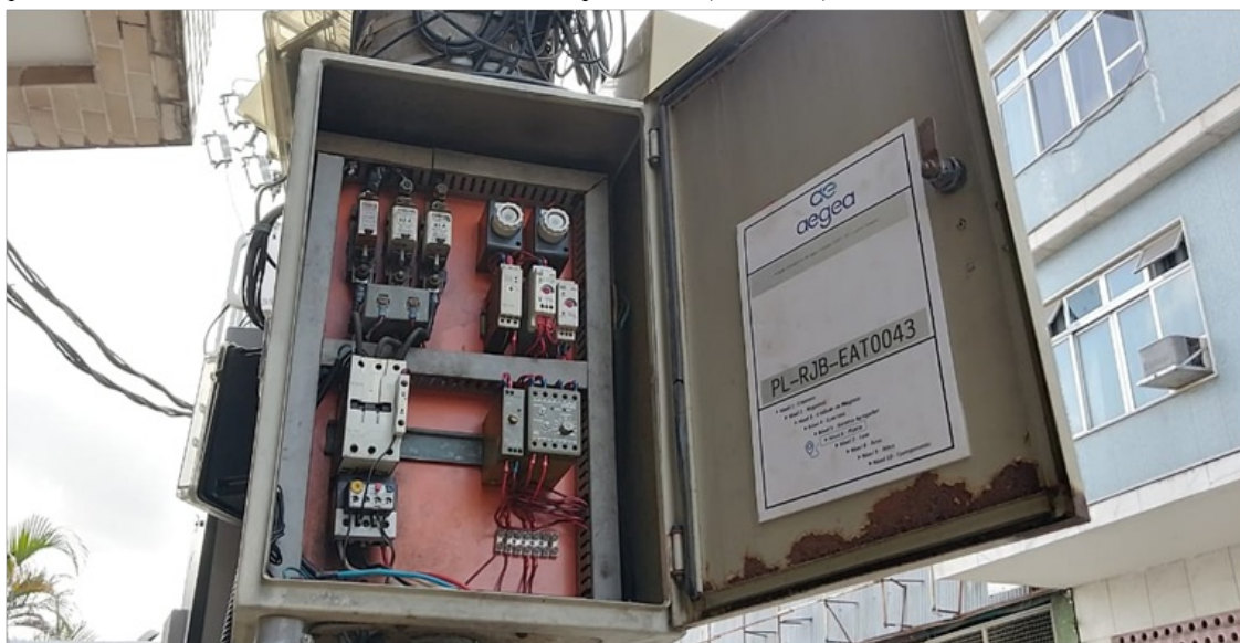
Foto 4 - Painél de automação aberto sem sinalização de choque elétrico
