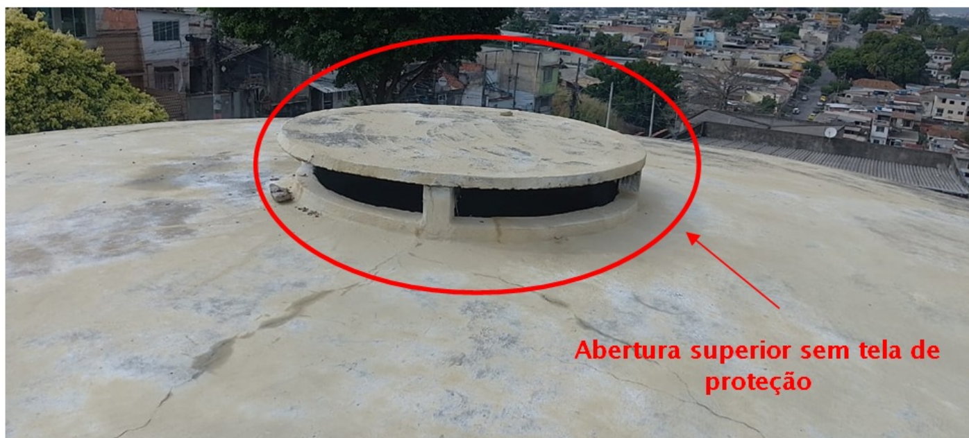
Figura 5 - Topo do reservatório com abertura desprotegida
