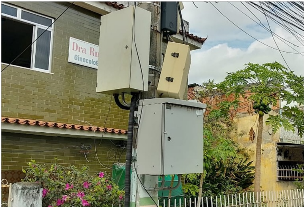
Foto 4 - Abrigos dos painéis elétricos da estação não identificados e sem sinalização de risco de choque elétrico
