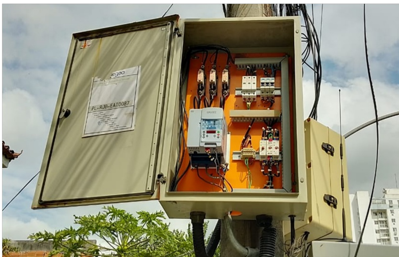
Foto 6 - Painelede automacao em bom estado de conservacao
