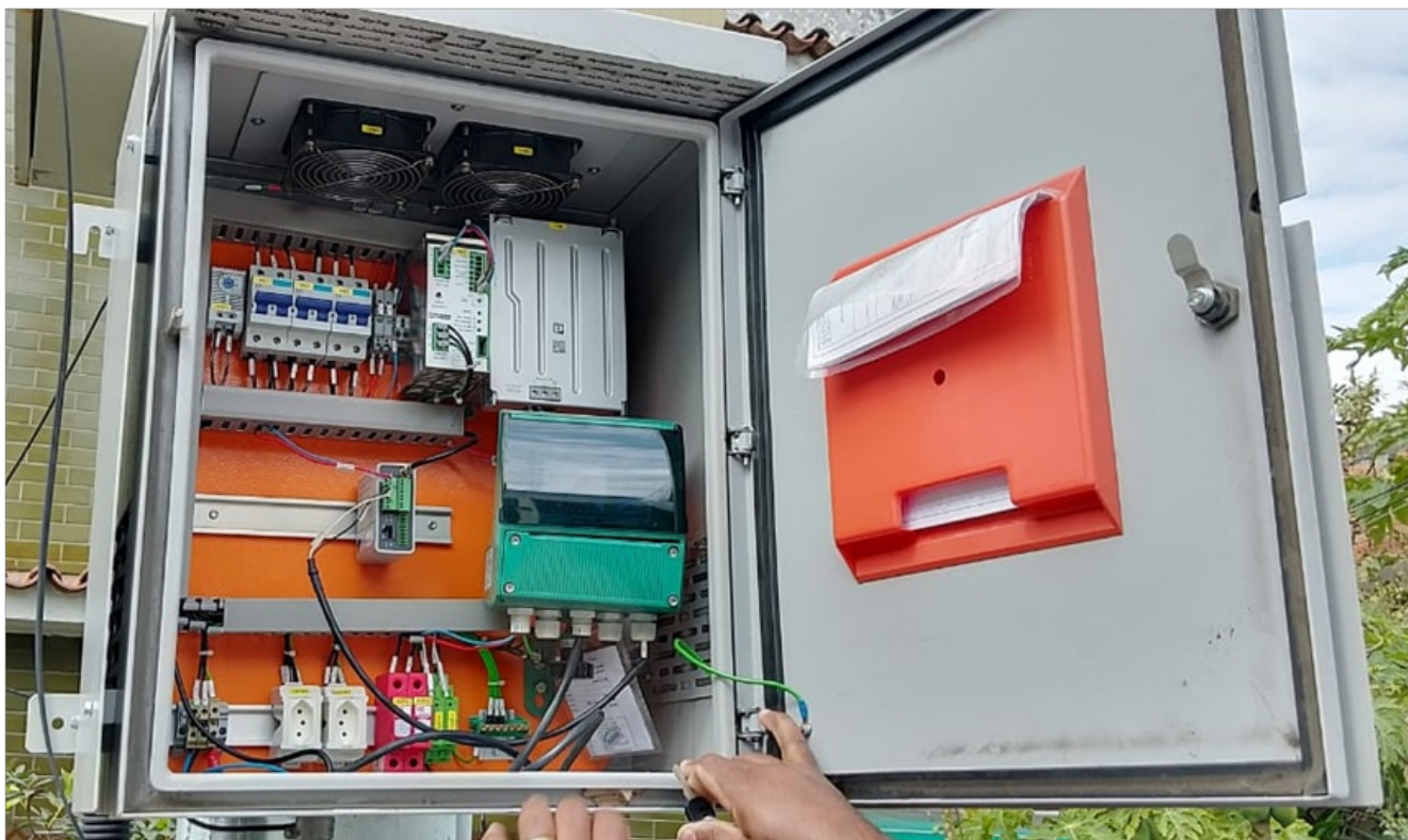
Foto 5 - Paineleletrico em bom estado de conservacao
