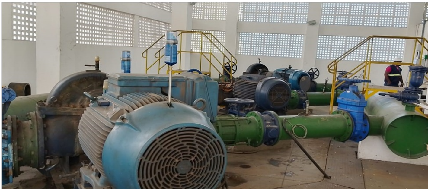
Foto 02 – Área interna da casa de bombas do booster Nilópolis.
