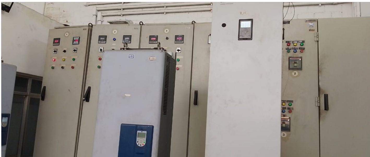
Foto 03 – Painéis de controle das bombas.
