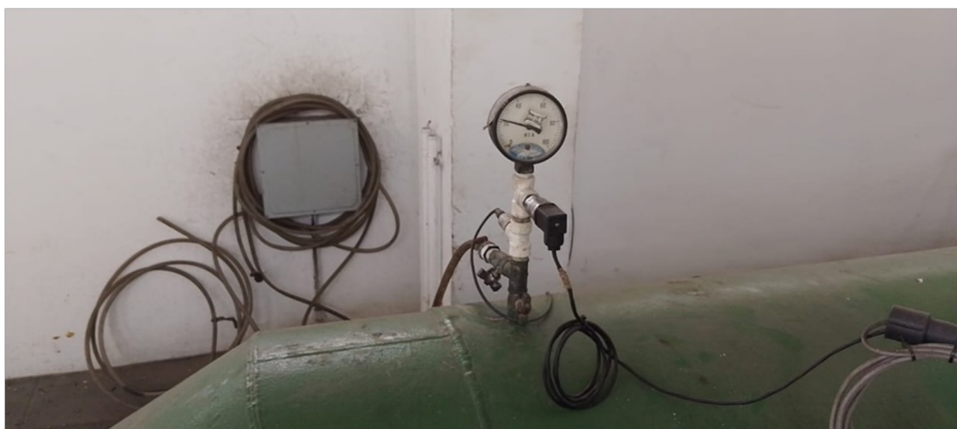
Foto 08 – Manômetro de montante.
