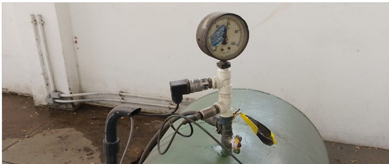
Foto 07 – Manômetro de jusante.
