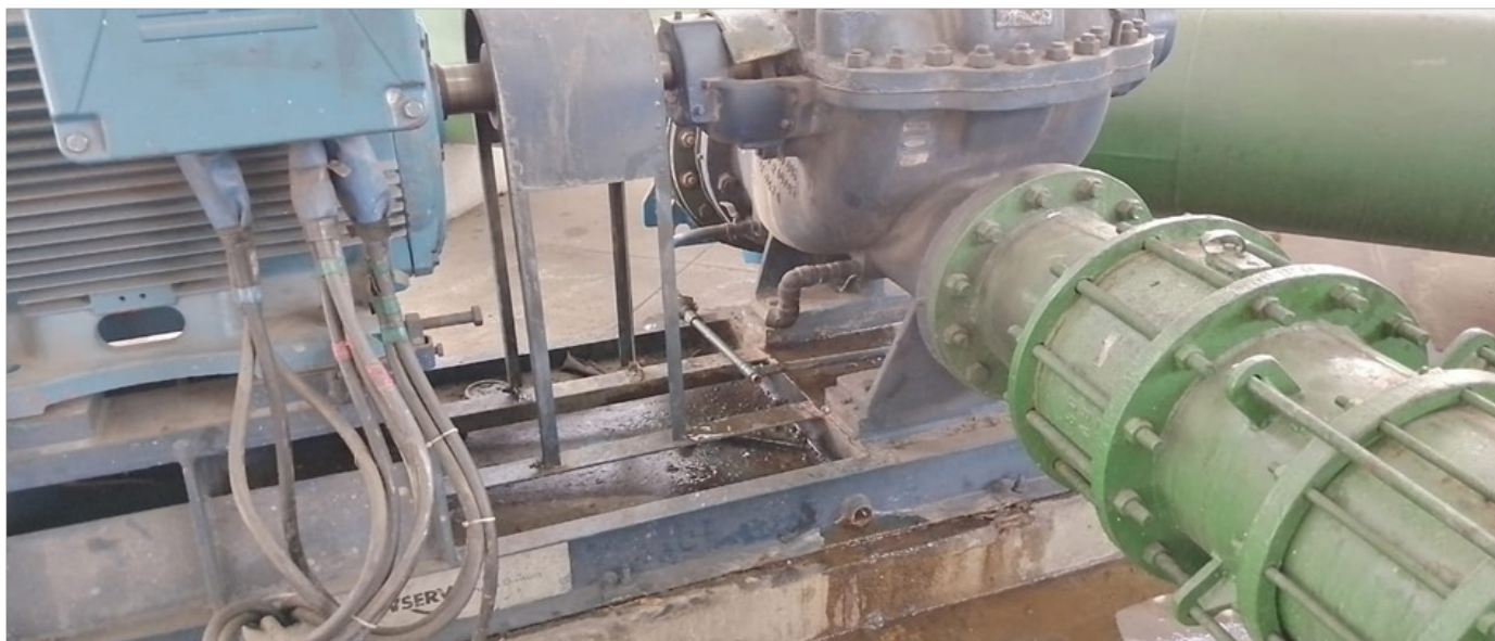
Foto 05 – Sinais de vazamentos no conjunto motobomba.
