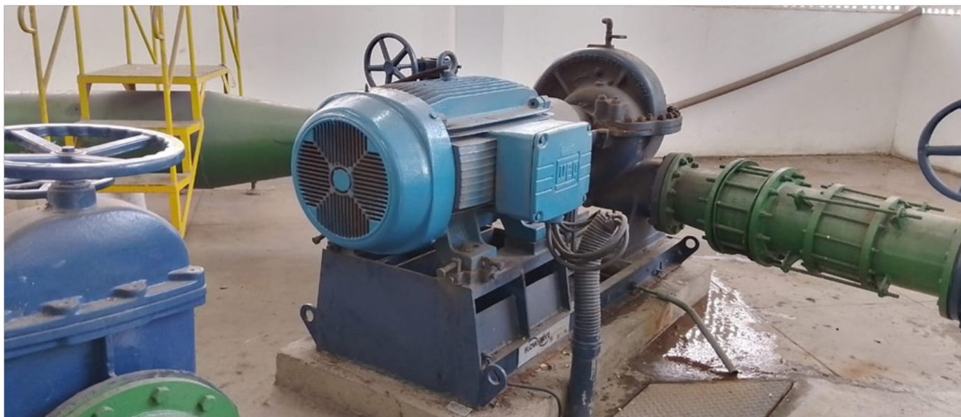
Foto 04 – Vista de um dos conjuntos motobomba de potência 200 CV.
