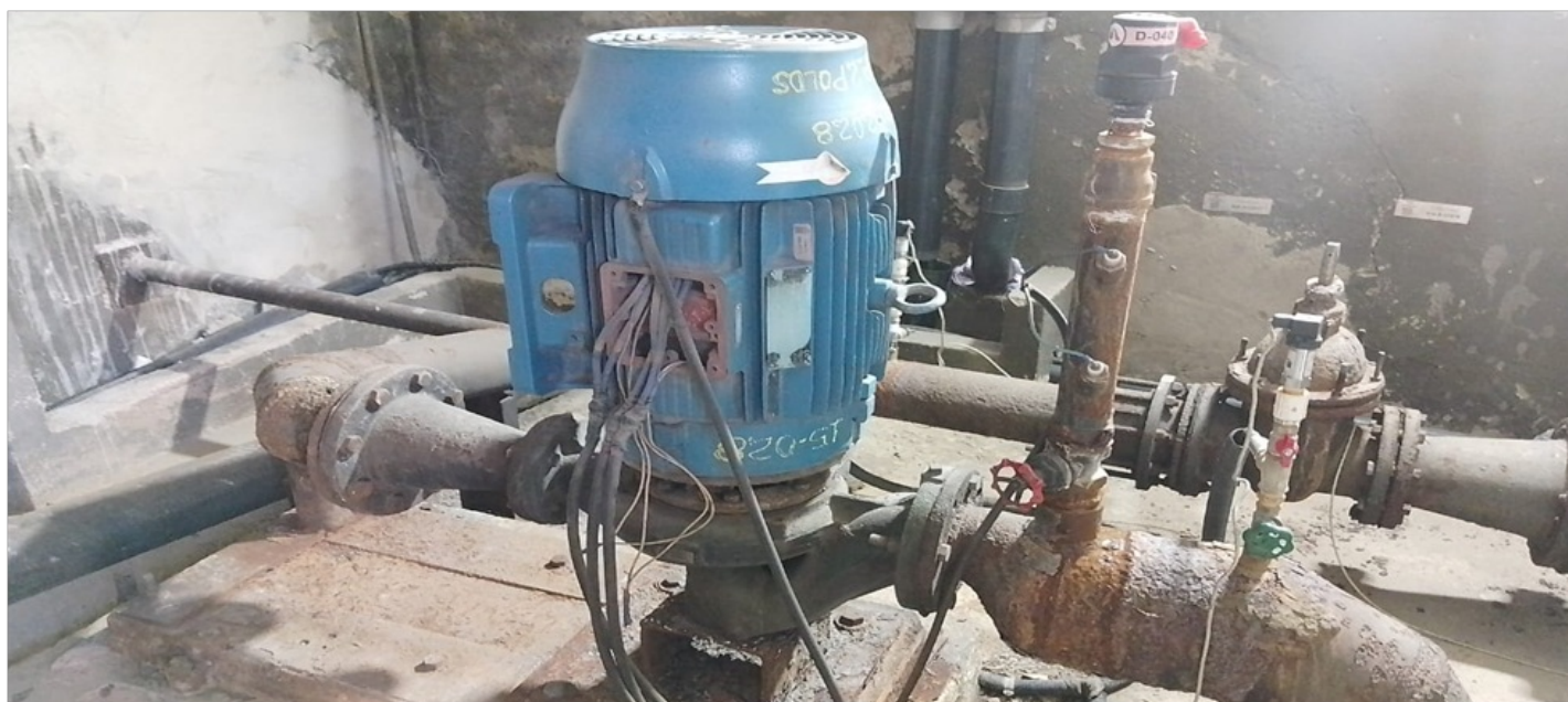
Foto 05 – Conjunto motobomba Grupo 2 (Potência de 40 CV).
