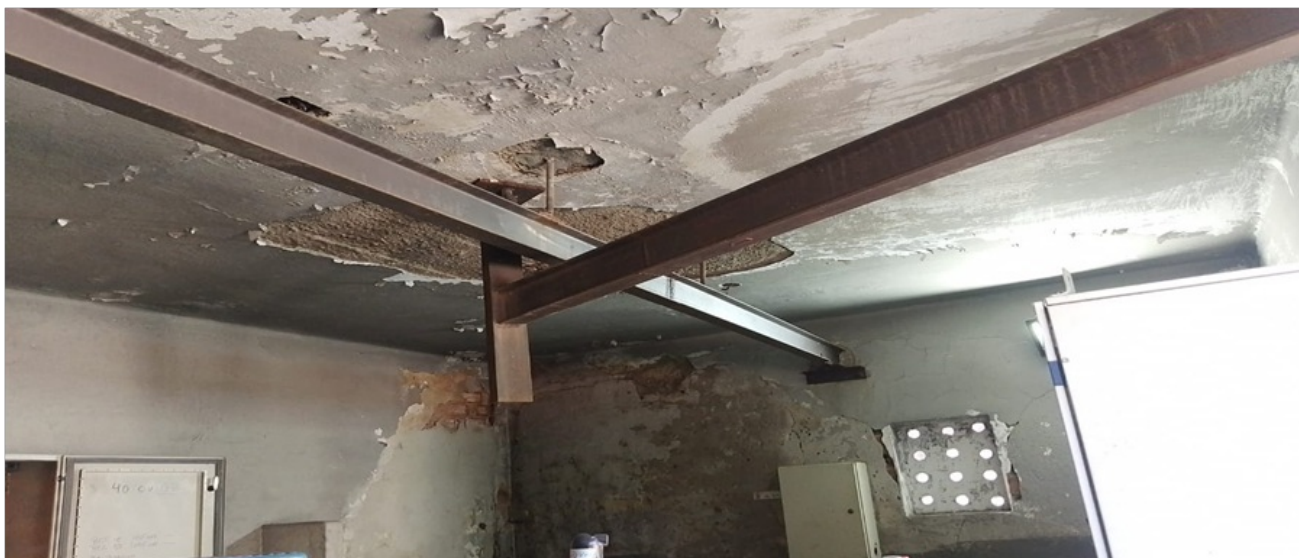
Foto 10 – Paredes com rachaduras e infraestrutura necessitando de manutenção.
