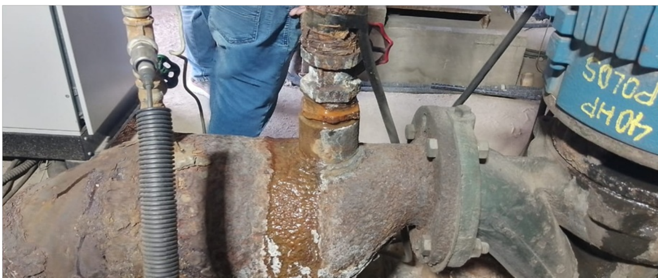
Foto 08 – Sinais de vazamento no registro do conjunto motobomba 2.
