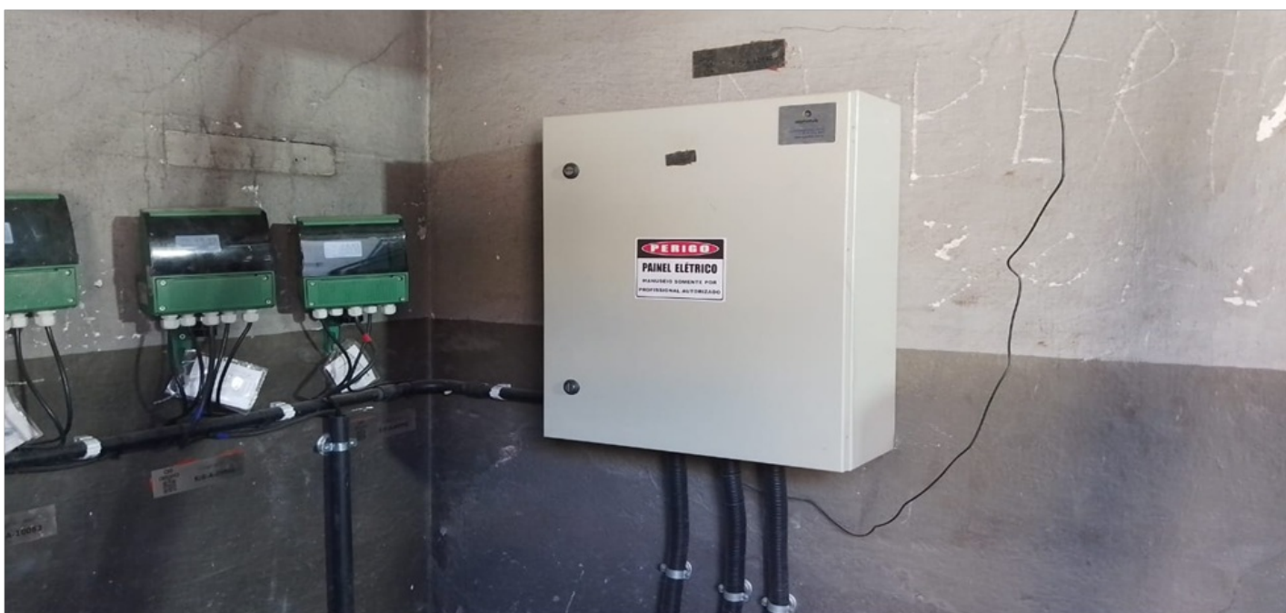
Foto 03 – Vista do painel elétrico de controle da estação.
