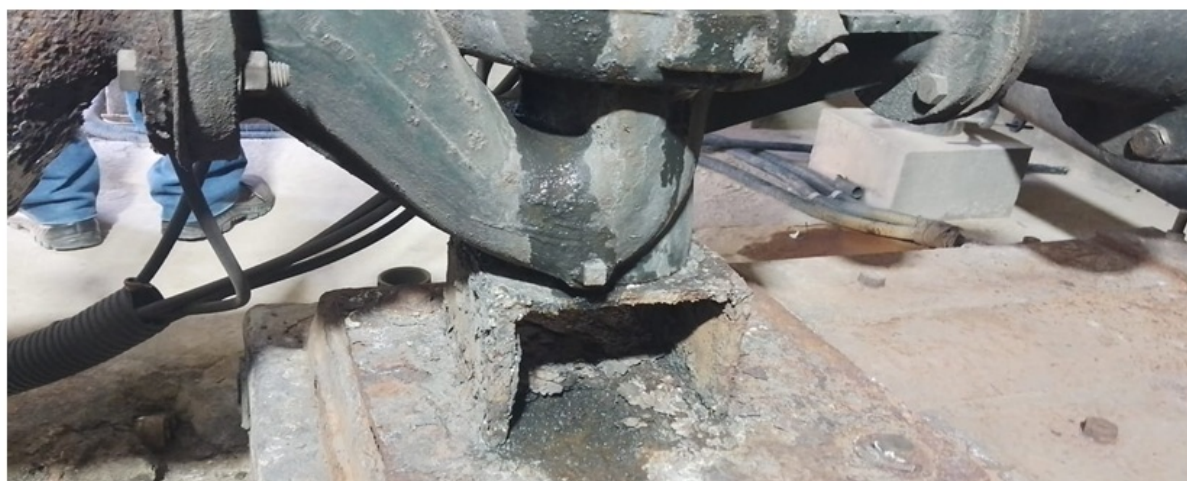
Foto 09 – Sinais de vazamento no conjunto motobomba 2.
