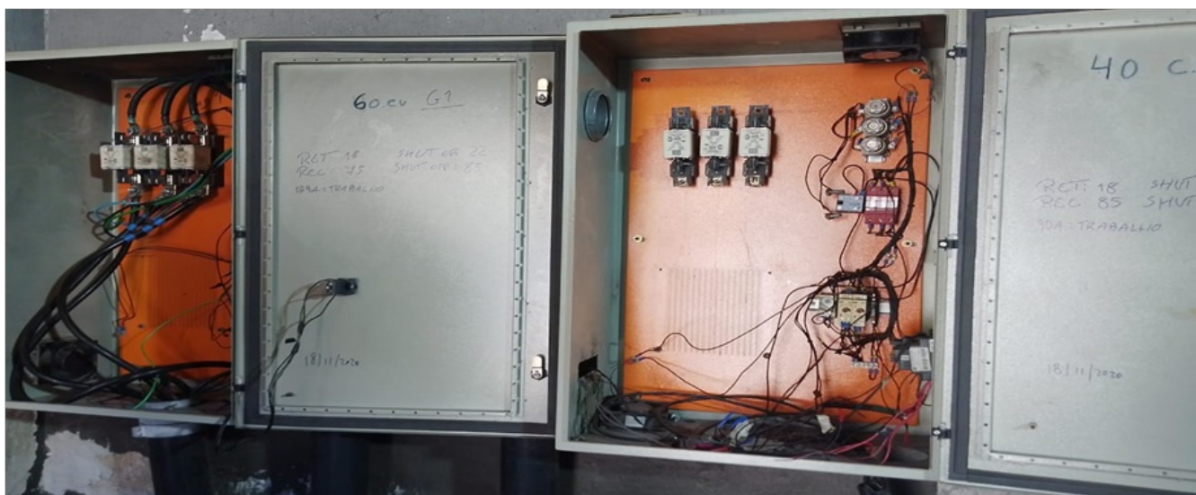
Foto 07 – Abrigos dos painéis de automação abertos.
