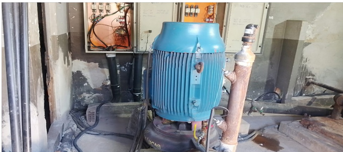
Foto 04 – Conjunto motobomba Grupo 1 (Potência de 60 CV).
