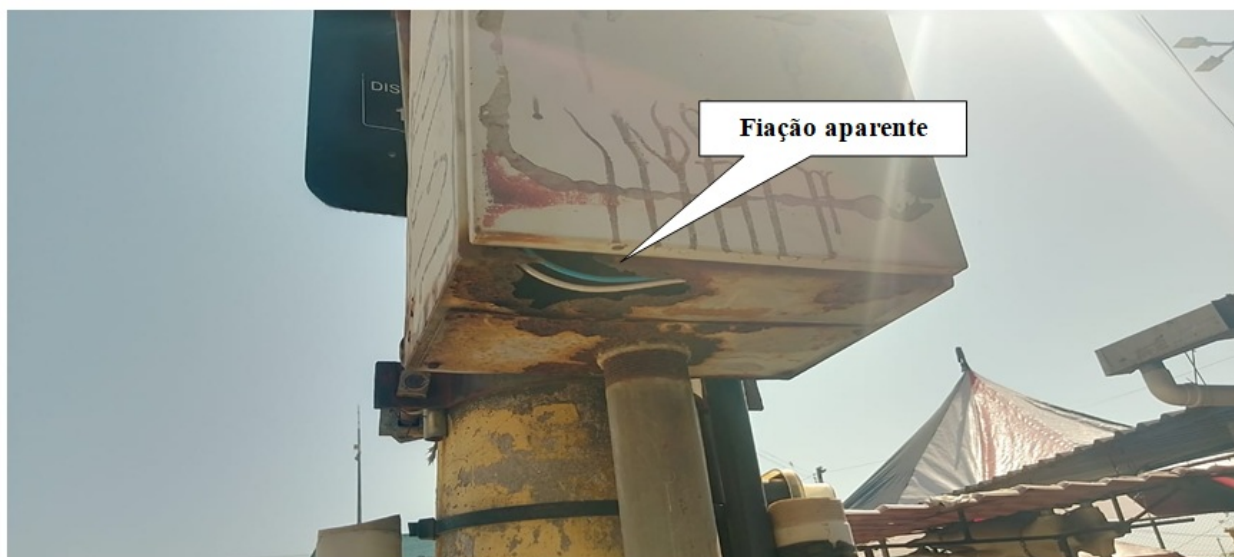
Foto 03 – Equipamentos elétricos desprovidos de proteção apropriada.
