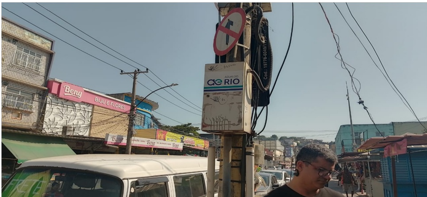
Foto 02 – Abrigo do painel elétrico com identificação.
