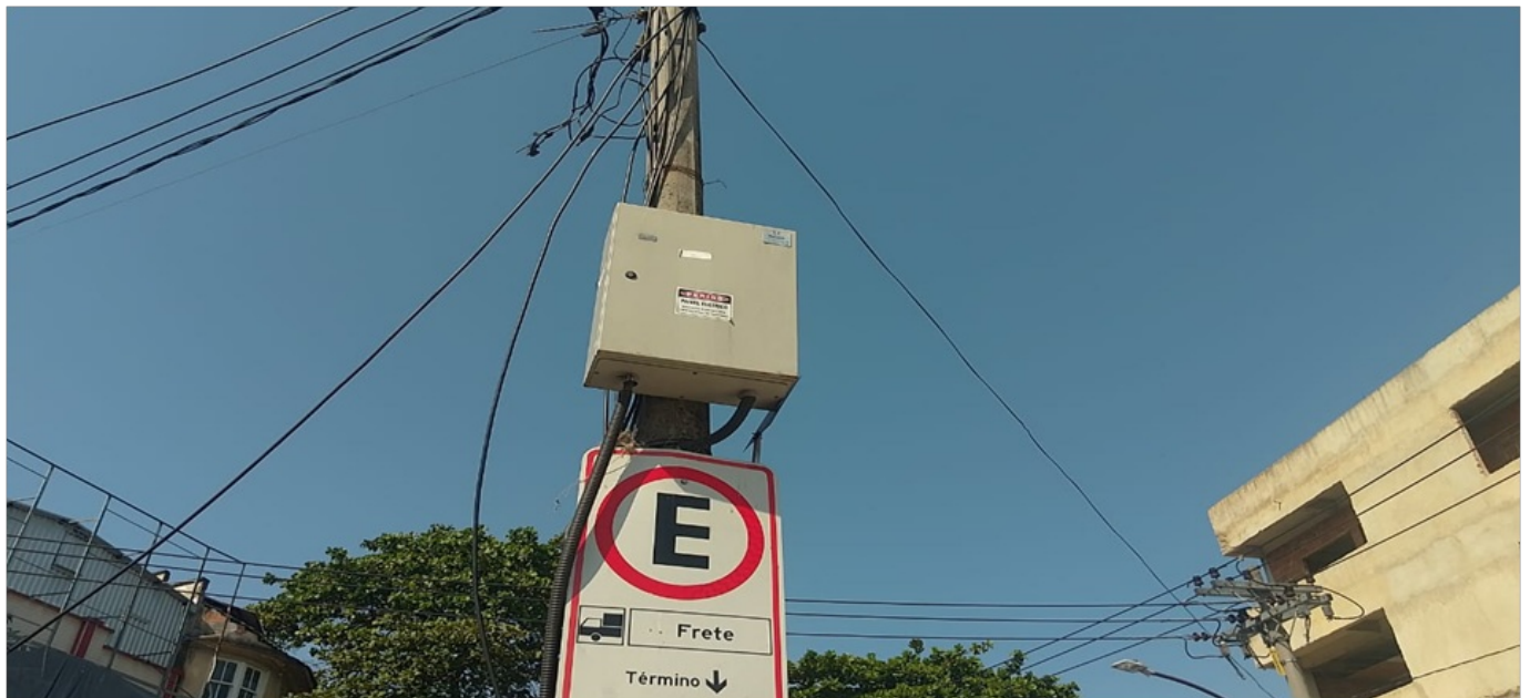
Foto 05 – Pannel elétrico da estação elevatória.
