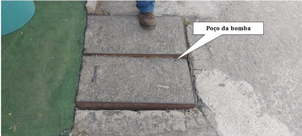
Foto 01 – Localização da EEAT na calçada da via pública.
