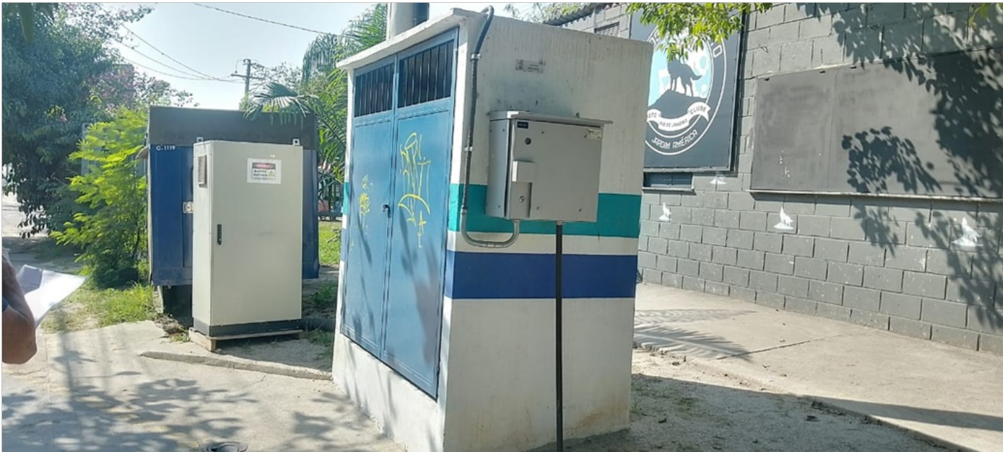
Foto 01 – Vista geral da estação, destaca-se que não há identificação.
