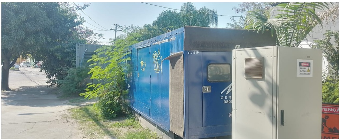
Foto 04 - Vista do gerador de energia e abrigo do painel elétrico da estação elevatória.
