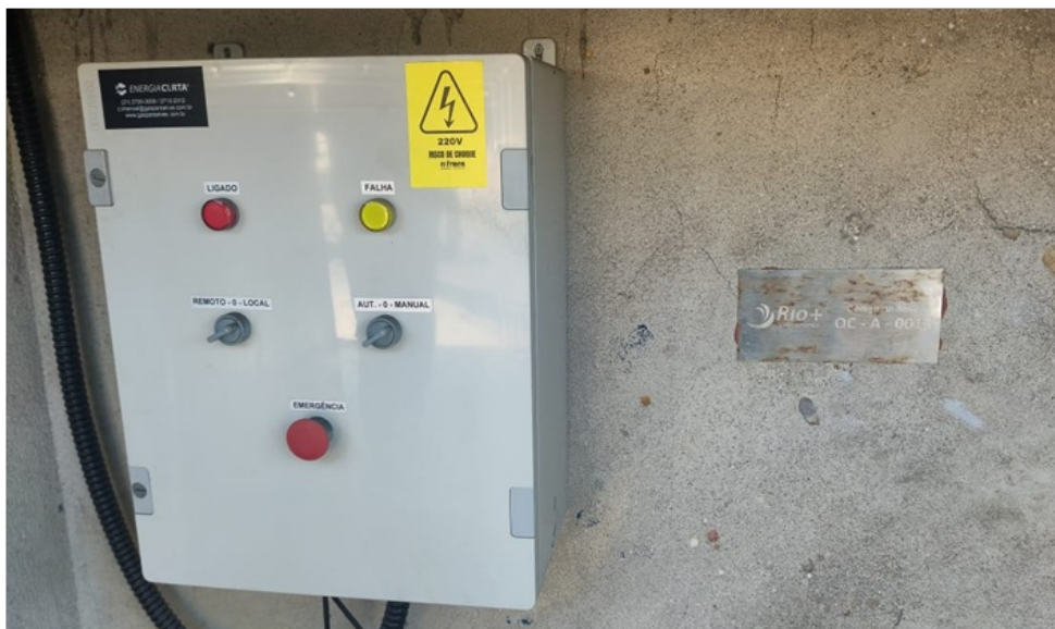
Foto 3 - Painel de automação fechado e com sinalização de risco de choque elétrico.
