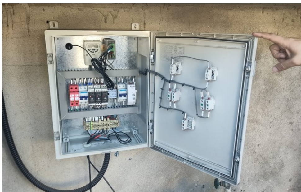
Foto 4 - Painel de automação aberto, em bom estado de conservação.
