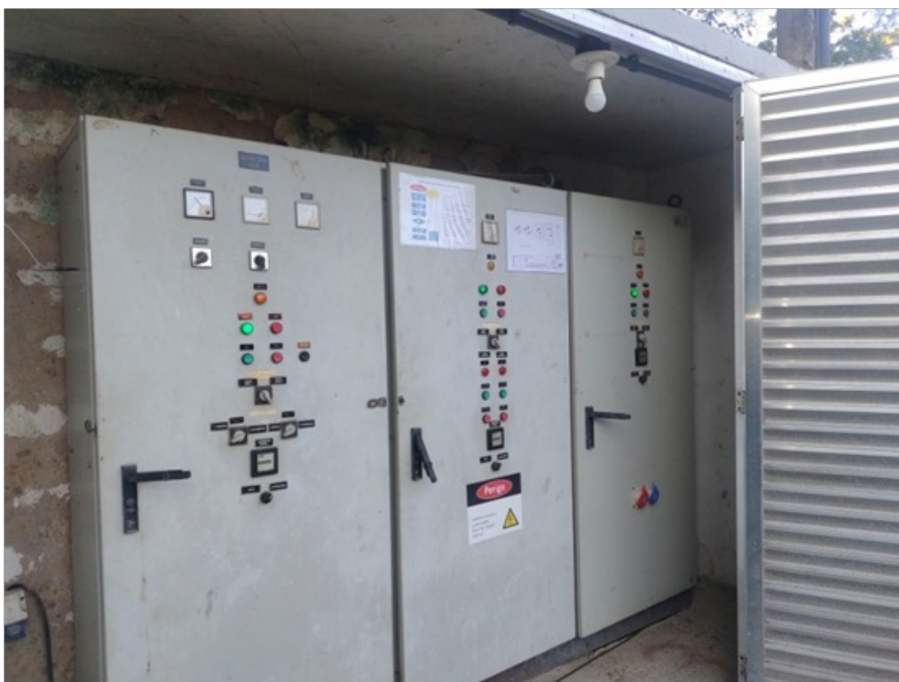
Foto 6 – Abrigo quadro elétrico
