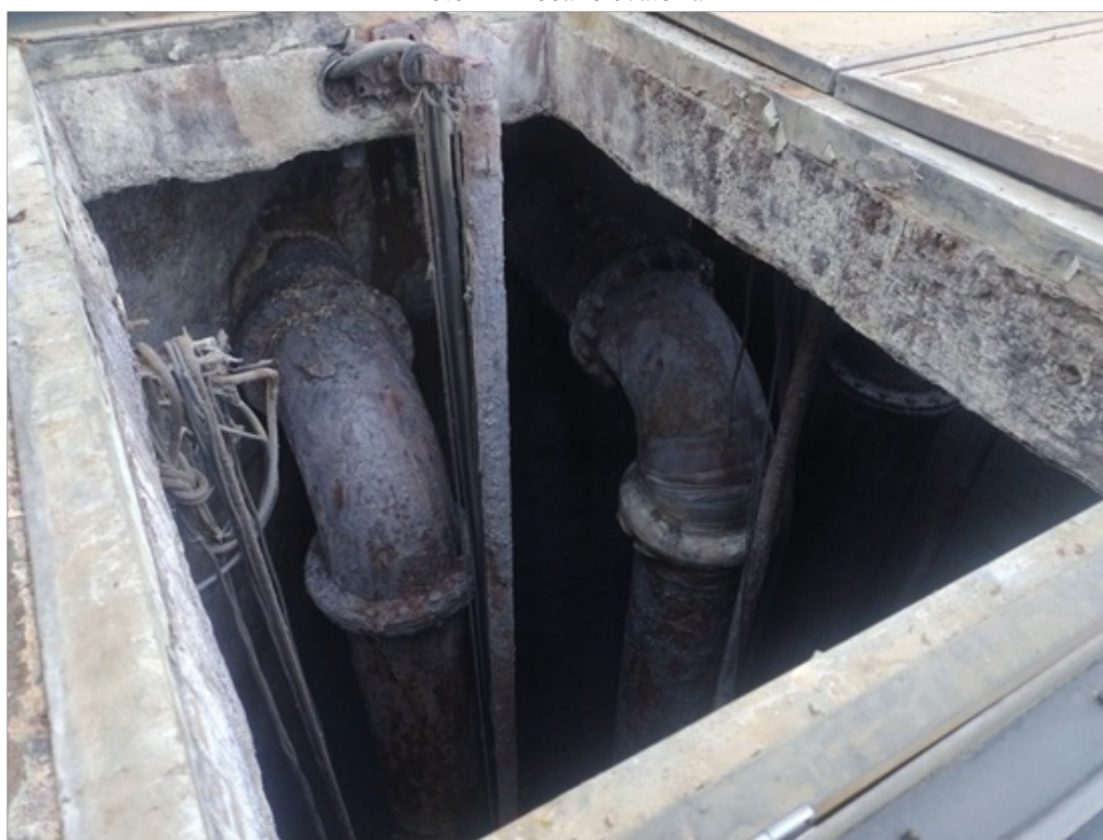
Foto 2 – Poço de sucção
