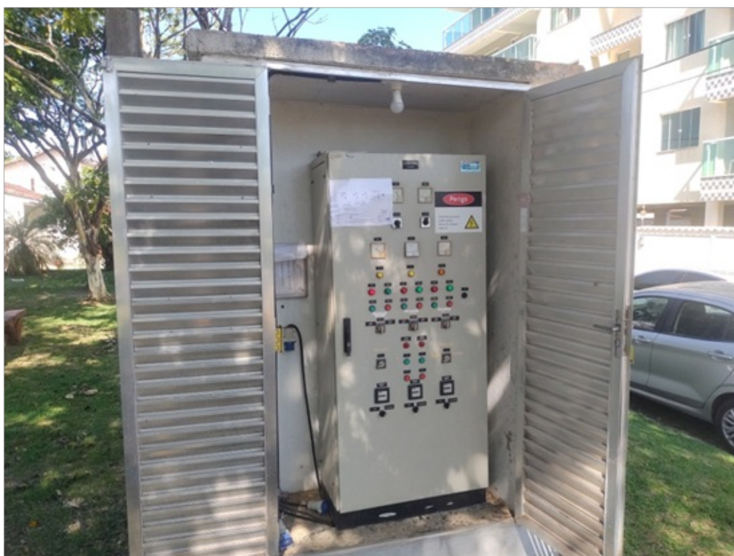
Foto 2 – Abrigo quadro elétrica
