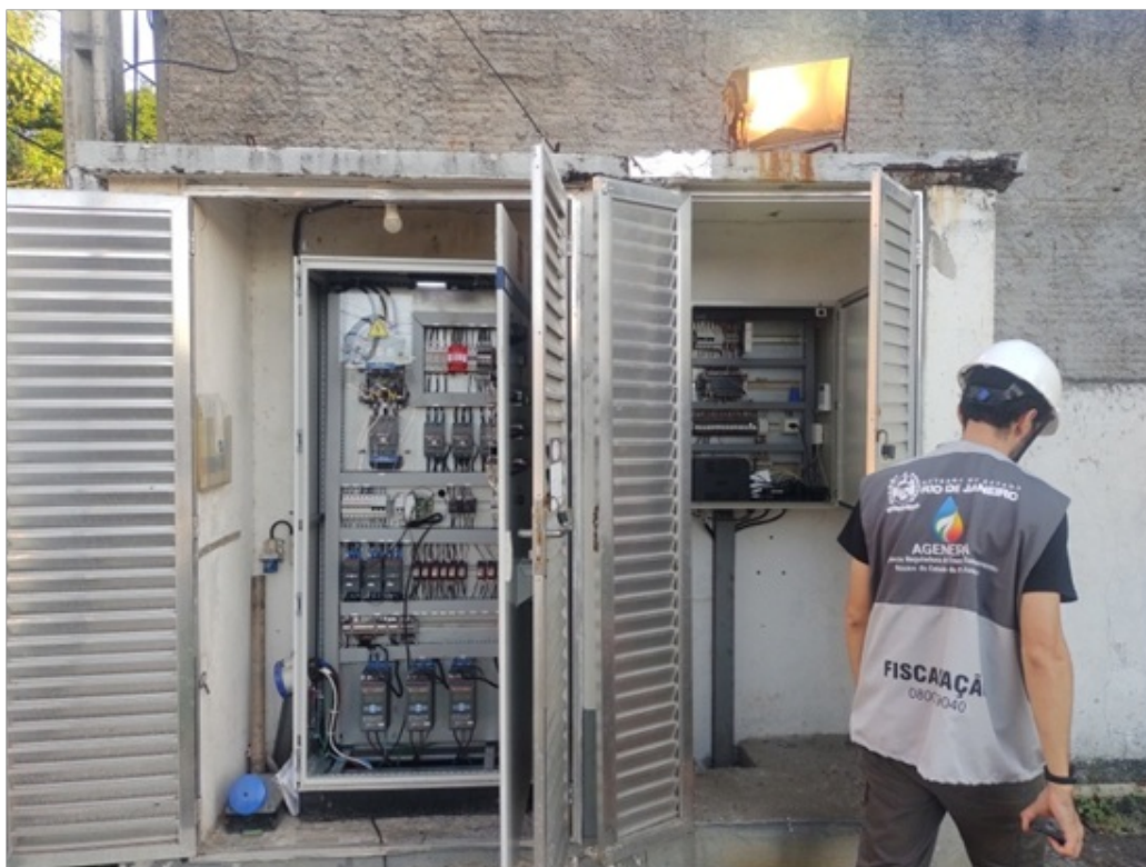
Foto 3 – Abrigo quadro elétricos e automação
