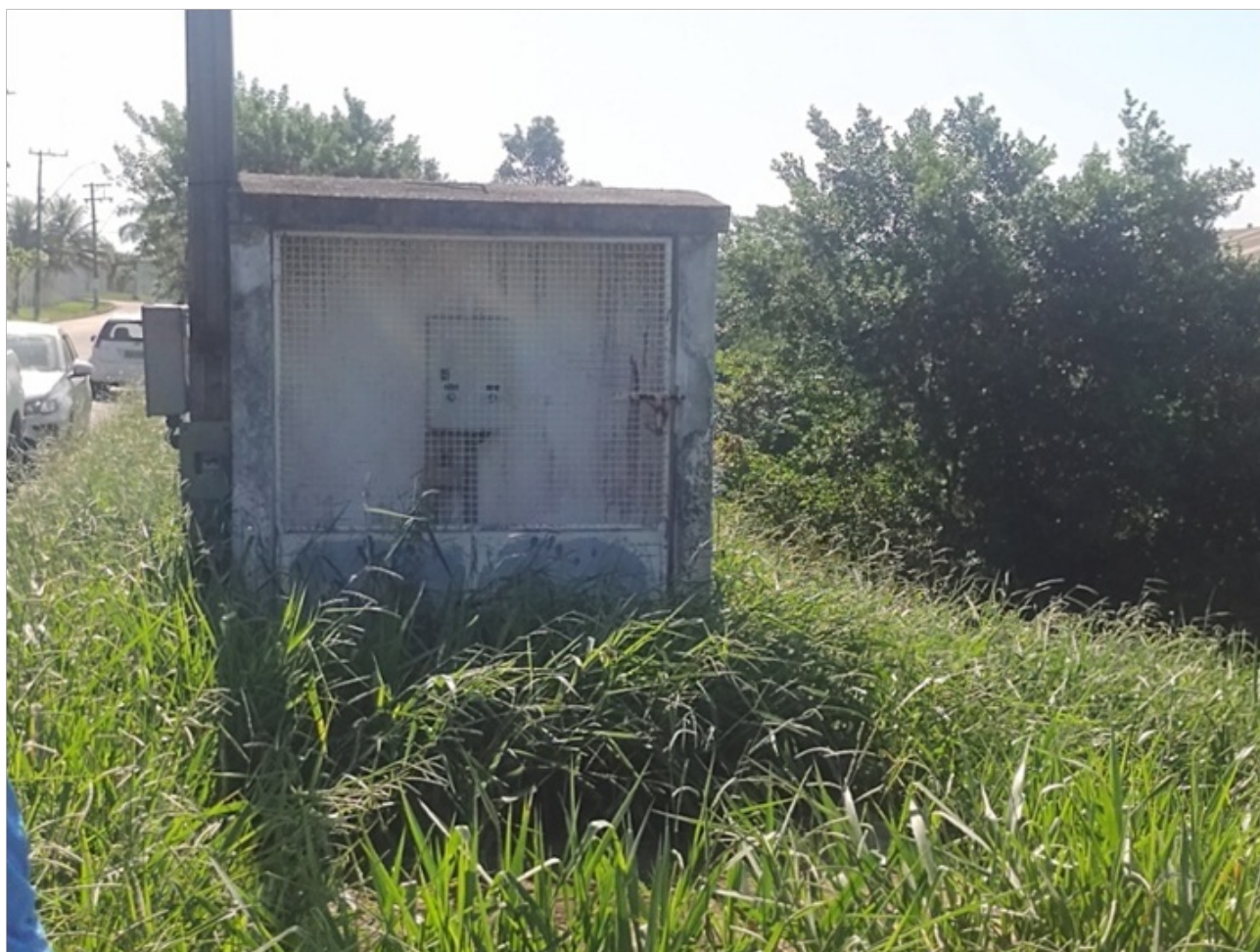
Foto 4 – Abrigo quadro elétrica
