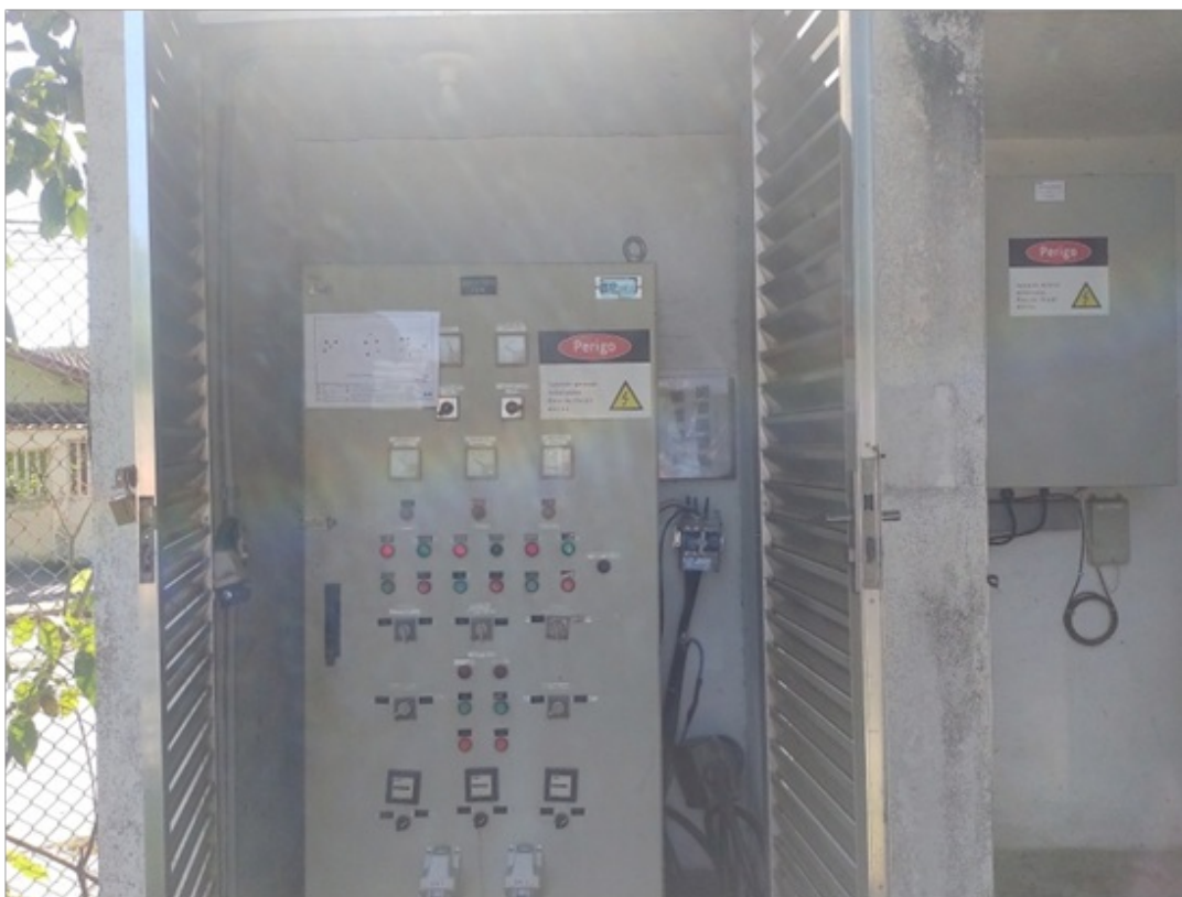
Foto 5 – Quadro elétrica e automação
