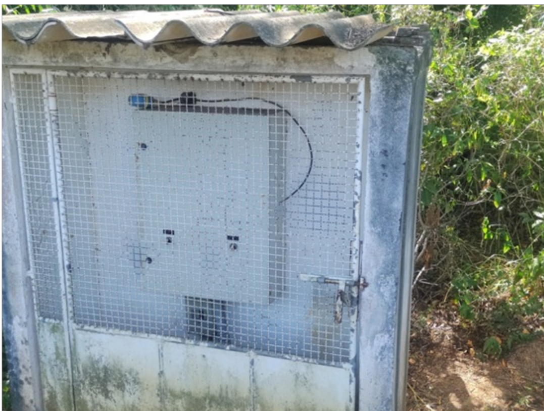
Foto 4 - Abrigo quadro elétrico
