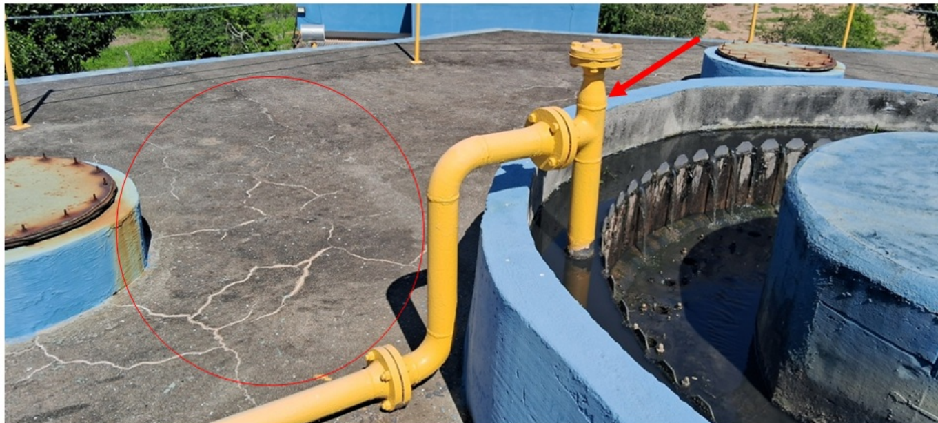
Foto 7 – Laje reator com tubulação de biogás em evidência
