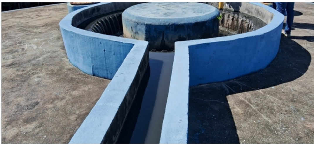
Foto 6 - Chegada de efluente ao reator
