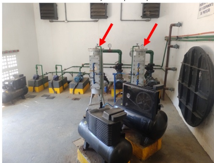
Foto 24 – Casa de bombas em evidência flotflux
