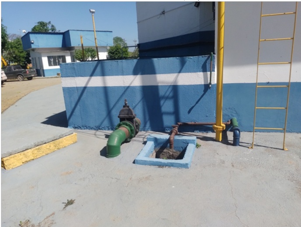
Foto 17 - Tubulação de saída do efluente
