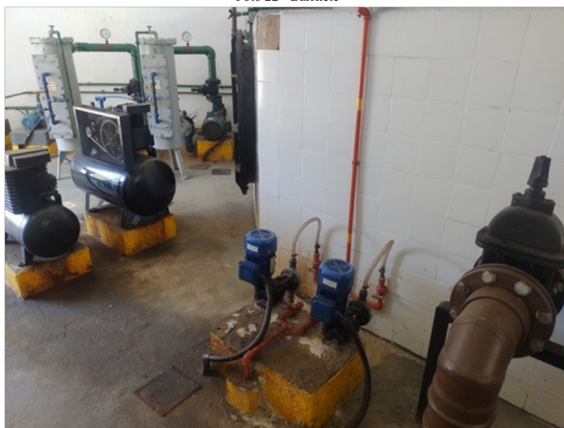
Foto 23 – Bombas injetoras de produtos químicos
