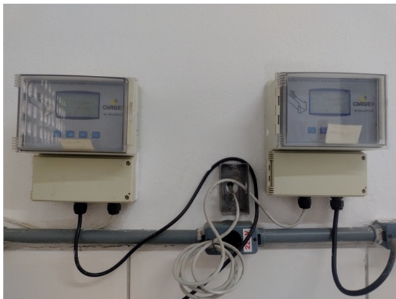
Foto 29 – Paineis medidores de vazão
