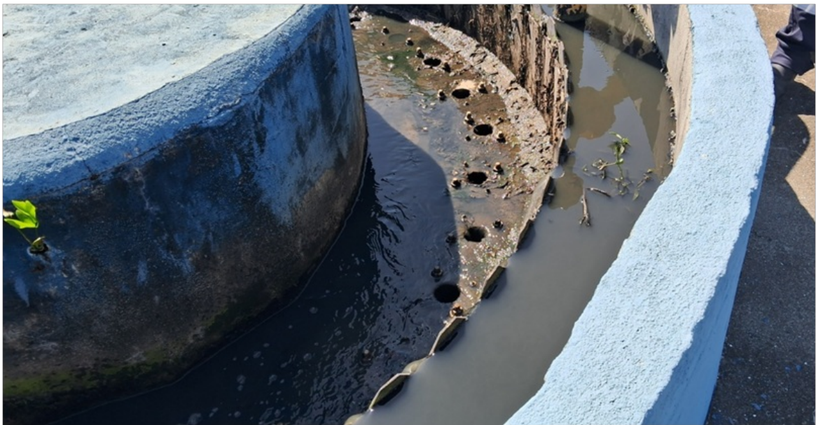
Foto 9 – Vertedor em evidência tubos de distribuição ascendente
