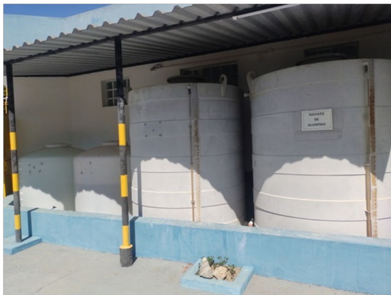
Foto 19 – Tanques produtos químicos
