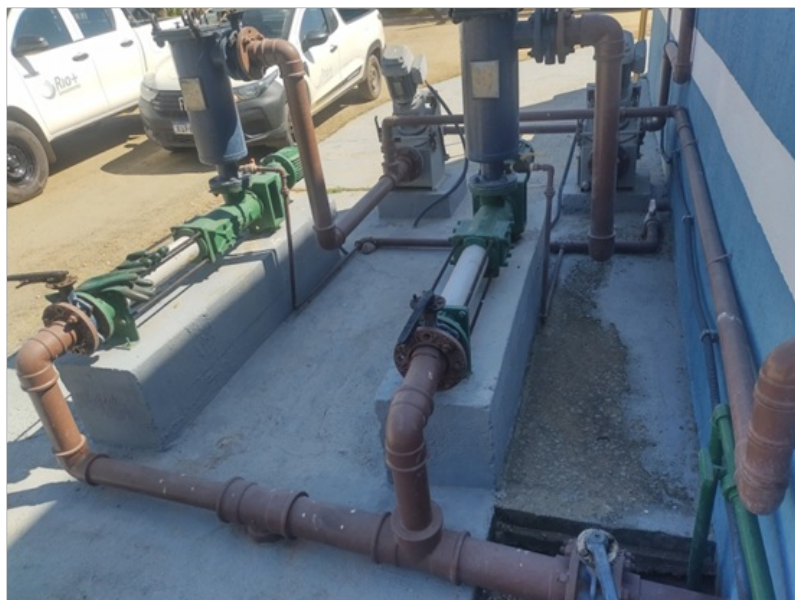
Foto 13 – Tubulações e bombas de recirculação de efluentes
