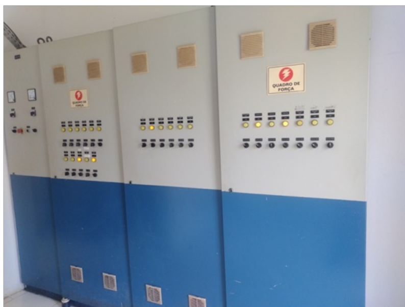
Foto 30 – Quadros de automação e elétrica
