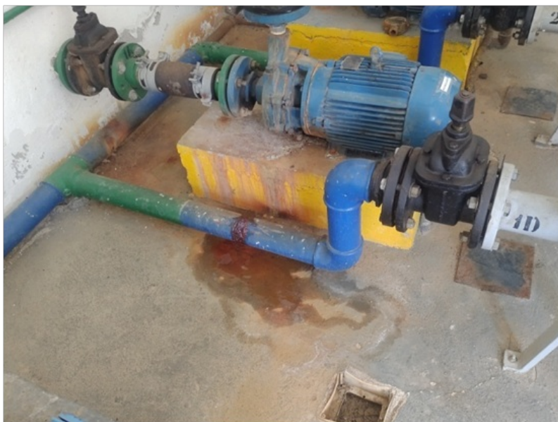
Foto 25 – Tubulação com vazamento
