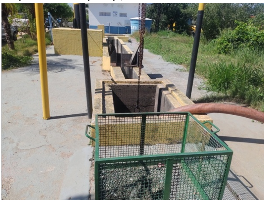
Foto 1 – Cesto coletor de detritos e caixa de chegada
