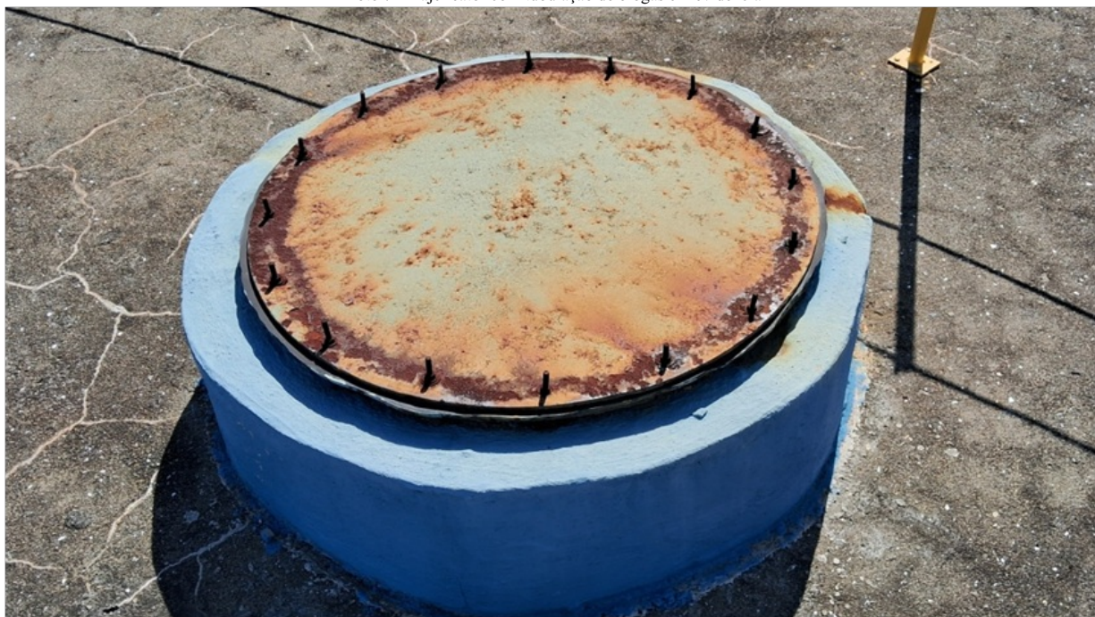
Foto 8 – Poço de inspeção separador trifásico
