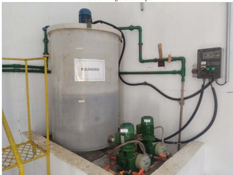
Foto 21 – Tanque polímero e bombas injetoras
