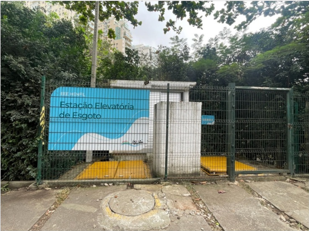
Foto 1 - Vista externa da estação, que estava devidamente identificada. À esquerda barrilete de recalque e à direita o poço de sucção.
