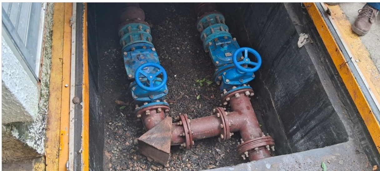
Foto 6 - Barrilete de recalque (DN 150) dotado de válvulas de bloqueio e retenção. Sem não conformidades..
