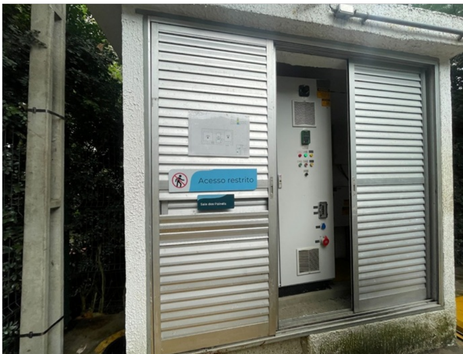
Foto 8 - Abrigo dos painéis elétricos. Sem não conformidades.
