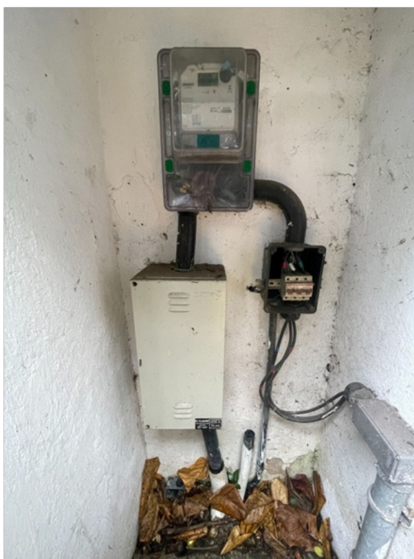
Foto 7 - Vista do interior do abrigo do medidor de energia. Verifica-se acúmulo de resíduos e ausência de tampa da caixa de disjuntores.
