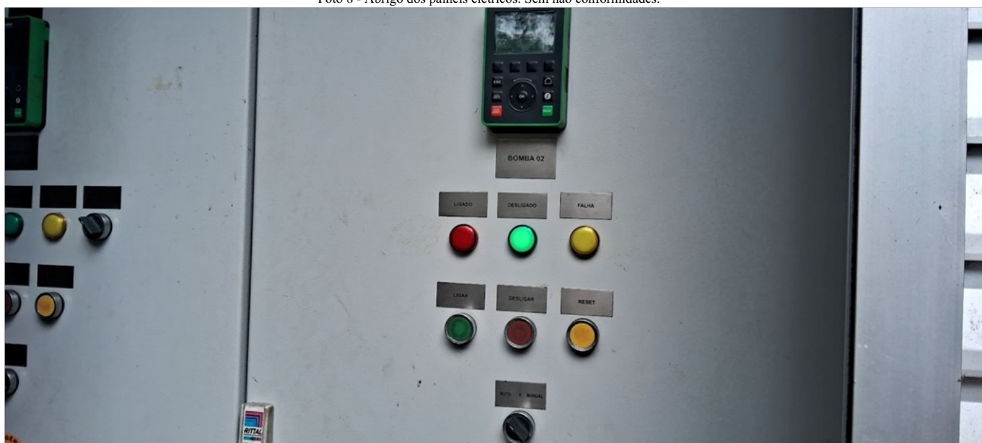
Foto 9 - Detalhe das botoeiras do painel elétrico da Bomba 02. Sem não conformidades.
