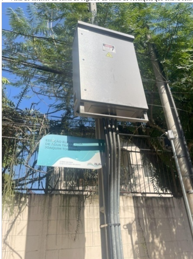
Foto 8 - Vista externa do painel elétrico de comando.
