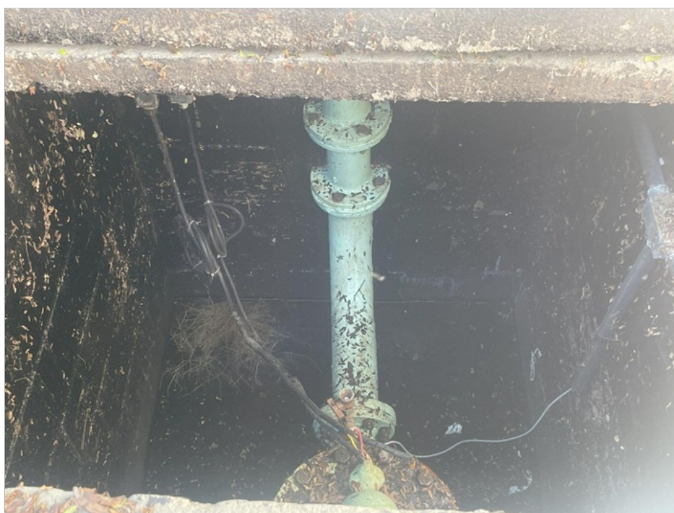
Foto 4 - Vista do barrilete de sucção.
