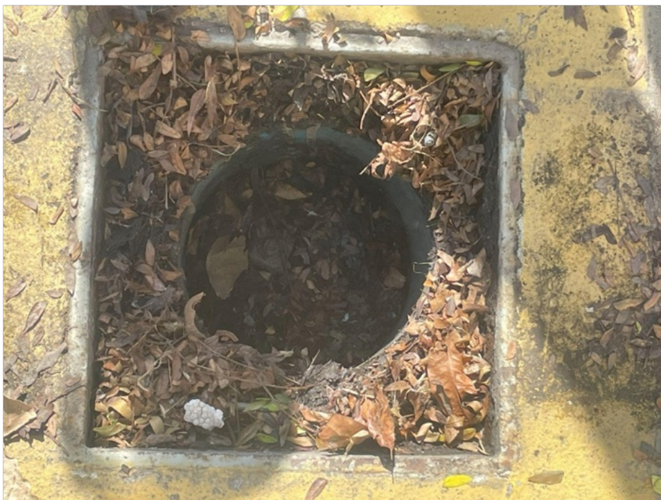
Foto 7 - Vista do interior da caixa do registro da linha de recalque, que estava sem tampa.
