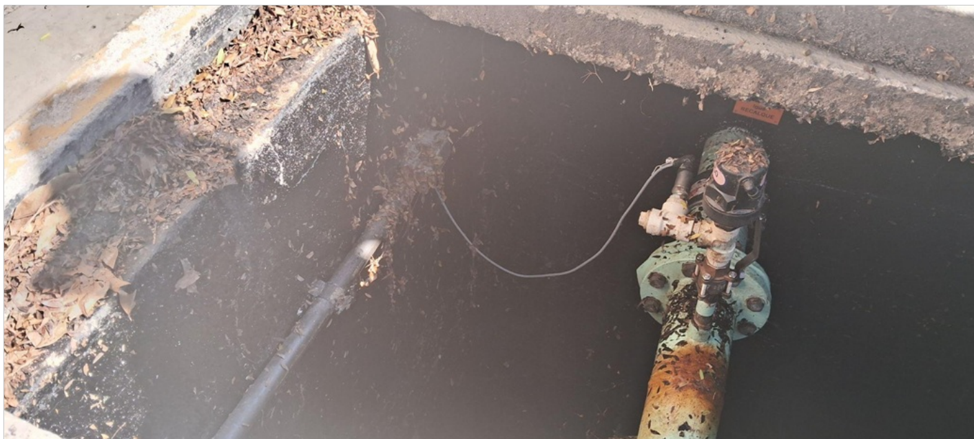
Foto 5 - Vista do barrilete de sucção, que possui dispositivo de medição eletrônica.
