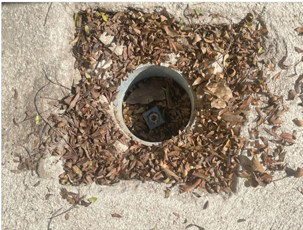
Foto 6 - Vista do interior da caixa do registro da linha de sucção, que estava sem tampa.
