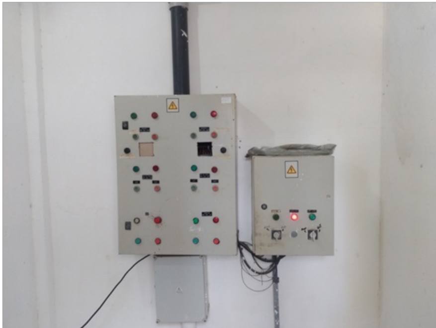
Foto 5 - Quadro de automação e elétrica
