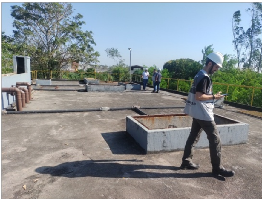
Foto 6 - Tanque de aeração
