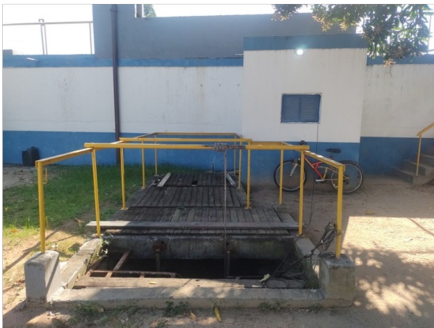
Foto 2 - Poço de sucção
