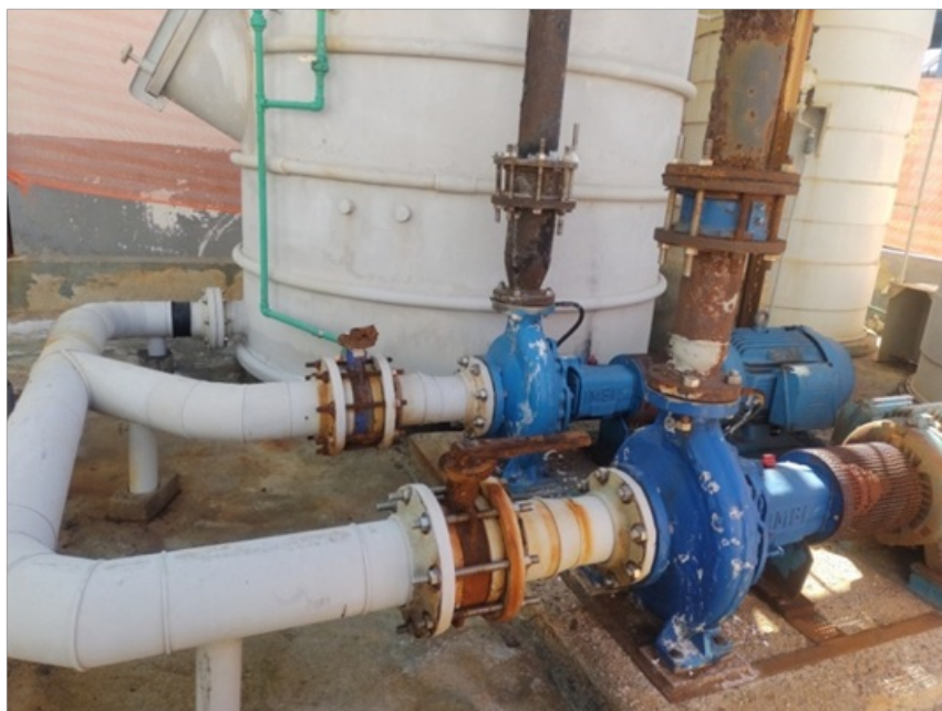
Foto 13 – Bombas do lavador de gases
