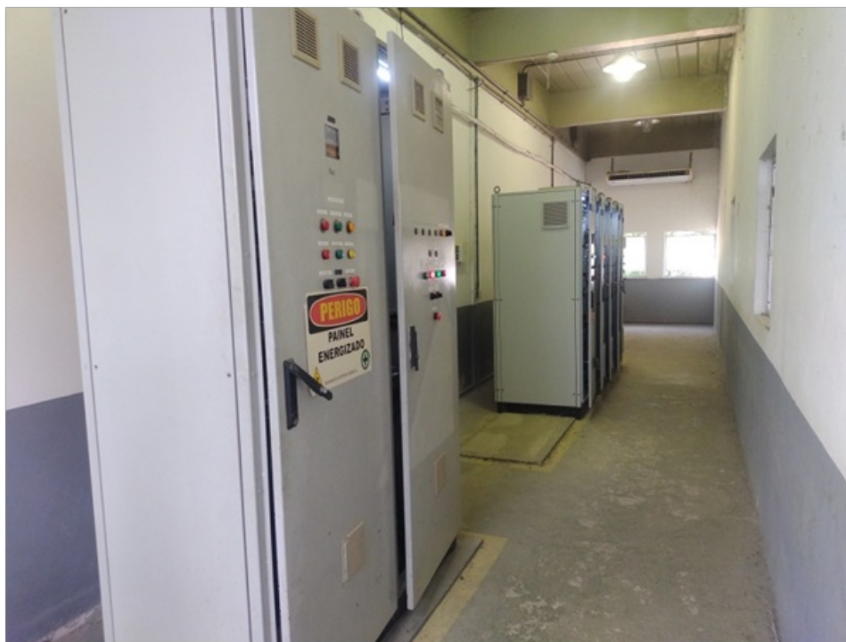
Foto 27 – Quadros de automação e elétrica da elevatória de esgoto tratado
