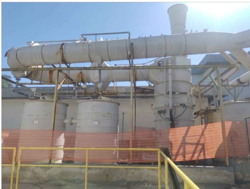
Foto 11 – Lavador de gases desativado
