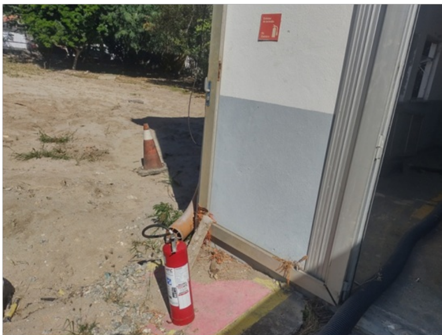
Foto 8 – Extintor mal instalado
