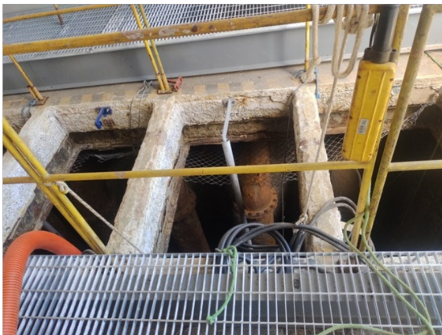
Foto 7 – Poço de sucção
