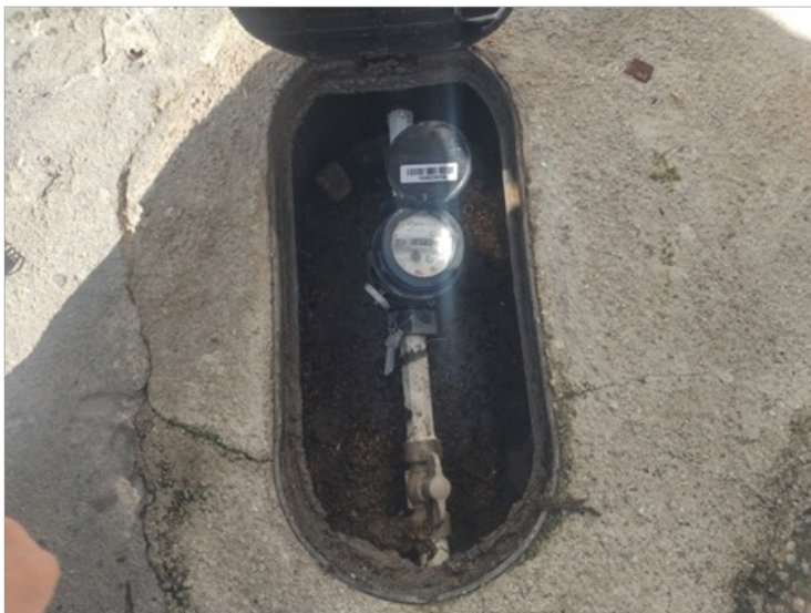
Foto 3 – Hidrômetro R. Aquidabã, 805 casa 57
