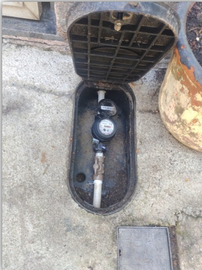
Foto 1 – Hidrômetro R. Aquidabã, 805 casa 36
