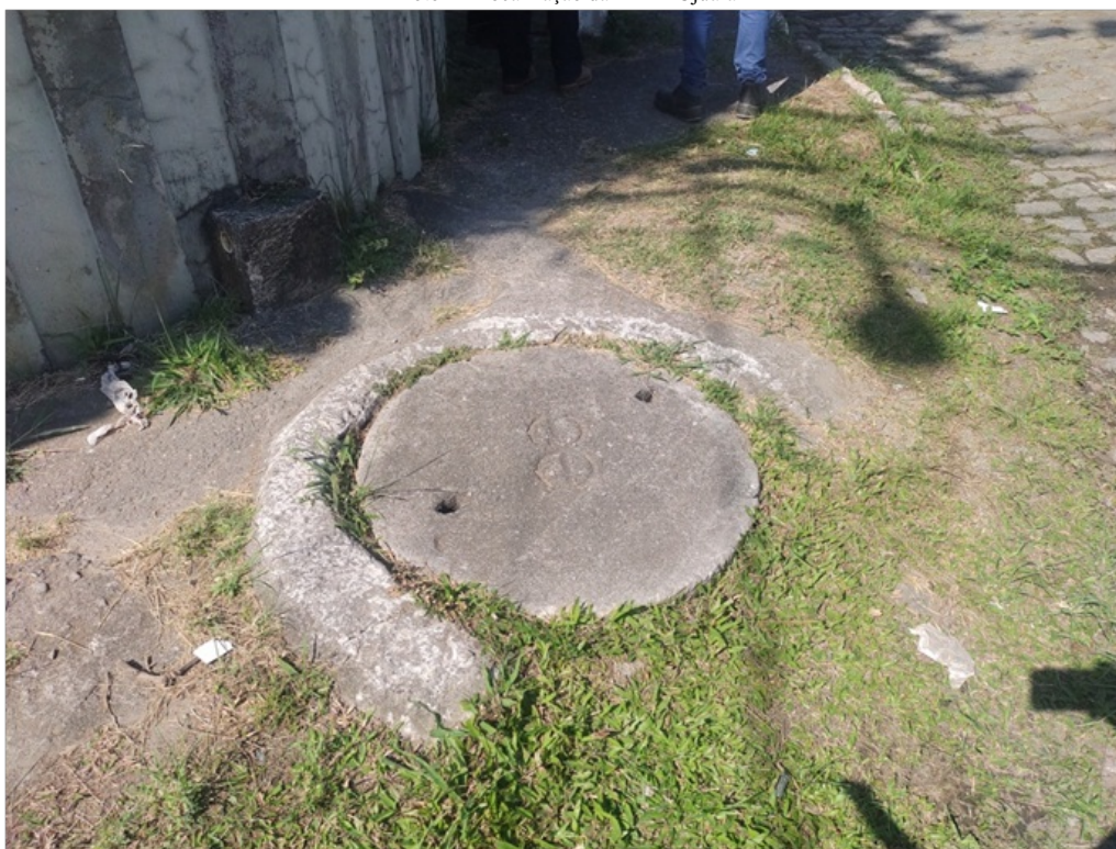
Foto 2 – Tampa abrigo do conjunto motobomba
