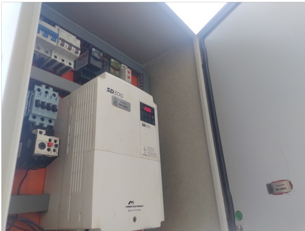
Foto 4 – Painel de automação e elétrica
