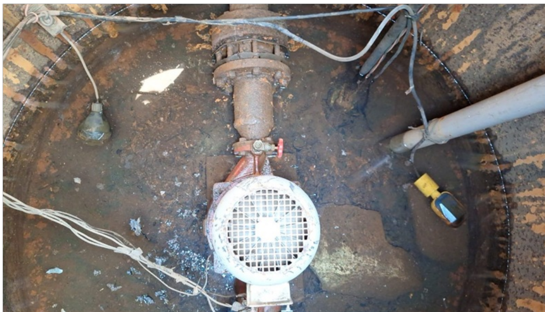
Foto 6 – Água no fundo do poço e fiação fora dos padrões normativos
