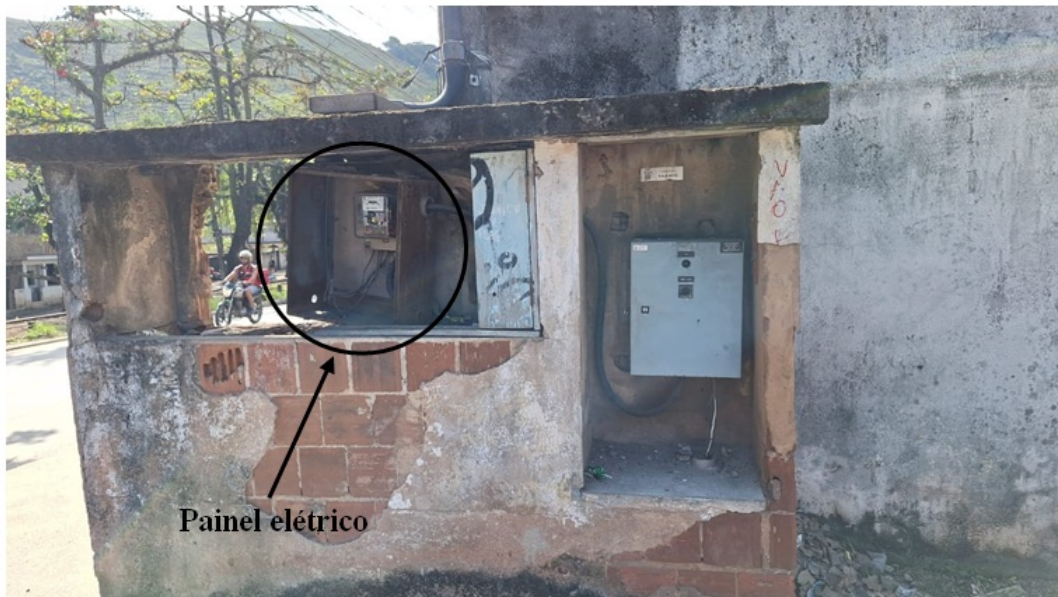
Foto 3 – Painel elétrico e abrigo de alvenaria sem manutenção
