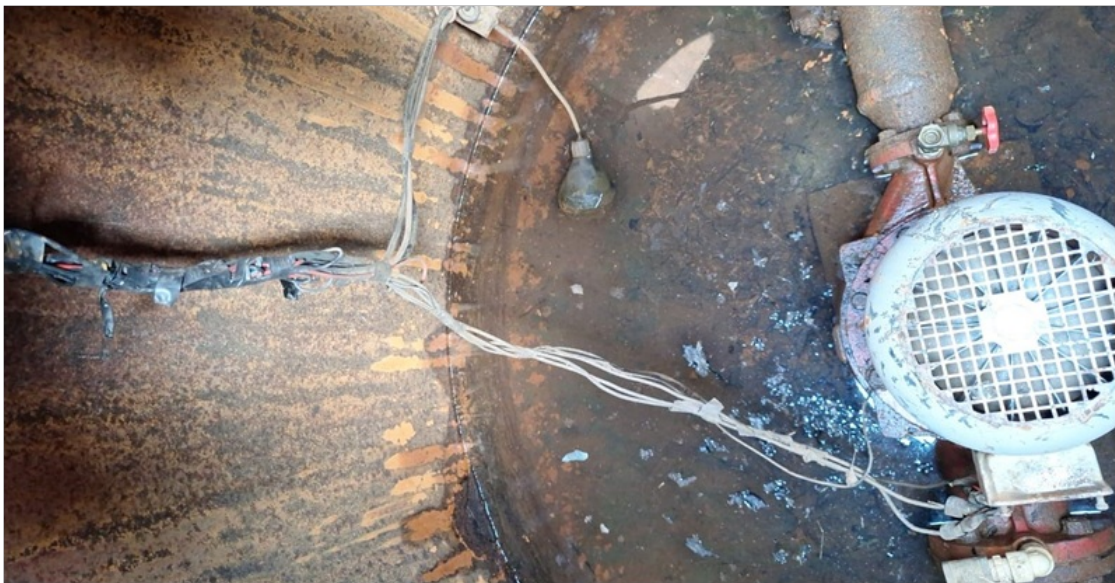
Foto 5 – Água no fundo do poço e fiação fora dos padrões normativos
