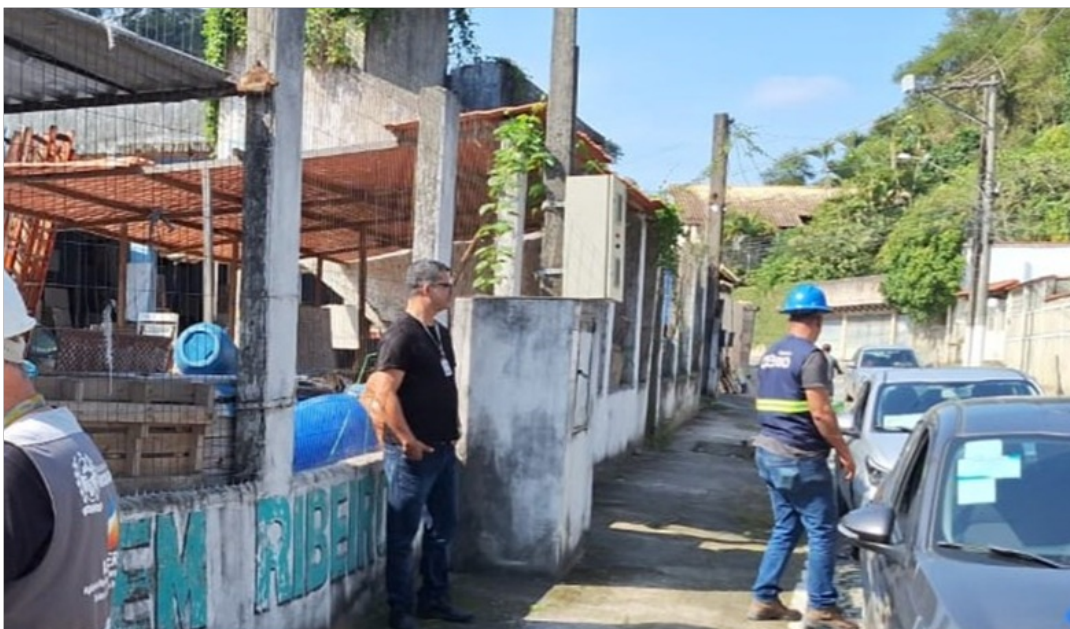
Foto 2 – Abrigo do painel da motobomba
