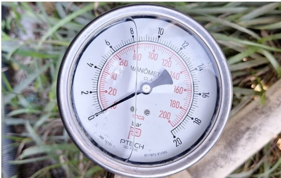
Foto 6 – Manômetro medindo pressão de retaguarda
