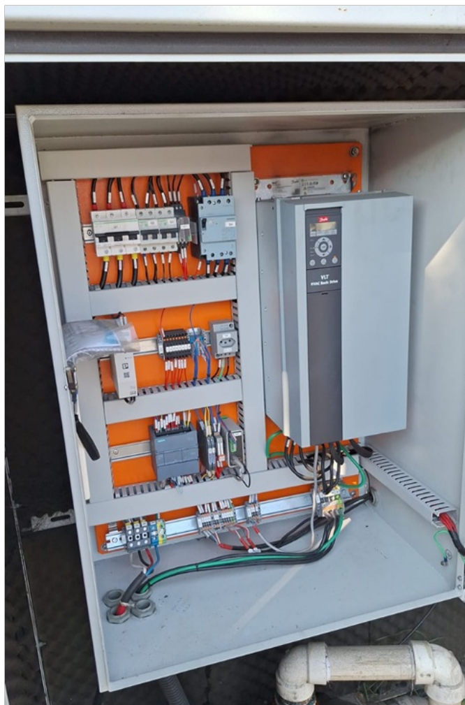
Foto 4 – Pannel da bomba, com inversor de frequência, sem sinalização de risco de choque elétrico
