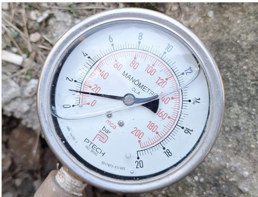
Foto 7 – Manômetro medindo pressão de recalque
