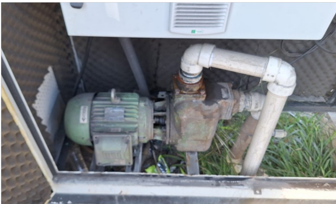
Foto 2 – Conjunto motobomba com tubulações de recalque e retaguarda DN 50 mm
