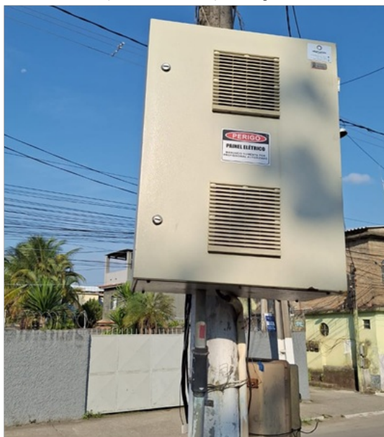
Foto 3 – Abrigo do painel de automação do conjunto motobomba
