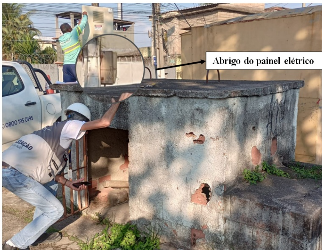
Foto 5 – Abrigo do painel elétrico, em detalhe, preso com fio
