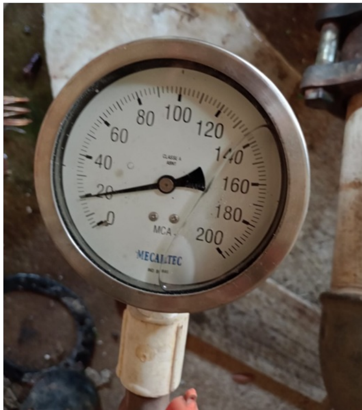
Foto 7 – Pressão manométrica de recalque
