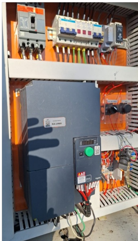
Foto 4 – Interior do abrigo do painel de automação
