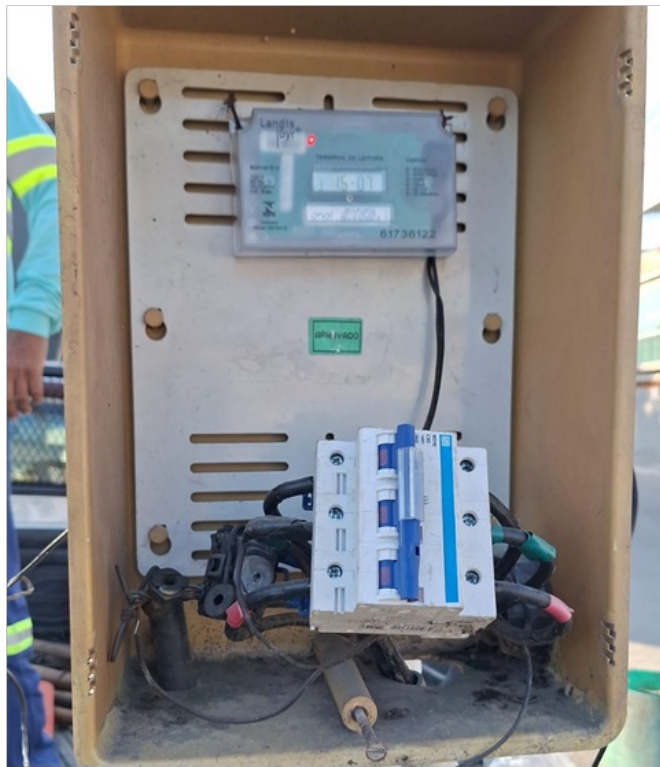
Foto 6 – Abrigo do painel elétrico preso com fio
