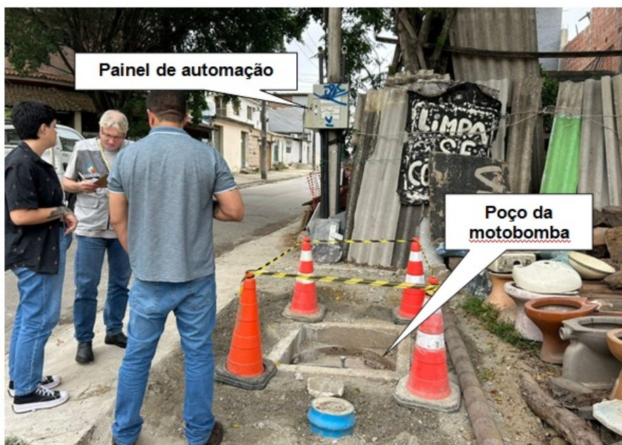
Foto 1 - Localização da EEAT Morro do Careca no passeio público
