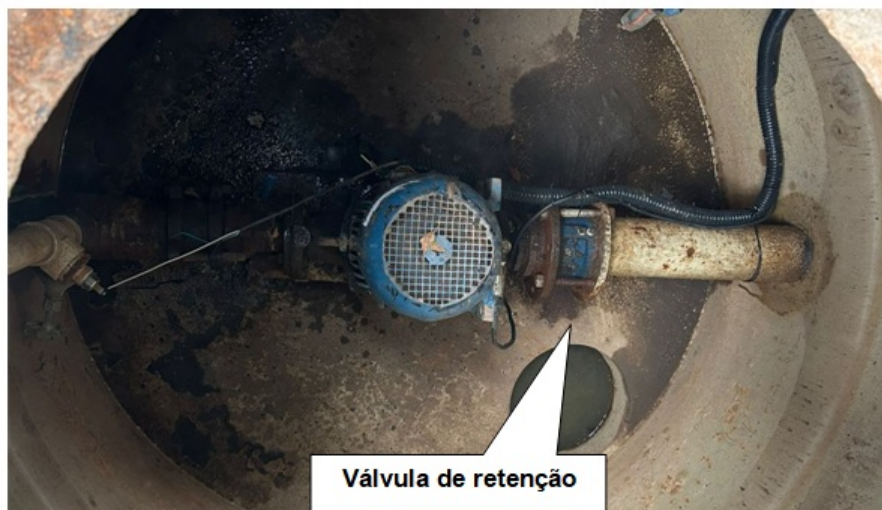
Foto 3 – Conjunto motobomba do tipo centrífuga in line .
