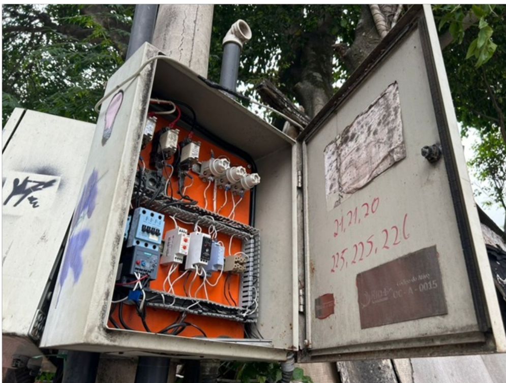
Foto 5 – Abrigo do painel de automação aberto sem sinalização de risco de choque elétrico.
