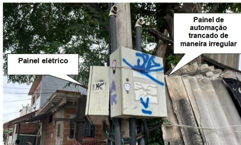
Foto 4 – Abrigo do painel de automação em mau estado de conservação, pichado e trancado de maneira irregular
