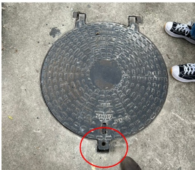
Foto 2 – Tampa de ferro do abrigo do poço da motobomba sem trava
