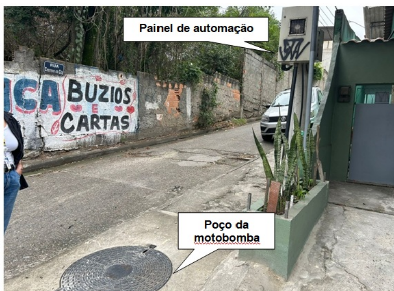
Foto 1 - Localização da EEAT Caminho do Céu na calçada de via pública
