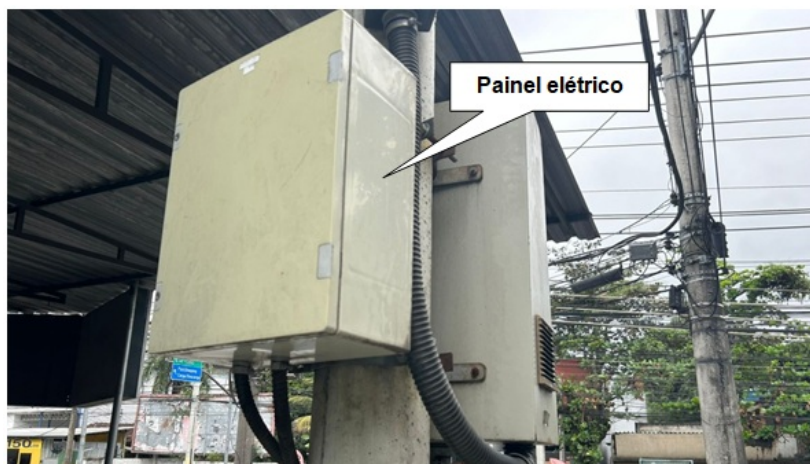
Foto 6 – Abrigo do painel elétrico que não foi vistoriado
