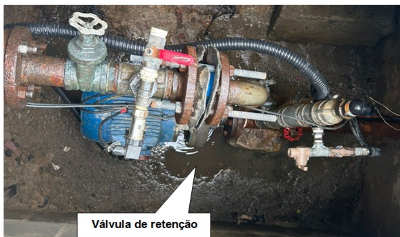
Foto 3 – Conjunto motobomba do tipo centrífuga com sinais de vazamento
