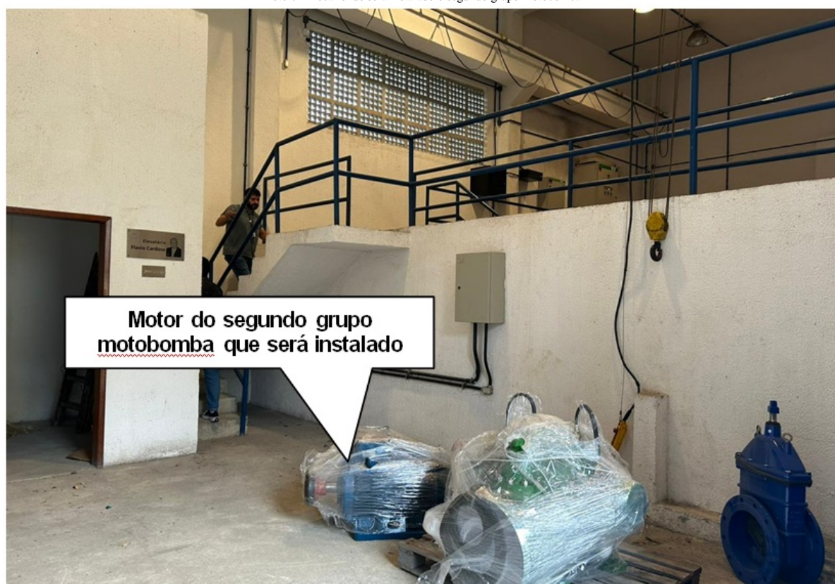
Foto 7 – Motor da bomba do segundo grupo que será instalado
