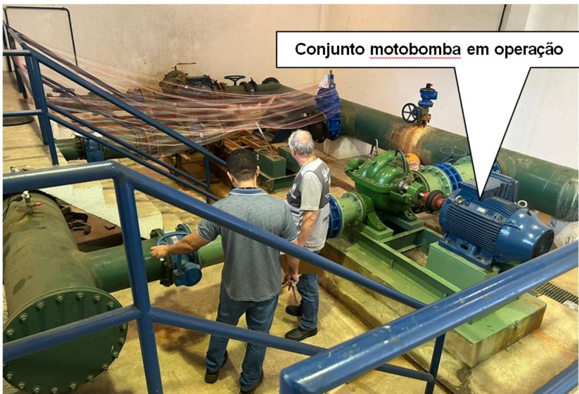
Foto 3 – Conjuntos Motobombas presentes na EEAT
