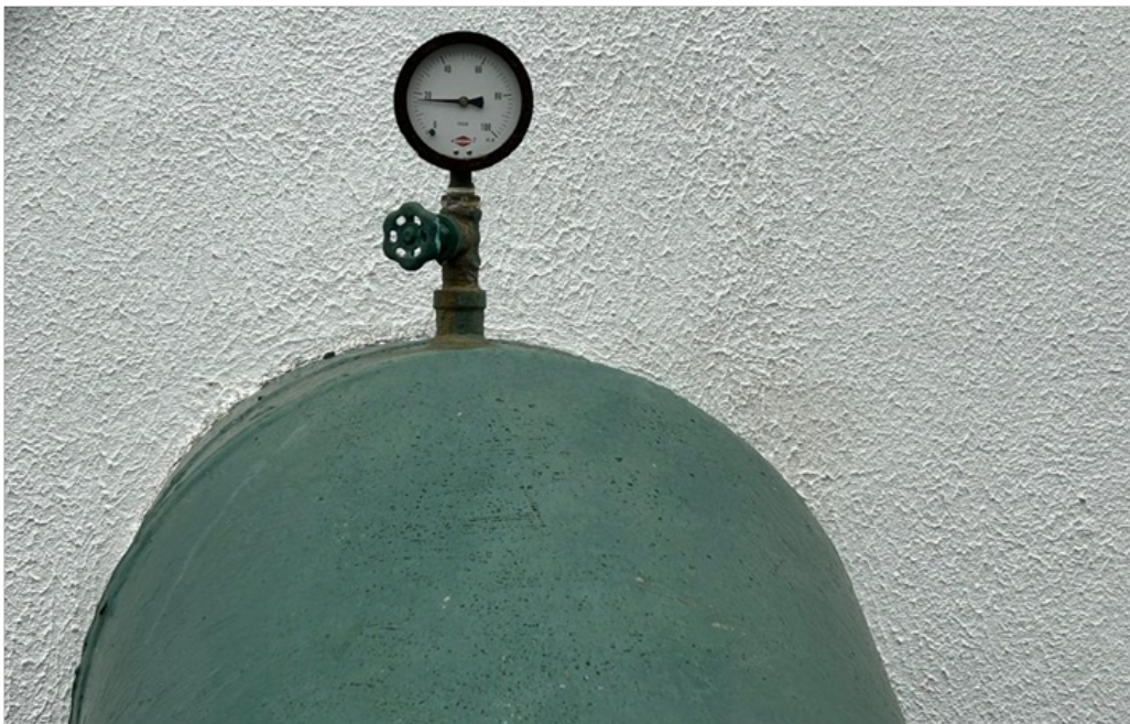
Foto 4 – Manômetro instalado na tubulação medindo a pressão de retaguarda
