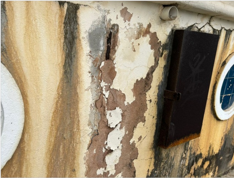
Foto 15 – Ferragem aparente na parte externa
