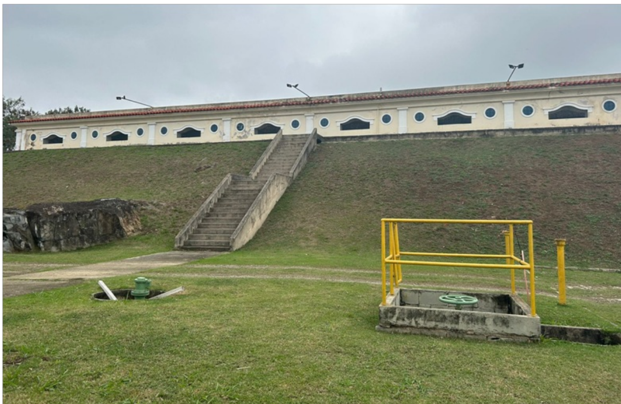
Foto 21 - Local onde está instalada a válvula sem guarda corpo
