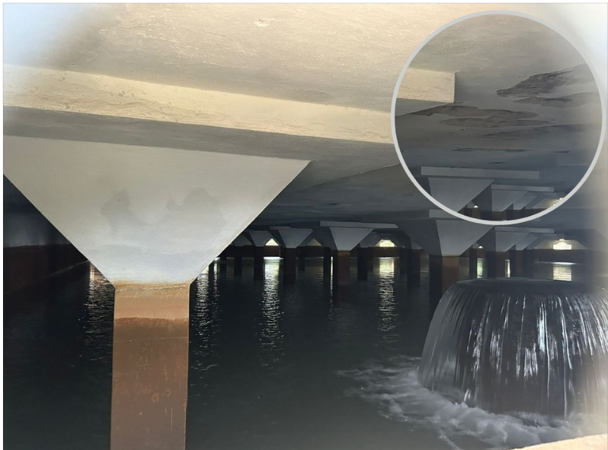
Foto 16 - Ferragem aparente na parte interna
