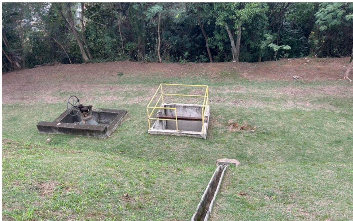
Foto 20 – Local onde está instalada a válvula sem guarda corpo
