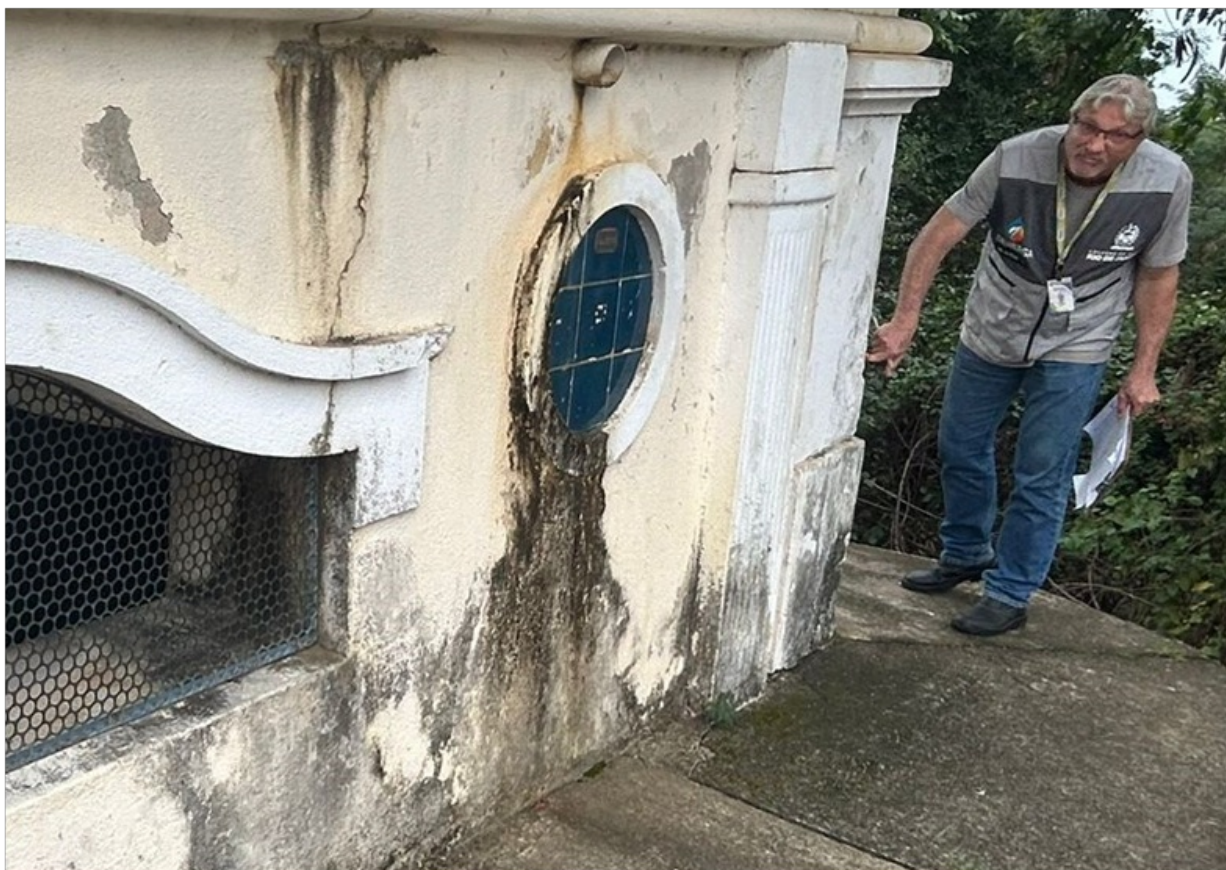
Foto 13 - Emboço e pintura desgastados
