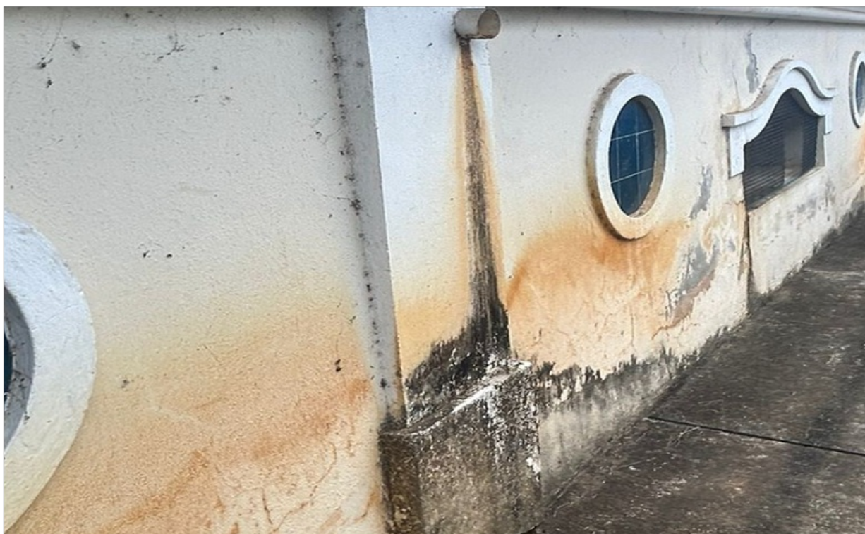
Foto 12 – Emboço e pintura desgastados
