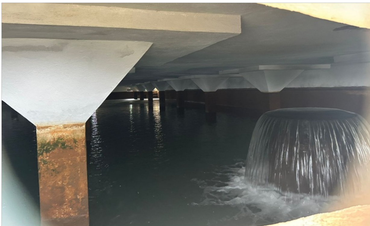
Foto 6 - Entrada de água pela célula II
