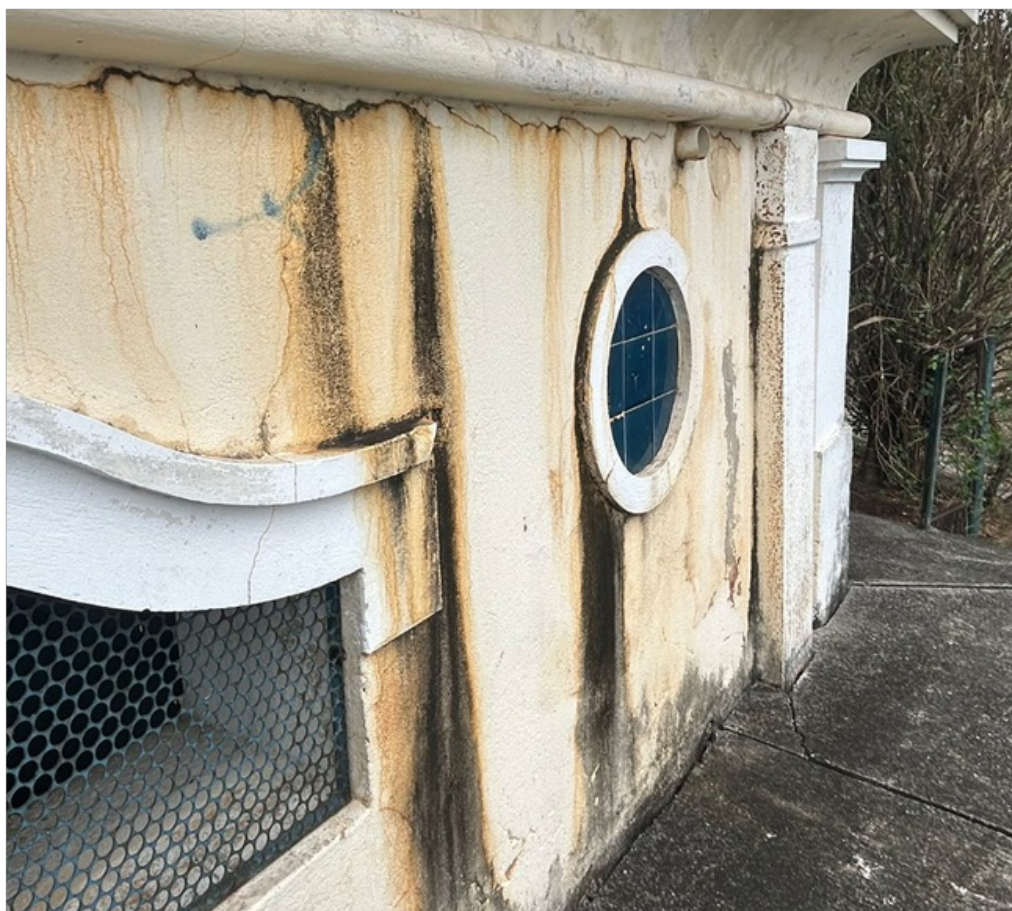
Foto 14 - Emboço e pintura desgastados
