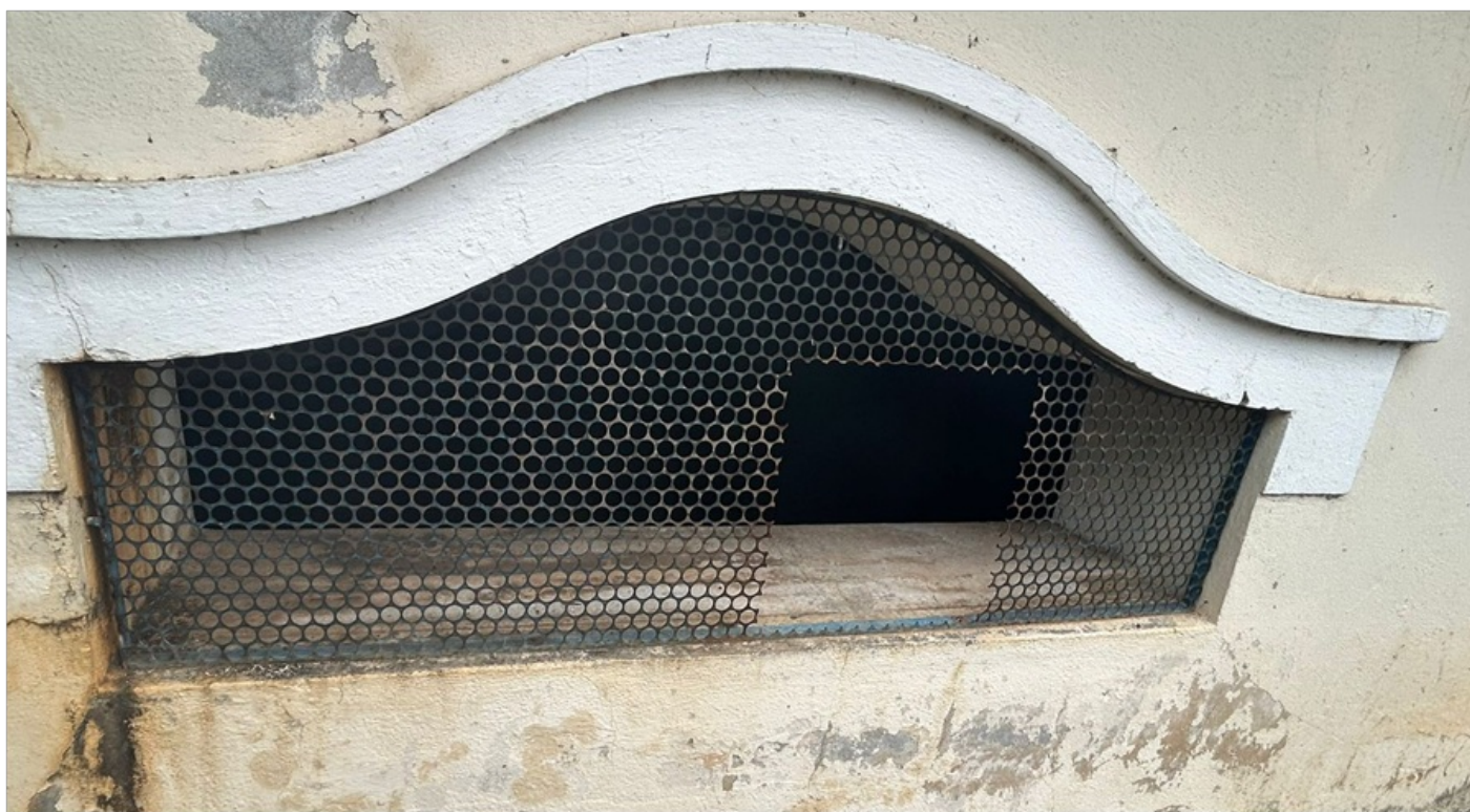
Foto 17 – Visita com grande orifio aberto
