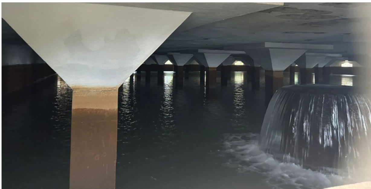
Foto 5 – Entrada de água pela célula I
