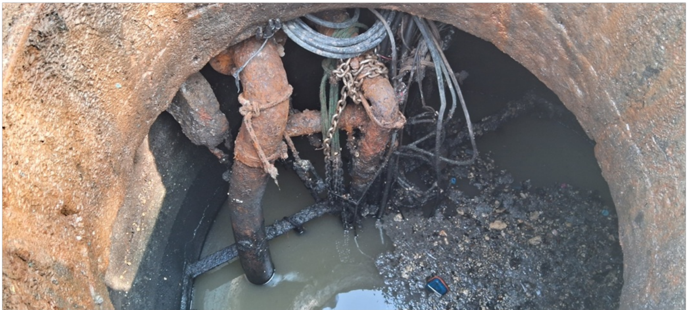
Foto 4 – Vista da Tubulação e Poço da EEE , porém sem visão da bomba submersível.
