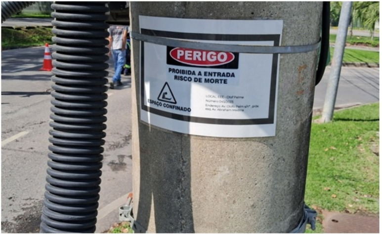
Foto 2 e 3 – Quadro de Comando e sinalização
