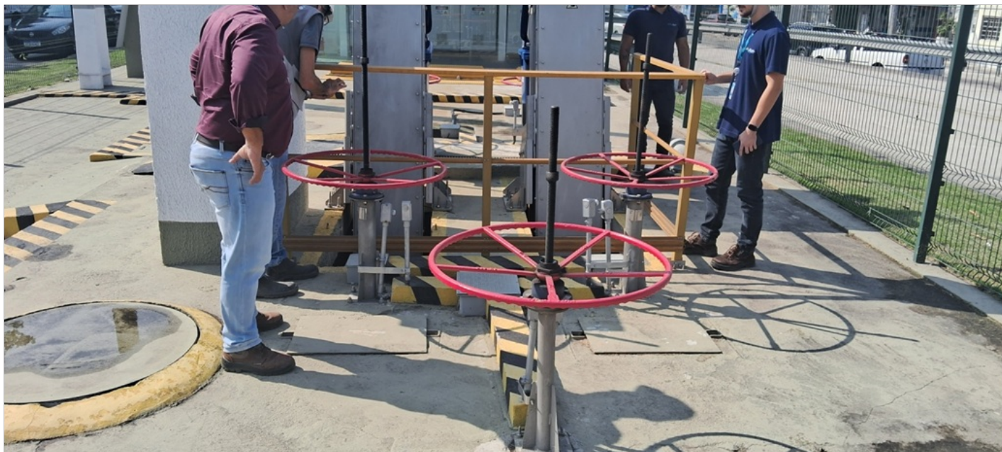
Foto 2 - Vista do equipamento automático de gradeamento e volantes de controle dos registros.
