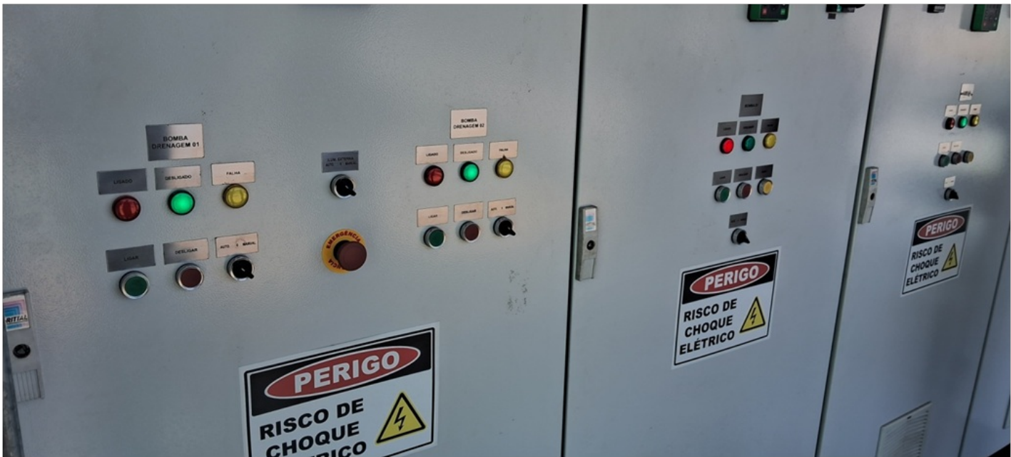
Foto 5 – Painéis elétrico que ficam em sala climatizada.
