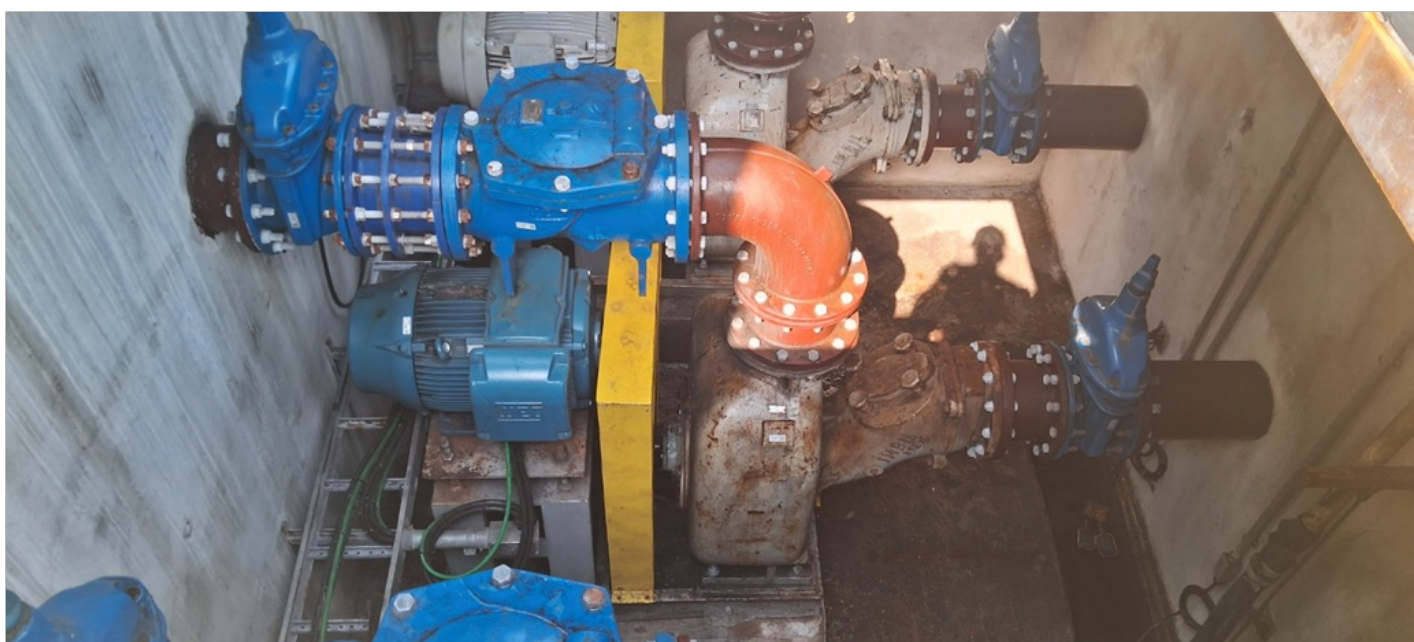
Foto 5 - Vista dos conjuntos moto-bombas e barriletes dotados de registro e válvula de retenção.
