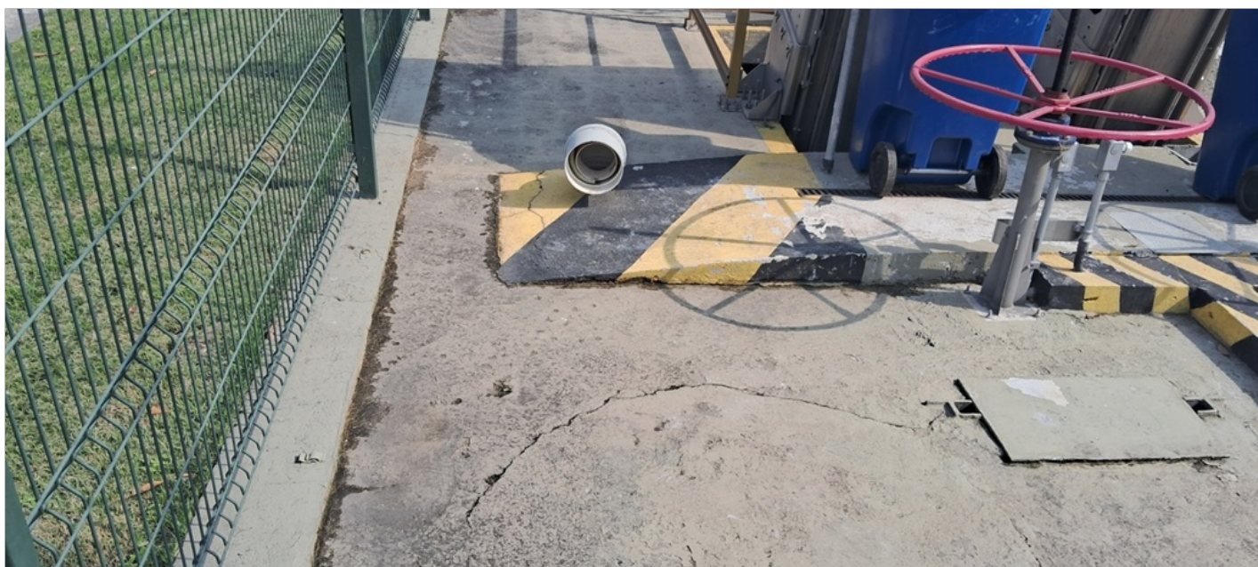
Foto 4 – Detalhe de tubo do sistema de exaustão.
