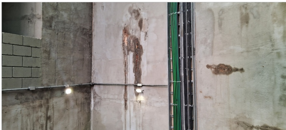
Foto 16 – Marcas de infiltração na parede da casa de bombas.
