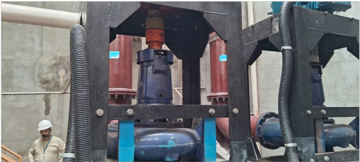
Foto 11 – Vista do conjunto moto-bomba da linha 4.
