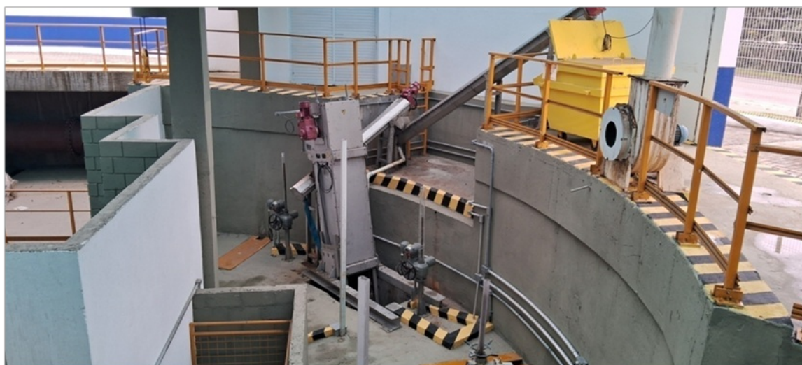
Foto 6 - Vista da área de gradeamento. O equipamento foi recentemente instalado e está em fase de testes.
