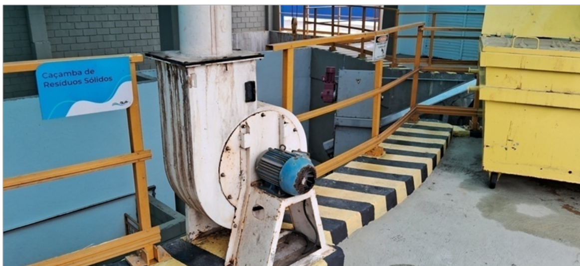
Foto 9 – Equipamento do sistema de exaustão necessitando limpeza.
