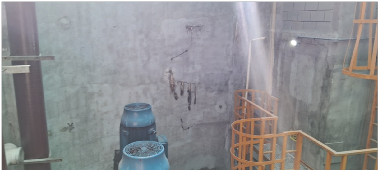
Foto 17 – Marcas de infiltração em parede da casa de bombas.
