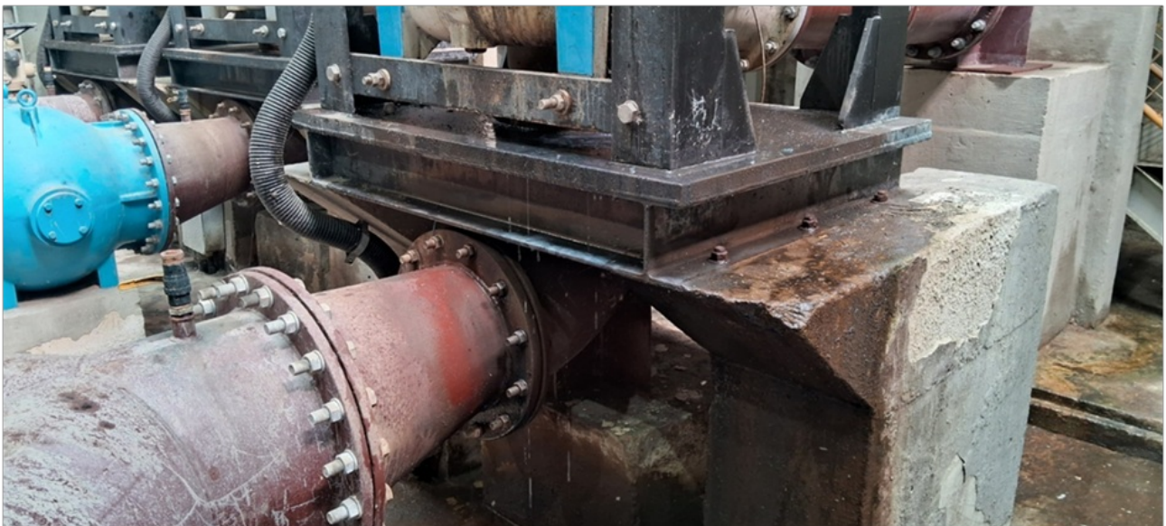
Foto 13 - Detalhe do conjunto moto-bomba que apresentava vazamento de esgoto.
