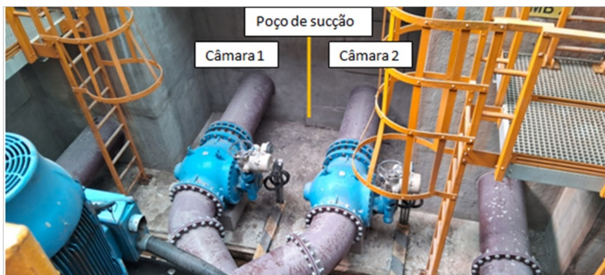
Foto 10 - Vista da tubulação de sucção, parede do poço de sucção está ao fundo. O poço é subdividido em duas câmaras.
