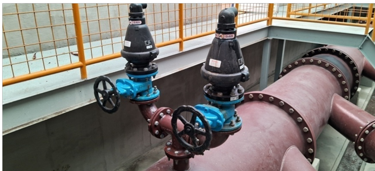
Foto 15 – Ventosas instaladas no barrilete de recalque de esgoto.
