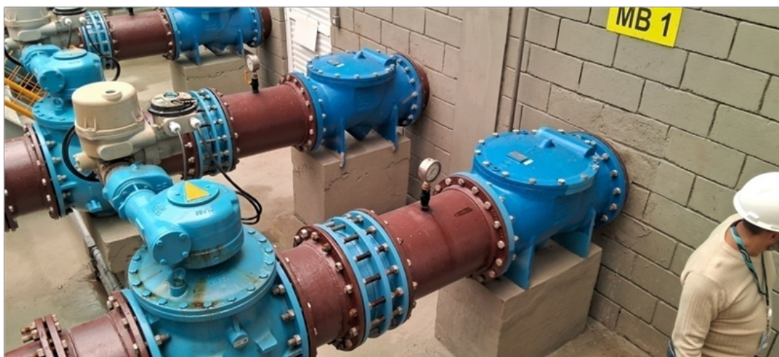
Foto 14 - Vista do barrilete de recalque de esgoto, que possui válvulas com atuadores elétricos, válvula de retenção e medidores de pressão.
