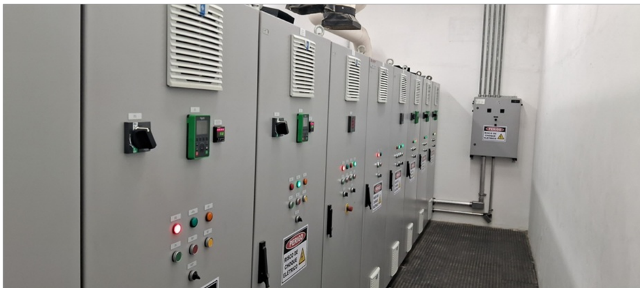
Foto 2 - Painéis elétricos de comando e controle das moto-bombas, com 440 V. Acionamento de forma manual e automática através de sensor de nível. Sala refrigerada e dotada de equipamentos e sinalização de segurança.
