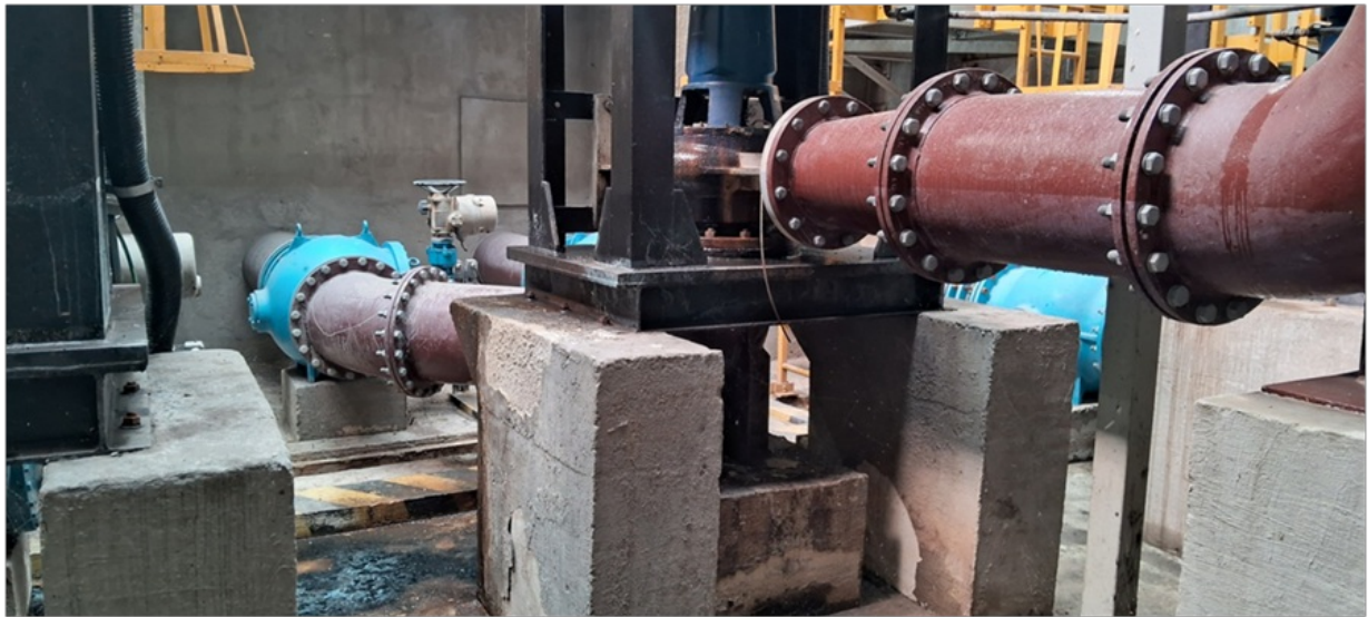
Foto 12 - Vista do conjunto moto-bomba que apresentava vazamento.
