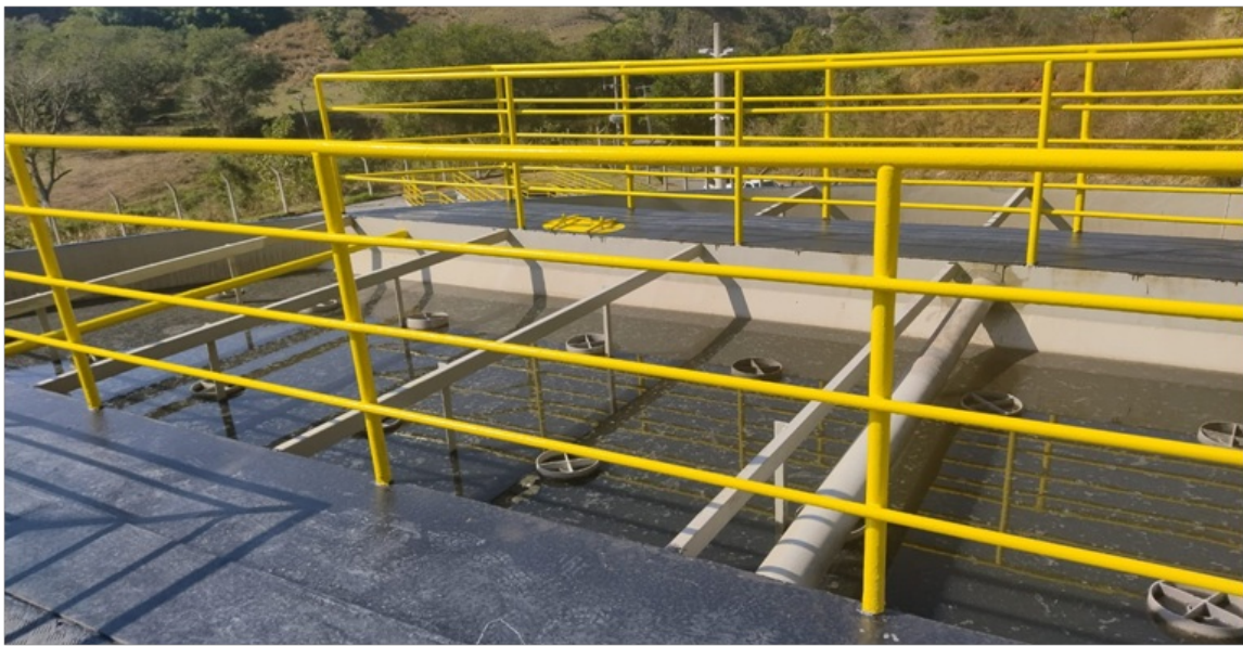
Foto 08 – Vista superior do reator UASB.
