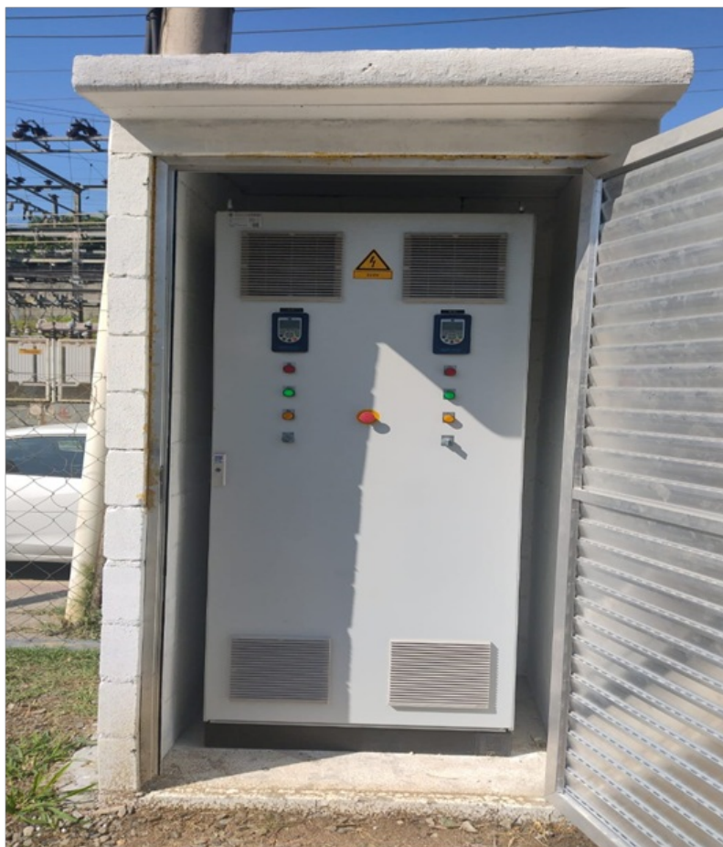
Foto 23 – Pannel elétrico da EEE.
