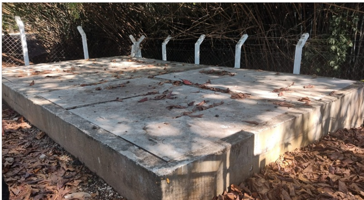
Foto 30 – Área ao redor da estação elevatória necessitando de limpeza.
