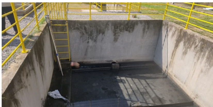
Foto 05 – Caixa de gordura ETE.
