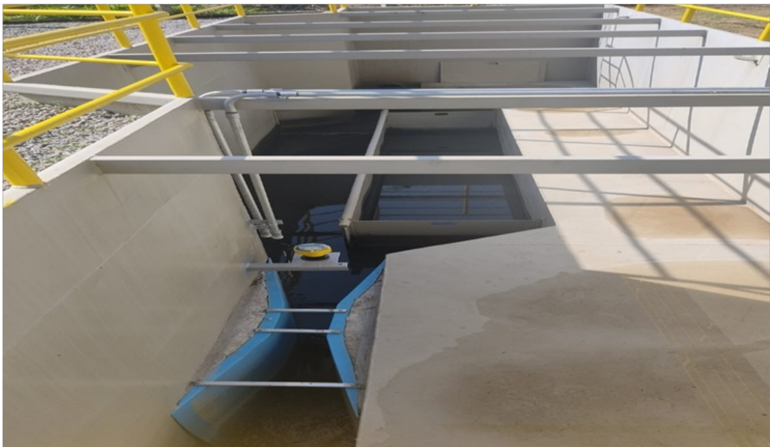
Foto 03 – Medidor de vazão.
