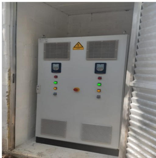
Foto 29 - Pannel elétrico da EEE.
