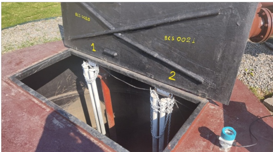
Foto 06 – Elevatória da ETE que transporta parte do efluente para o reator UASB.
