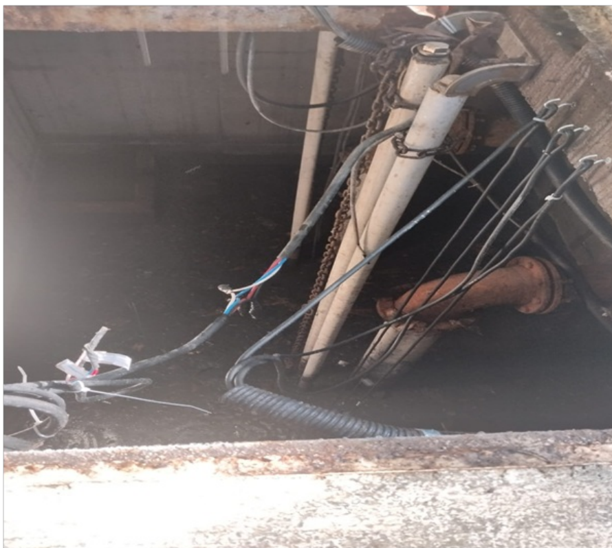
Foto 30 - Poço de sucção onde está instalado o conjunto motobomba
