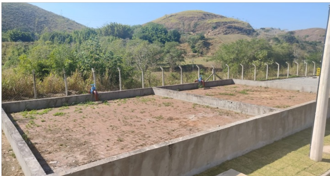
Foto 21 – Leitos de Secagem.
