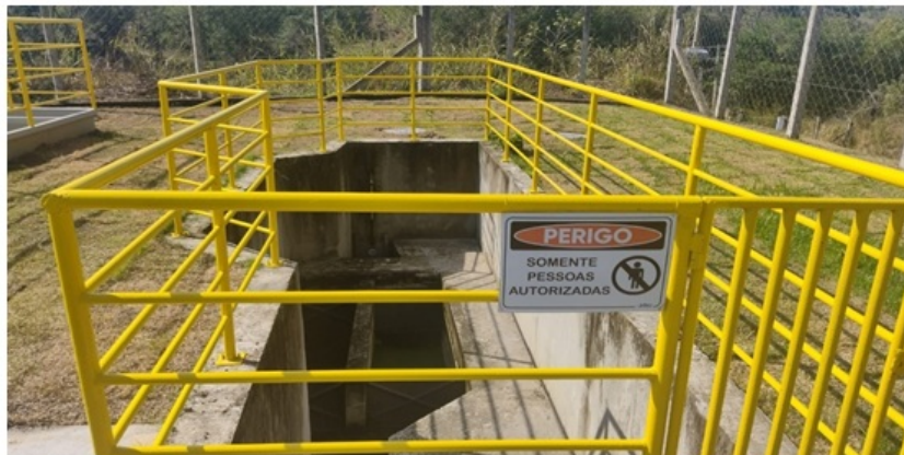
Foto 04 – Grade de barras + desarenador não sendo utilizado.
