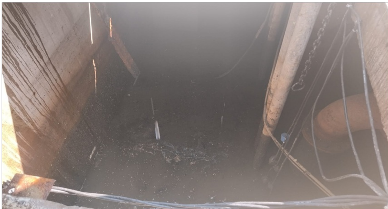
Foto 25 - Poço de sucção onde está instalado o conjunto motobomba
