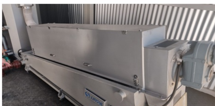
Foto 19 - Centrifugas para Desidratação do Lodo.
