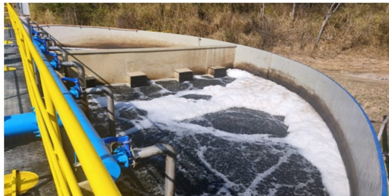
Foto 10 - Sistema de aeração da ETE.
