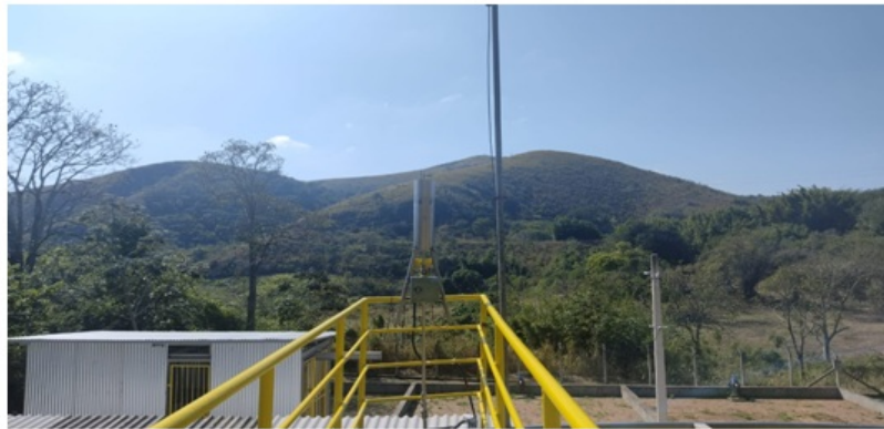
Foto 09 – Queimador de gases da ETE.
