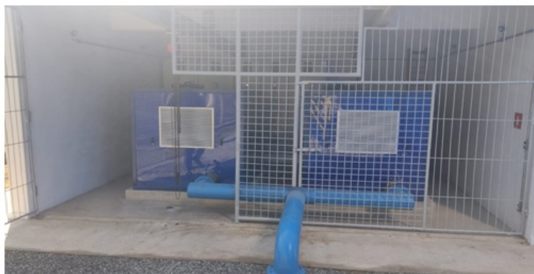
Foto 13 – Sopradores da estação de tratamento de esgoto.
