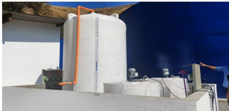
Foto 12 – Tanque de armazenamento de coagulantes.
