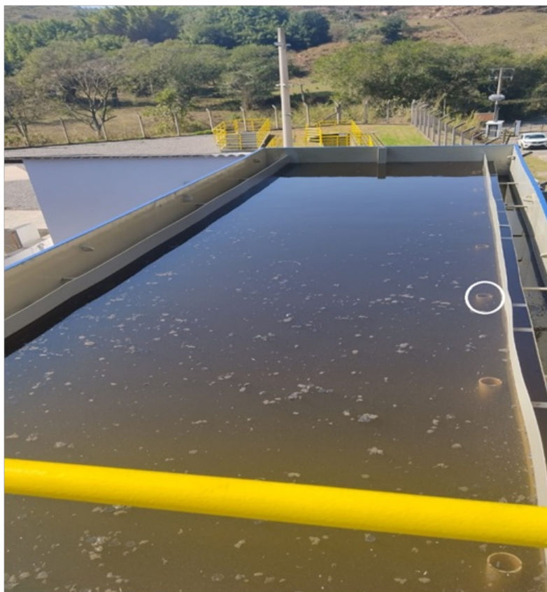
Foto 15 – Decantador Secundário evidenciando tubulação para remoção de excesso material em suspensão.
