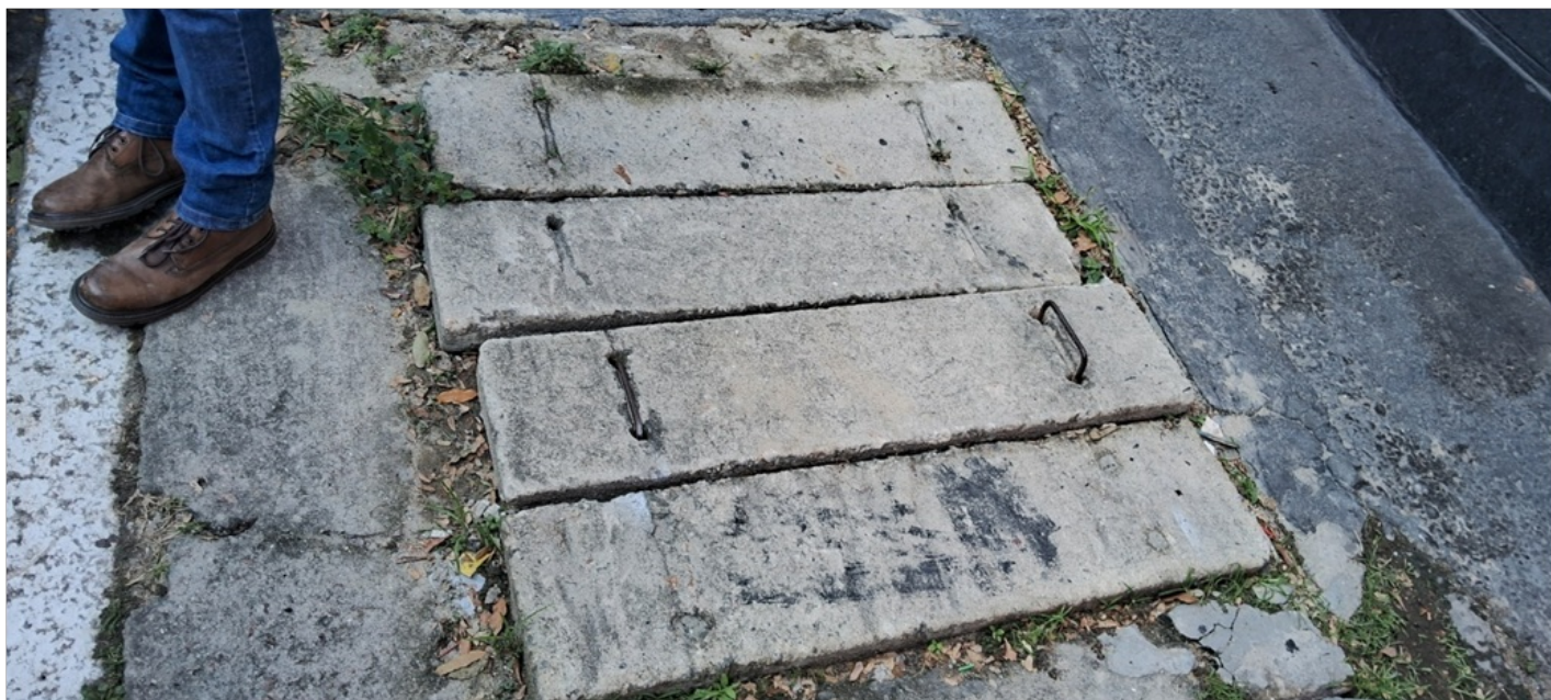
Foto 2 – Tampão múltiplo de concreto do poço da bomba. Verifica-se ausência de hastes de aberturas.
