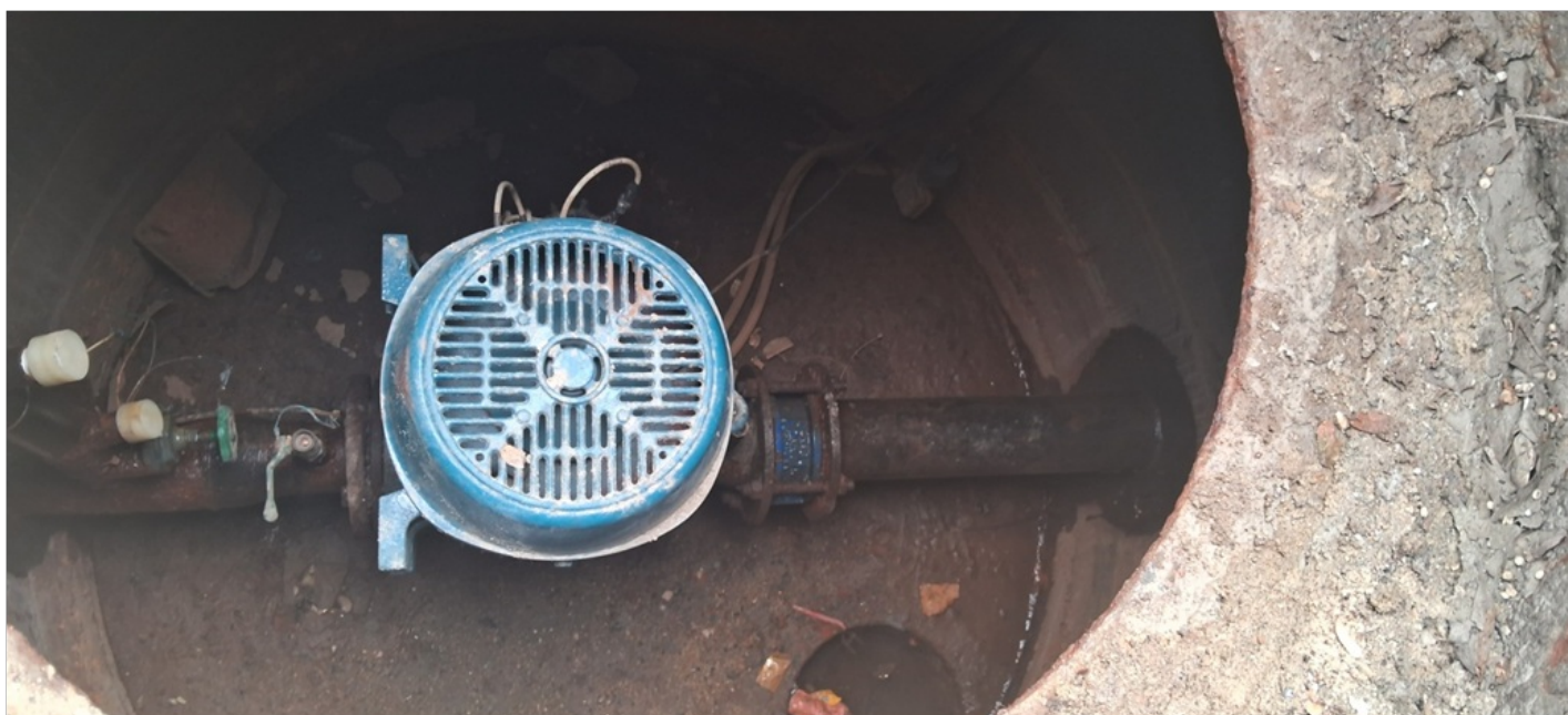
Foto 3 – Visto do interior do poço da bomba. Verifica-se presença da torre de eletrodo (a esquerda) e válvula de retenção (a direita).
