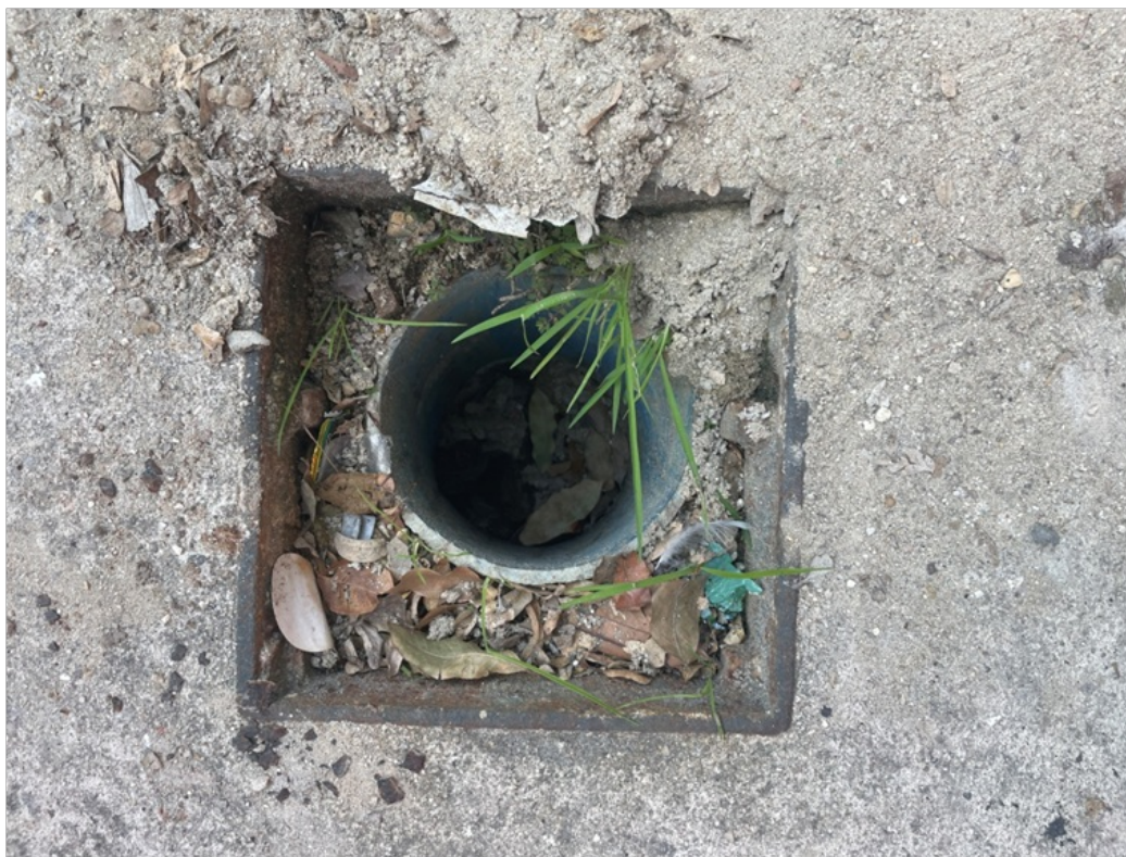
Foto 4 – Registro de retaguarda. Verifica-se ausência de tampa e sujidades.
