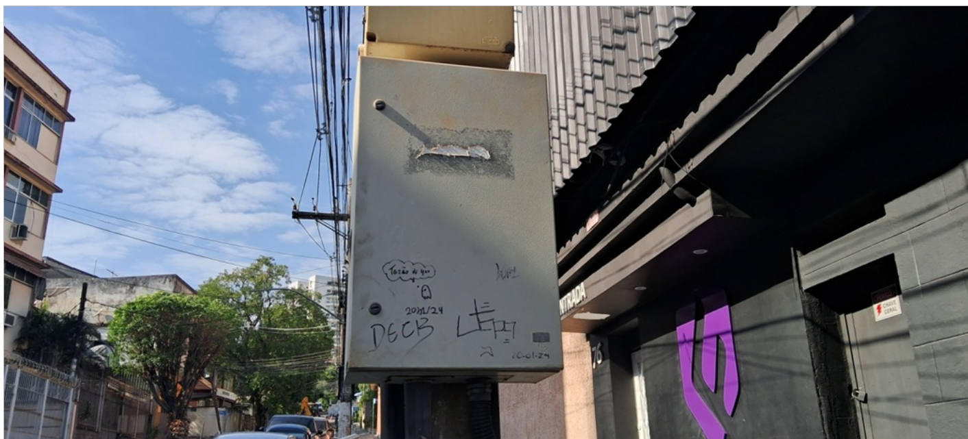
Foto 5 – Quadro elétrico de comando. Verifica-se ausência de identificação. Não foi permitida a visualização do interior.
