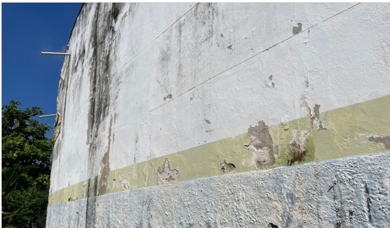
Foto 9- Desgaste na pintura do reservatório
