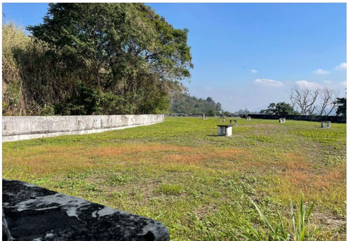
Foto 17 - Dutos sem proteção lateral
