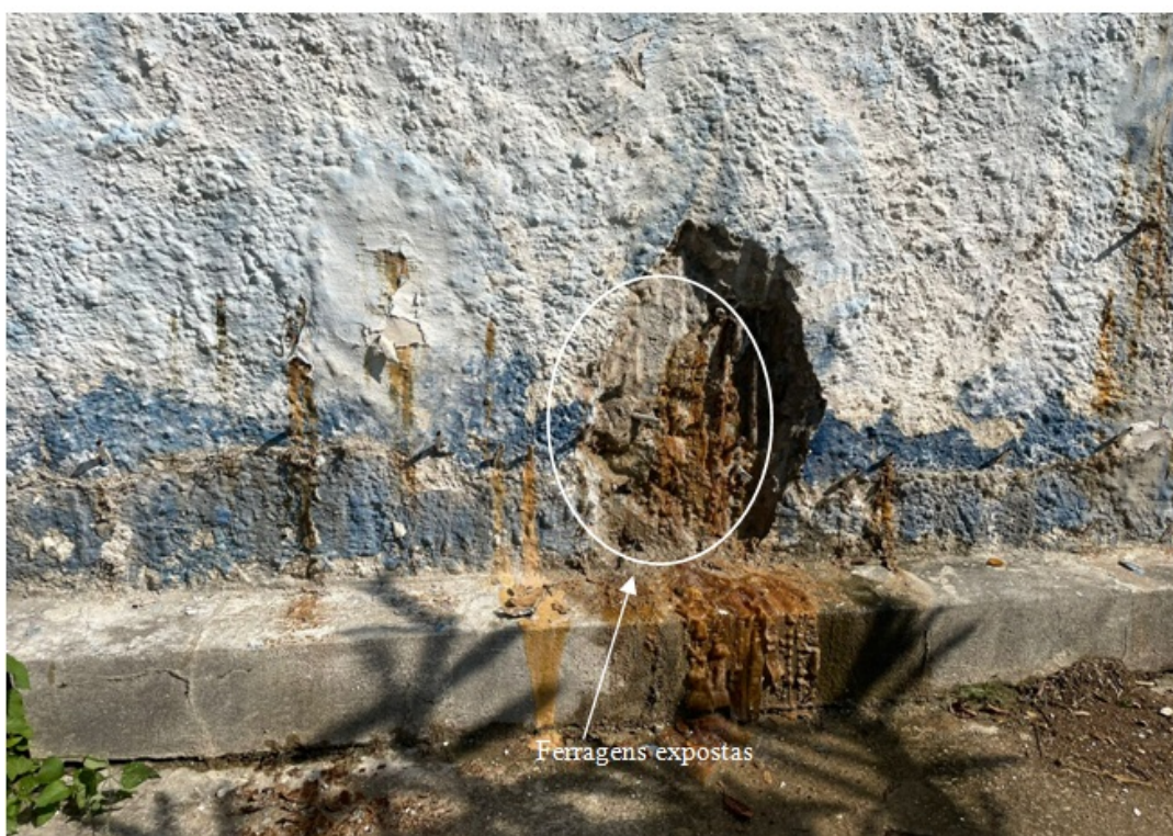
Foto 15 - Ferragens expostas na base do reservatório
