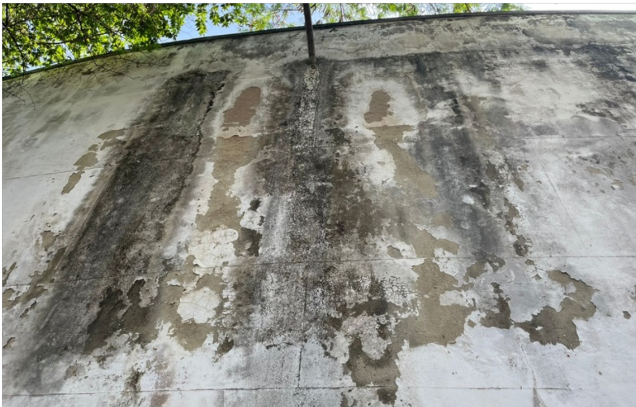
Foto 8 – Desgaste na pintura do reservatório
