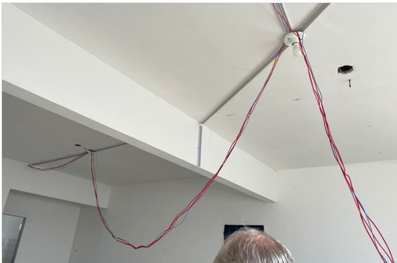
Foto 13 – Fiação disposta de maneira irregular
