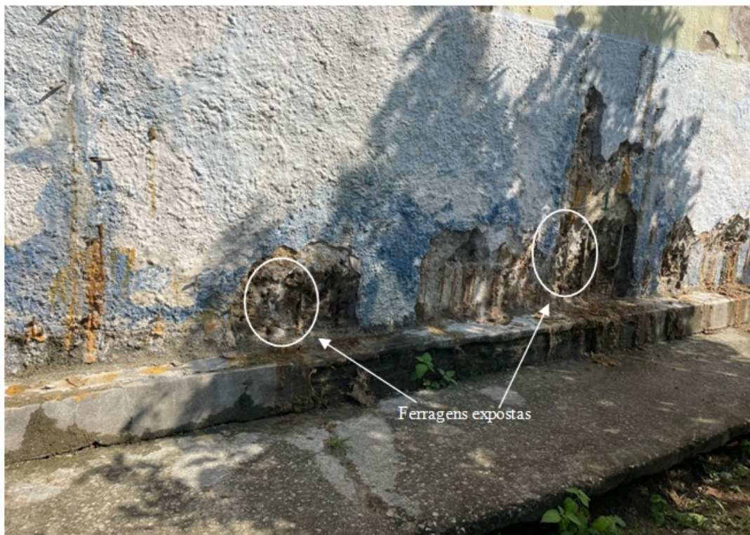
Foto 14 – Ferragens expostas na base do reservatório
