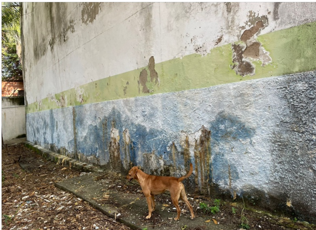
Foto 10 – Localização dos vazamentos externos constatados
