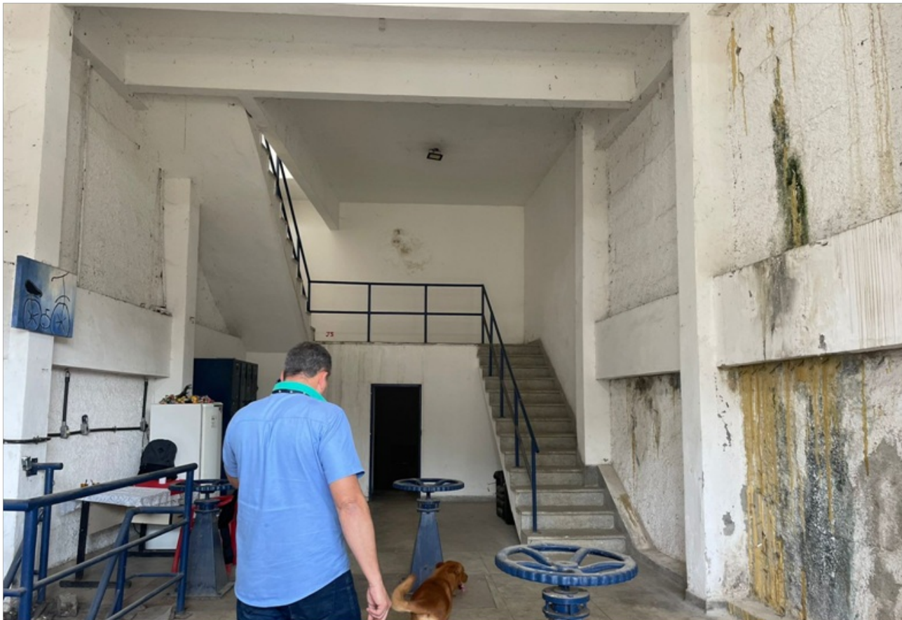
Foto 12 – Vazamento na parede interna entre as duas células
