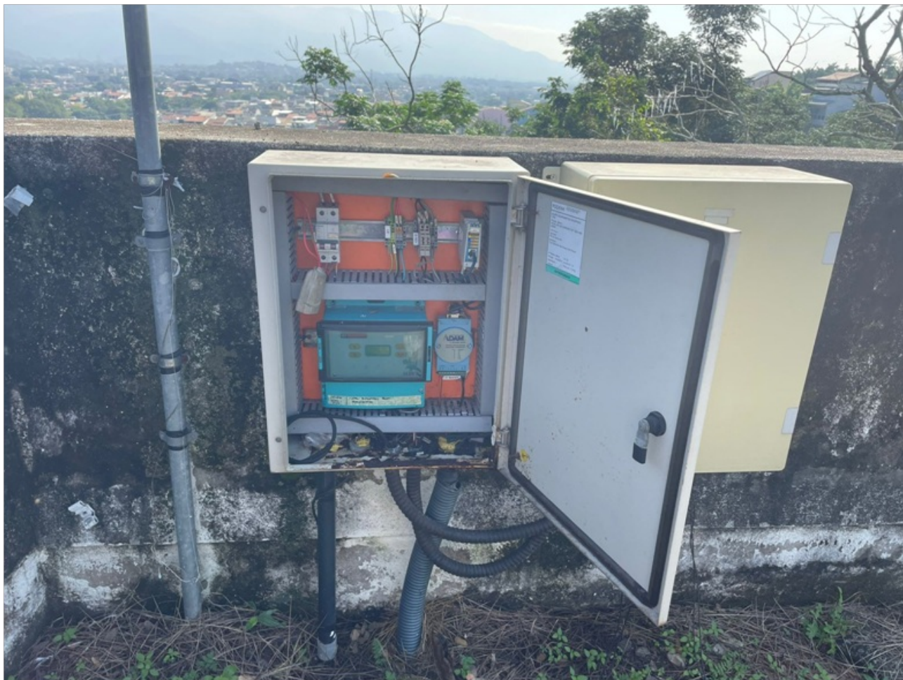
Foto 6 – Painel do medidor de nível do reservatório
