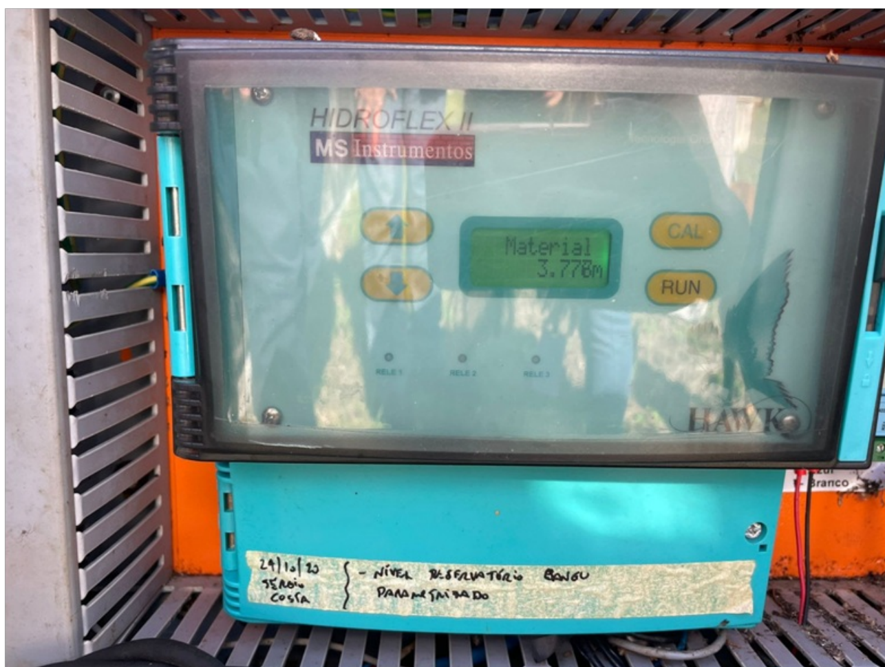
Foto 7 – Medidor de nível do reservatório
