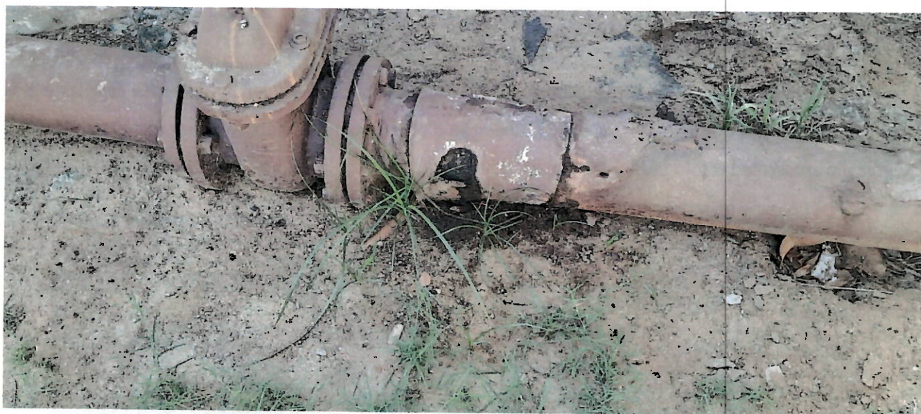
Foto 14 - Vazamento em tubulação que tem origem no desarenador.
