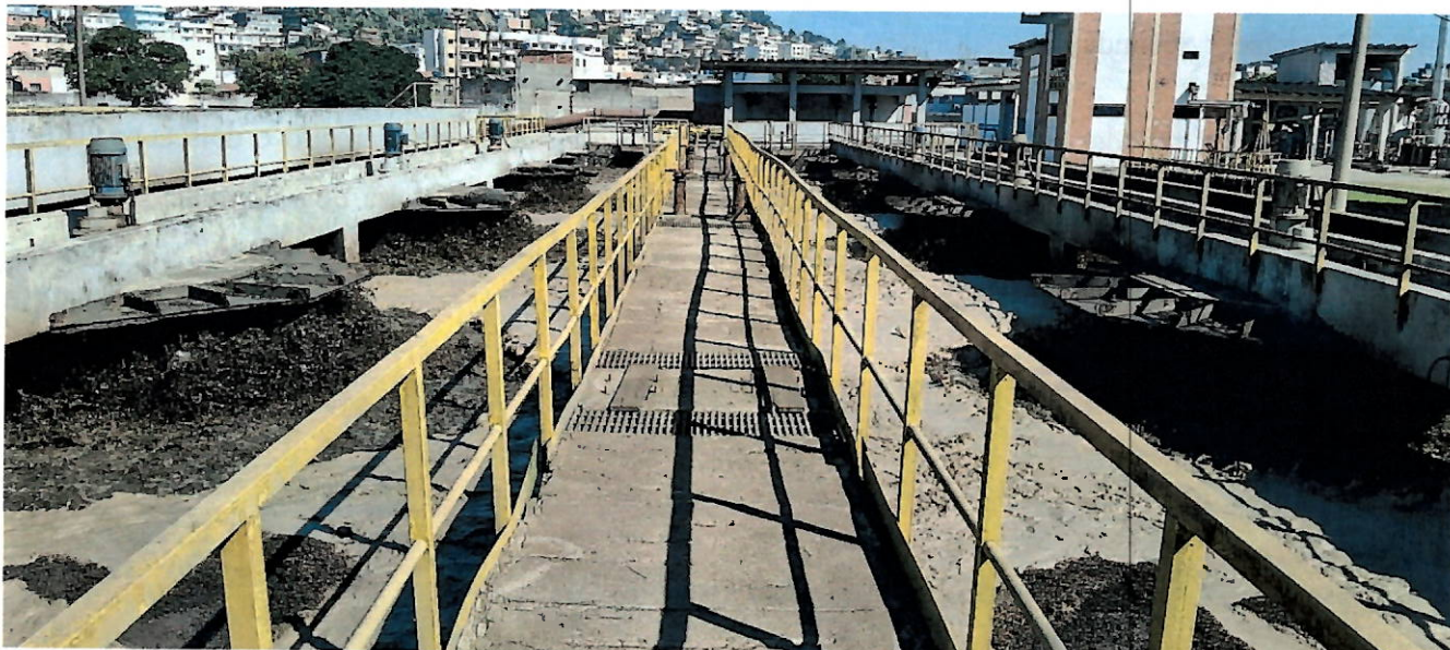
Foto 19 - Vista superior do tanque de aeração que estava em funcionamento. Destaca-se a ausência de dois registros de controle operacional.
