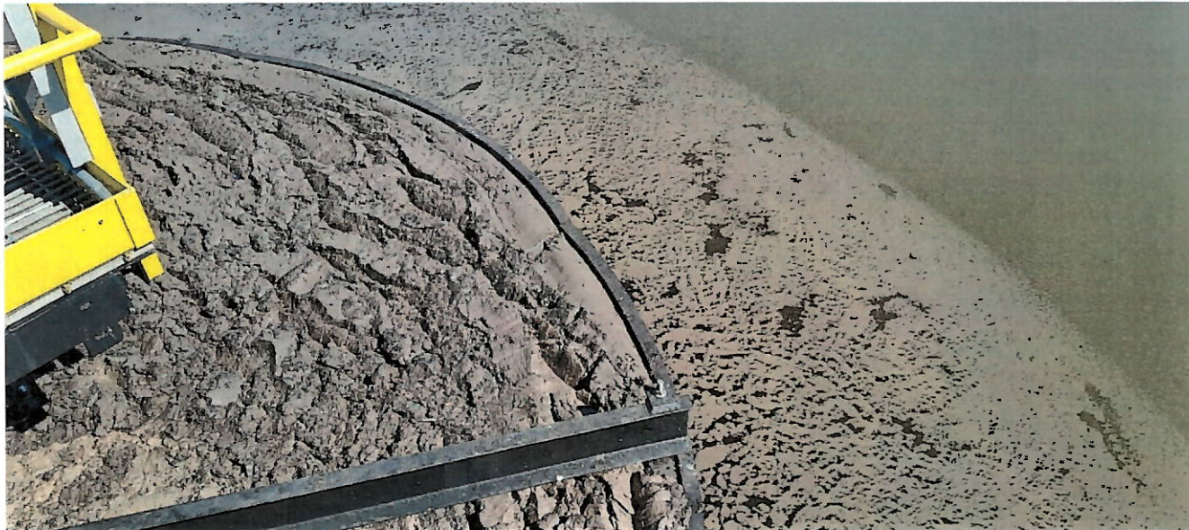
Foto 25 - Material em suspensão em excesso acumulado na região central do decantador.
