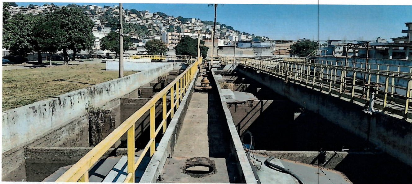
Foto 20 - Vista superior do tanque de aeração que não estava em condições de funcionamento.
