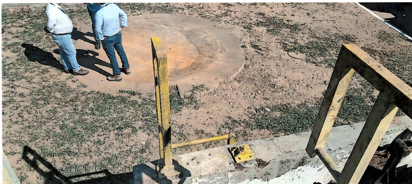
Foto 11 - Vista do topo da escada de acesso à passarela sobre o desarenador, que está sem parte do corrimão.
