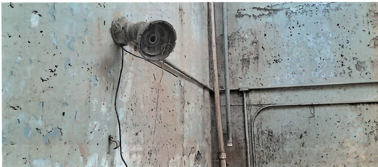
Foto 4 - Luminária sem lâmpadas.
