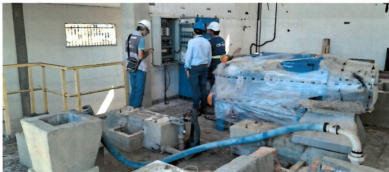
Foto 31 - Interior do prédio das centrífugas (2º andar). À direita a nova centrífuga a ser instalada e no fundo o novo quadro de comando elétrico (primeiro dia de vistoria).
