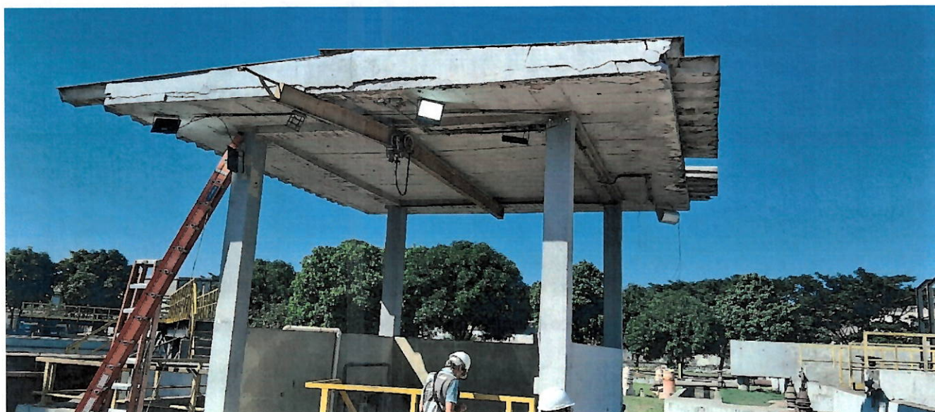
Foto 26 - Vista externa da elevatória de recirculação de lodo. Destaca-se que a cobertura apresenta rachaduras e ausência de telhas.
