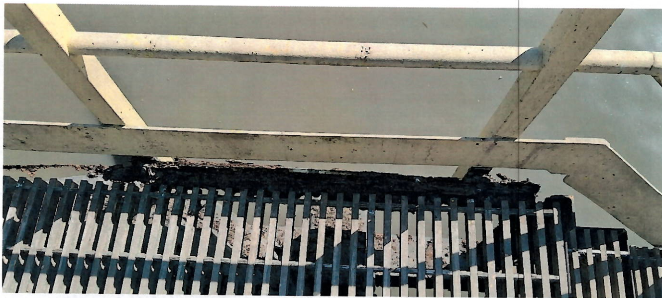
Foto 10 - Vista do piso da passarela sobre o desarenador. A fixação do piso está corroída e o piso encontrava-se com instabilidade.
