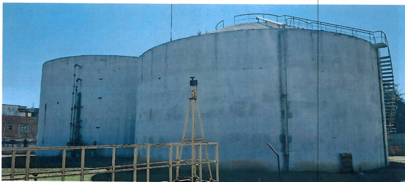
Foto 29 - Digestores de lodo. Digestor anaeróbio em primeiro plano.
