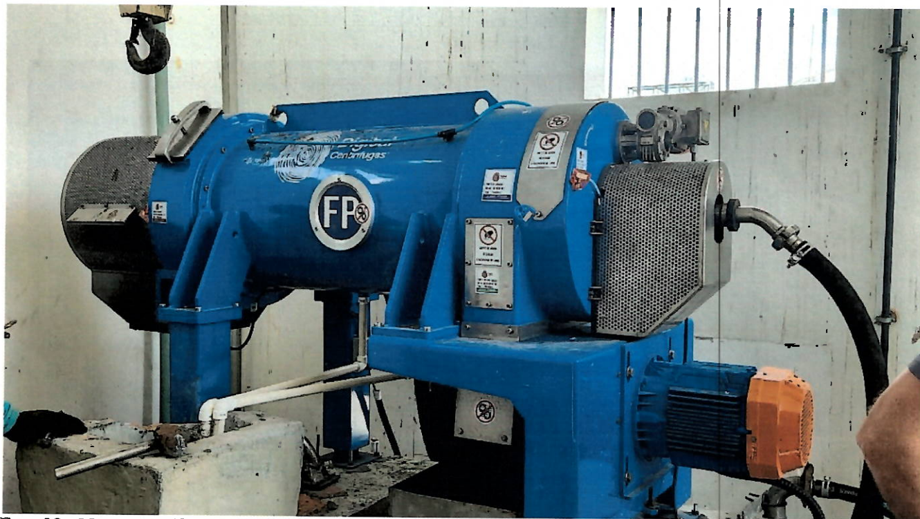
Foto 32 - Nova centrífuga com instalação concluída (segundo dia de vistoria).
