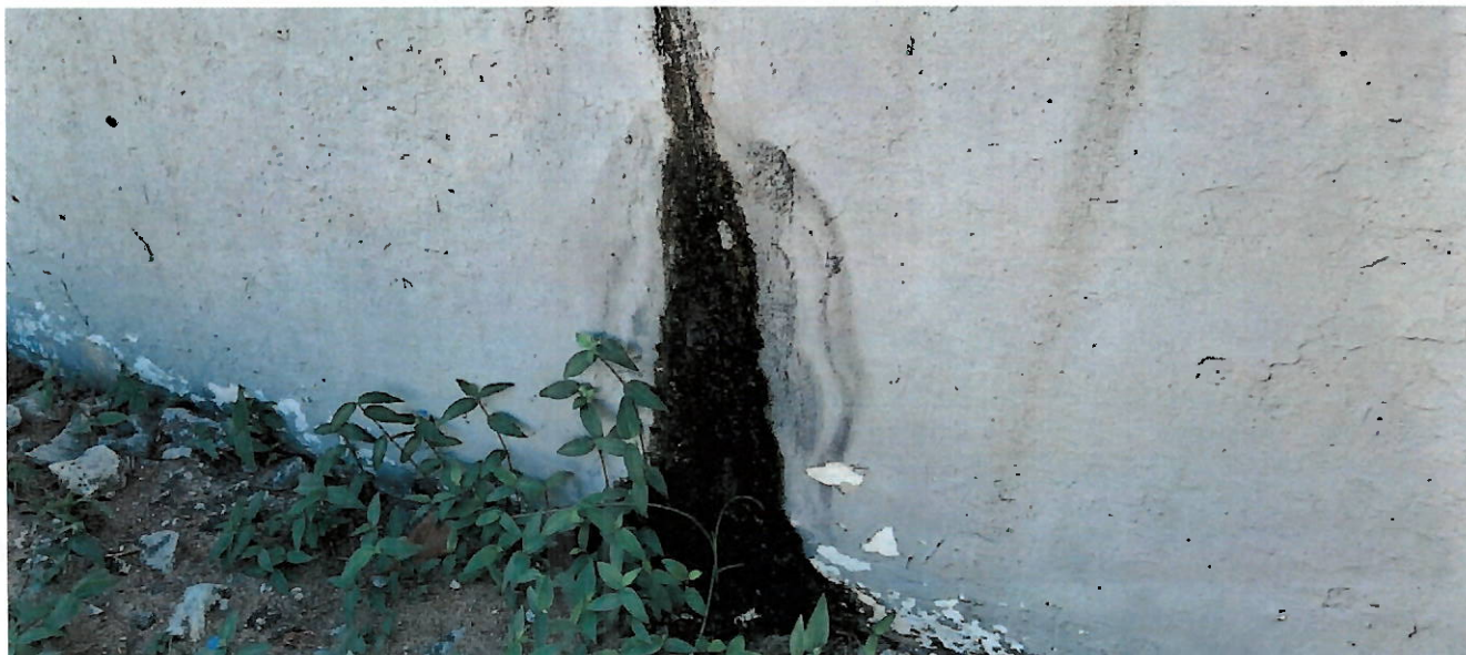
Foto 15 – Vazamento, próximo à Calha Parshall, na parede do canal que se origina no desarenador.
