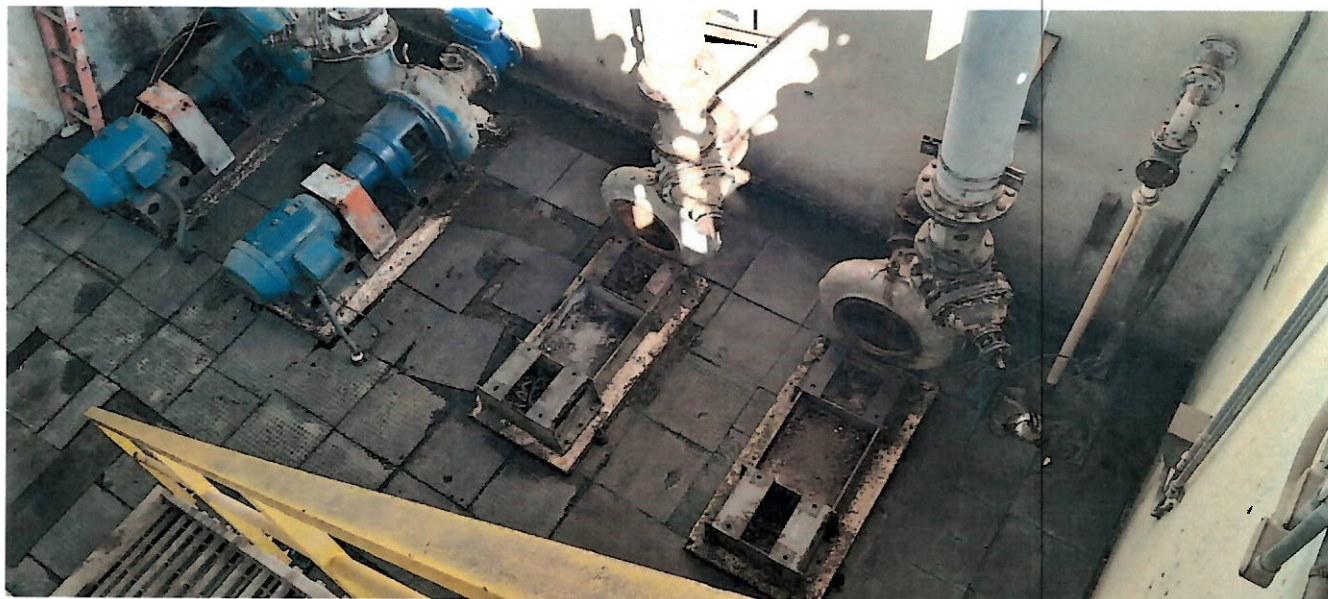
Foto 27 - Vista da casa de bombas. Destaca-se que havia placas do revestimento do piso soltas.
