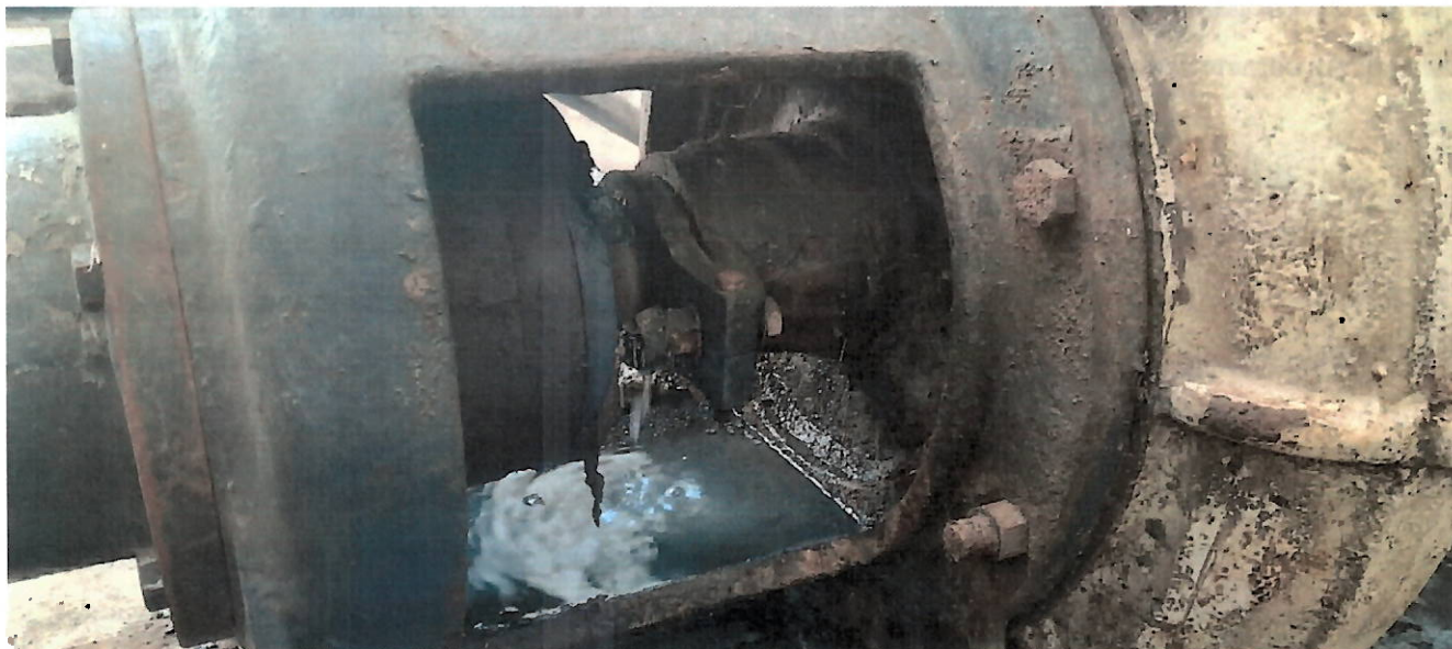
Foto 3 - Motobomba com vazamento.
