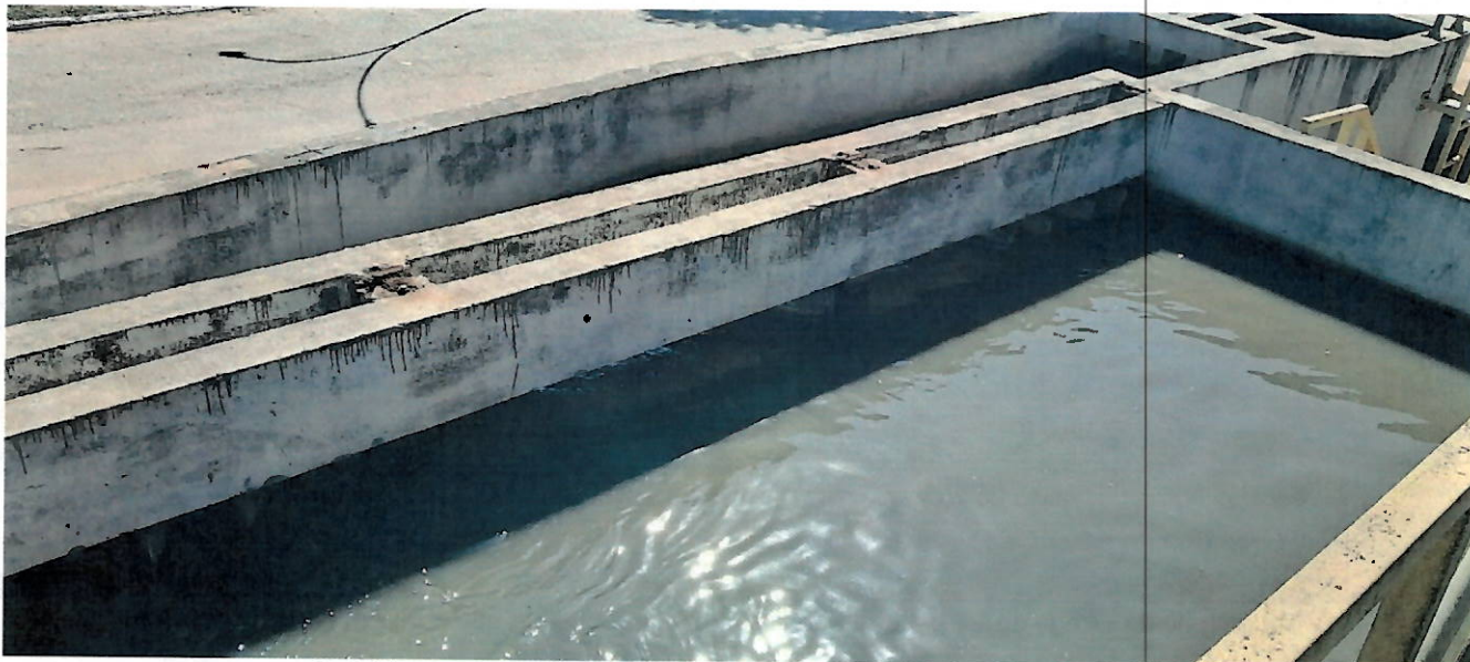
Foto 9 - Vista superior do desarenador, canal de entrada do efluente no fundo.
