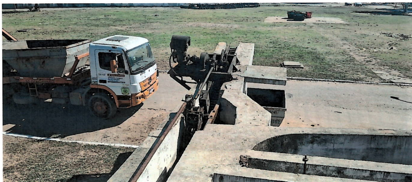
Foto 12 - Vista superior do transportador de sólidos do desarenador.
