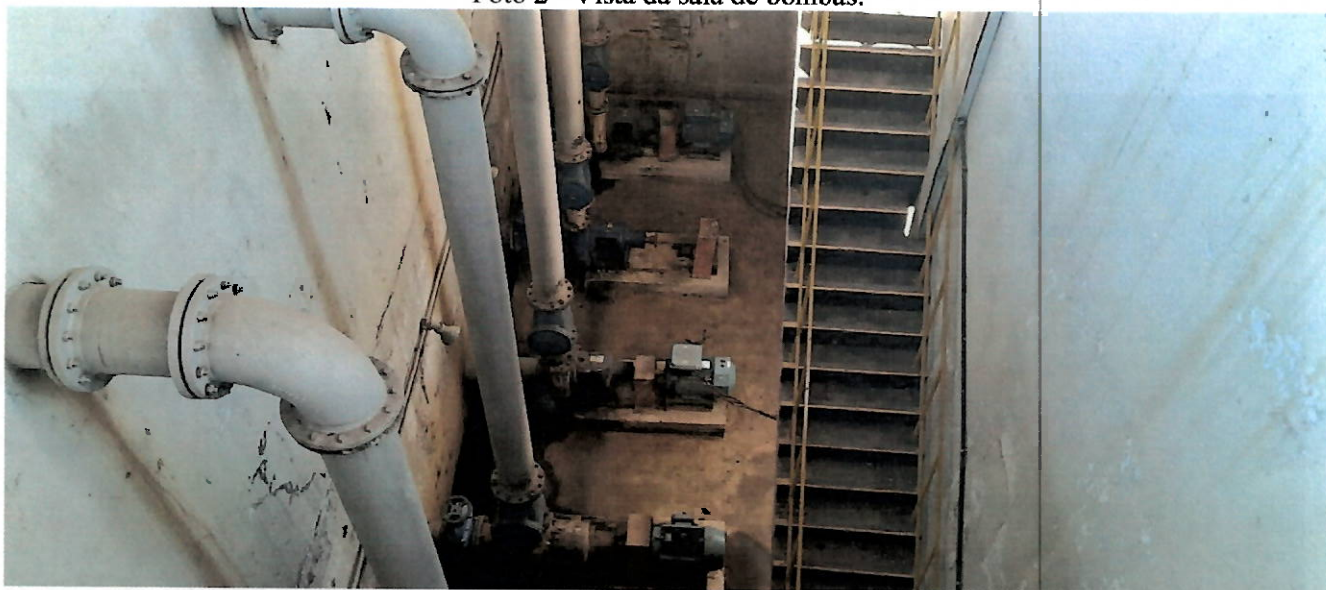
Foto 2 - Vista da sala de bombas.
