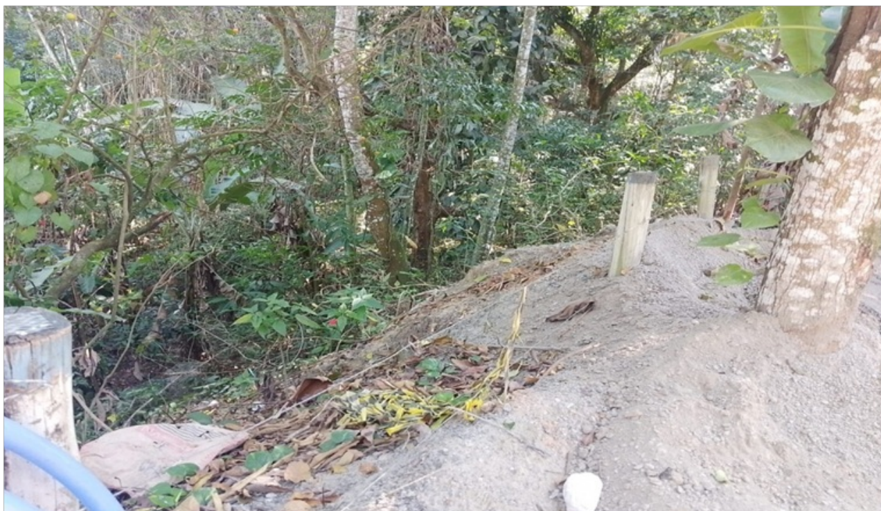
Foto 02 – Perímetro da ETA comprometido.
