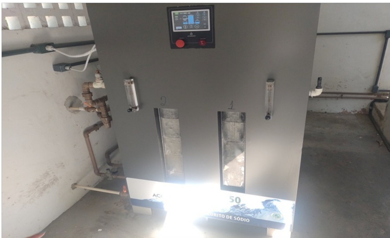
Foto 15 - Gerador de hipoclorito de sódio.
