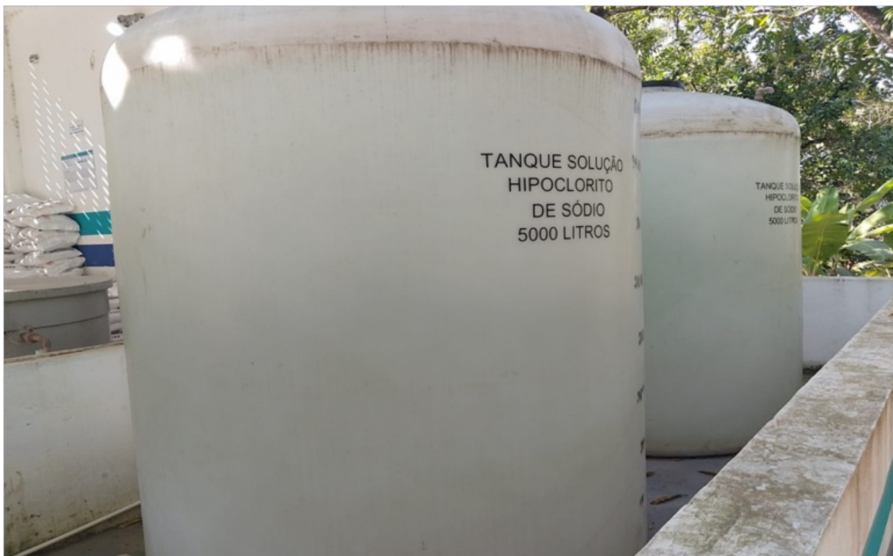
Foto 16 – Tanques solução de hipoclorito de sódio 5000 litros.
