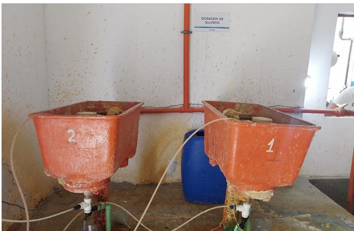
Foto 04 – Dosadores de coagulante, tubulação com excesso de sujidades.
