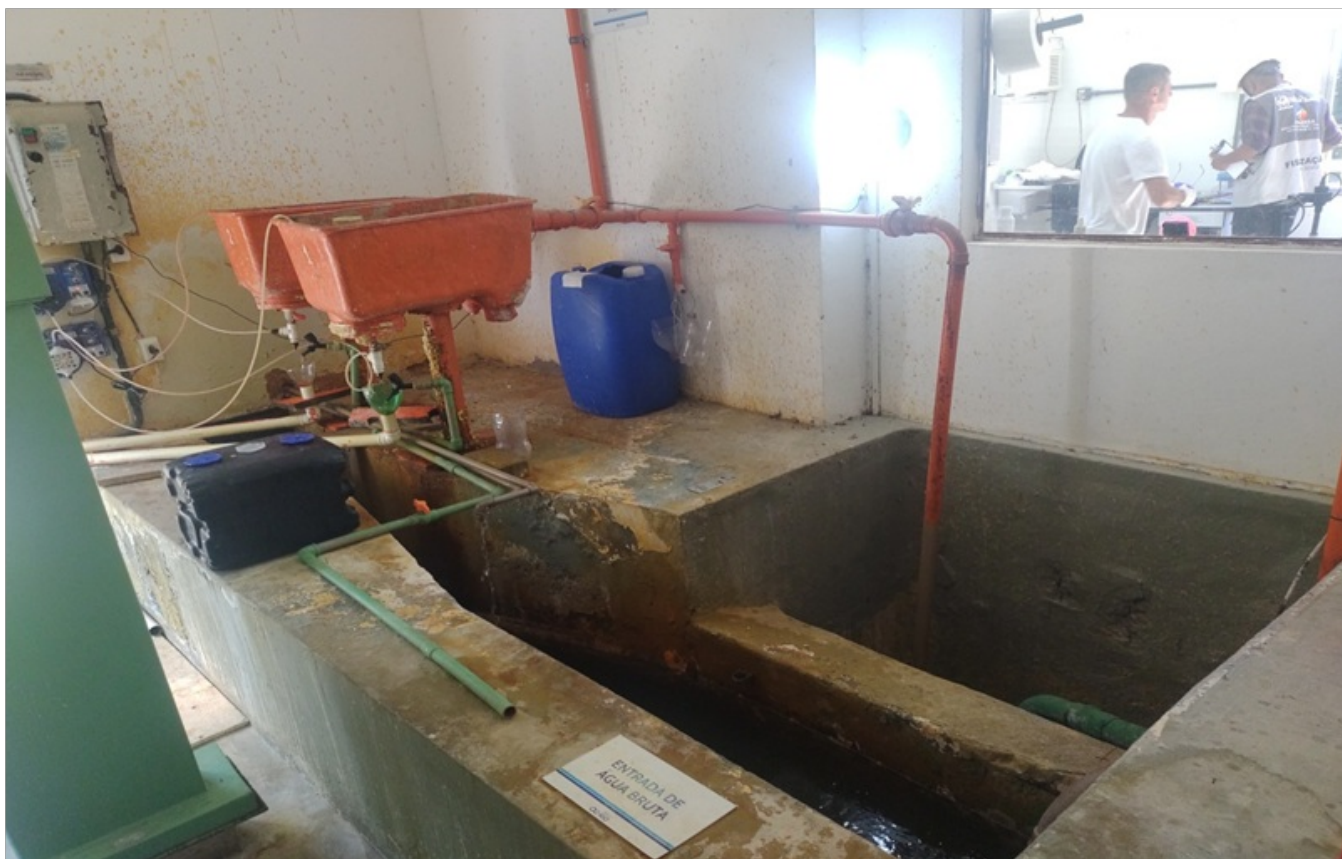
Foto 03 – Calha Parshall e aplicação de coagulante.
