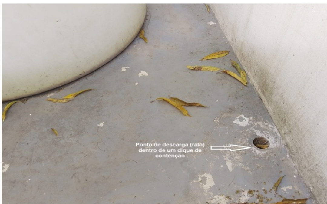
Foto 19 – Ponto de descarga dentro do dique de contenção dos tanques de hipoclorito de sódio.
