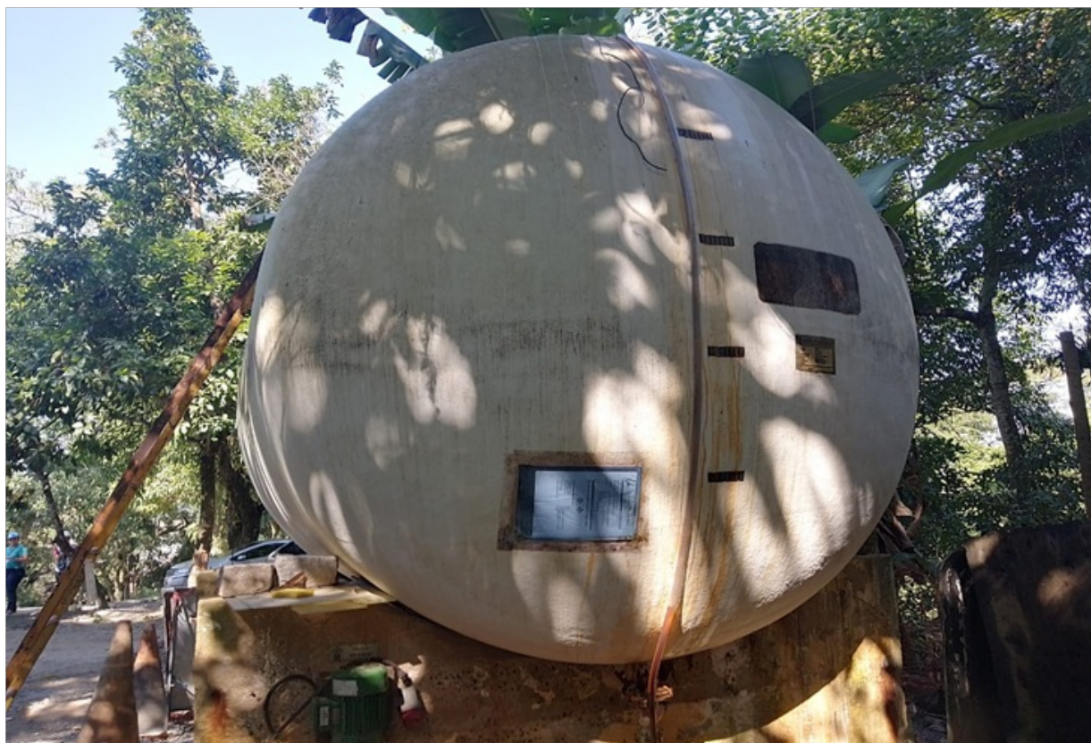
Foto 05 – Tanque de armazenamento de Sulfato de Alumínio, faltando bacia de contenção, Dique de Contenção.
