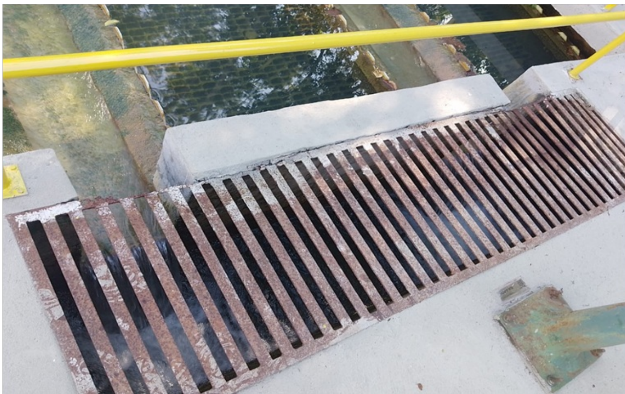
Foto 09 – Falta de conservação e manutenção.
