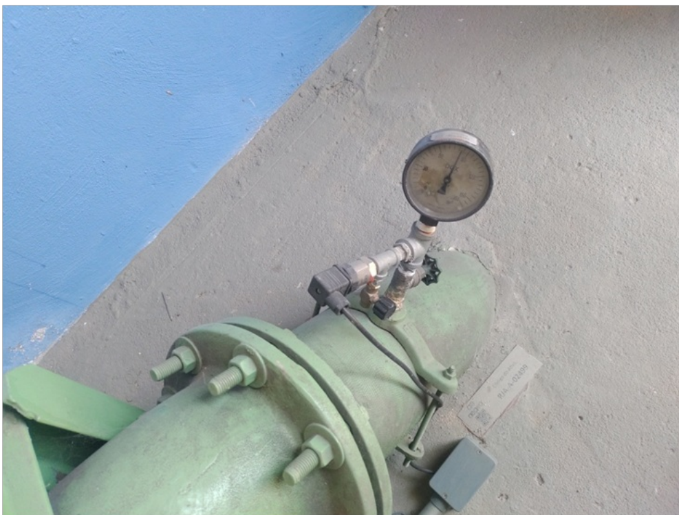
Foto 4 – Medidor instalado na tubulação de retaguarda
