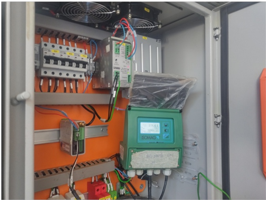
Foto 7 – Quadro de automação
