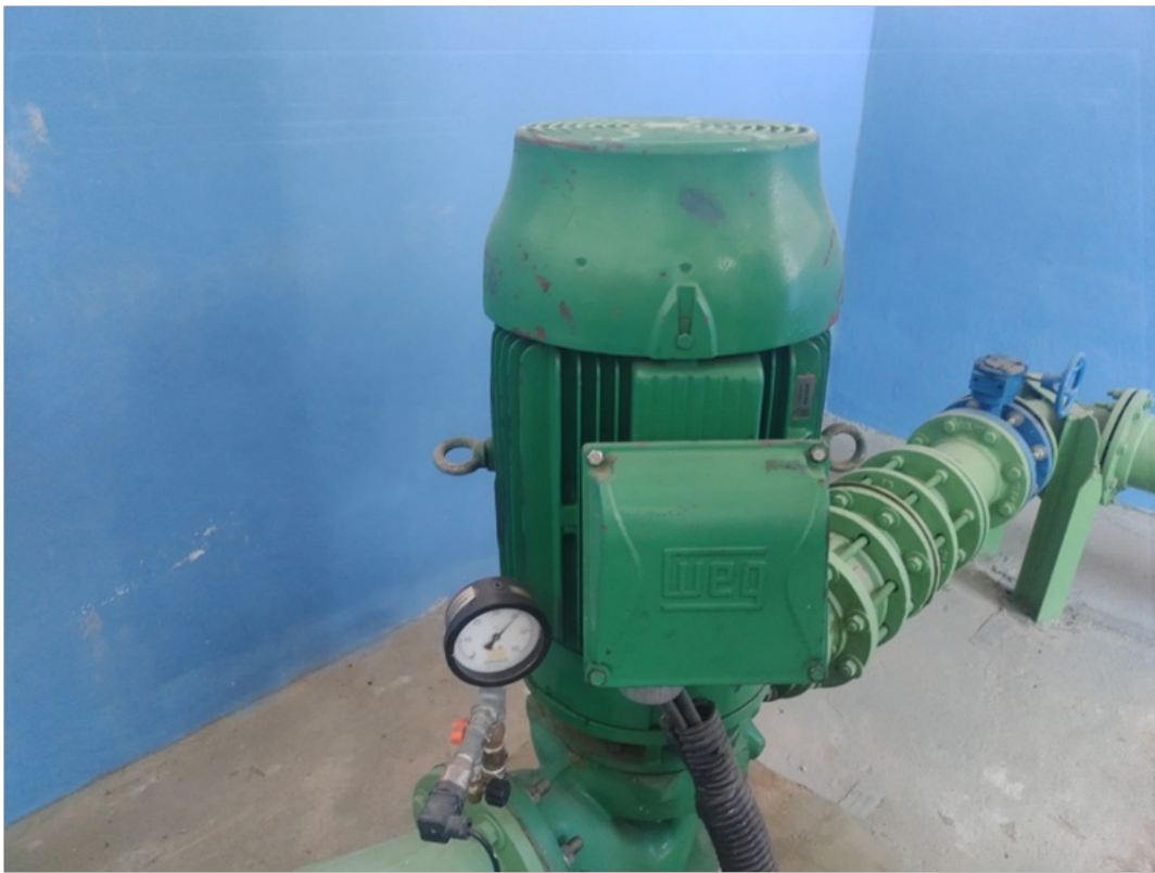
Foto 5 – Medidor instalado na tubulação de recalque
