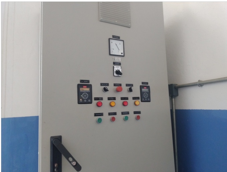
Foto 6 – Quadro de comando
