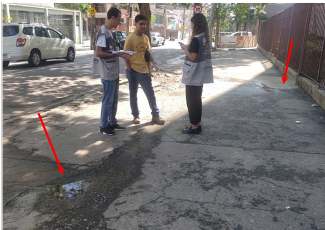
Foto 5 – Pontos vazamento água potável Rua Vilela Tavares
