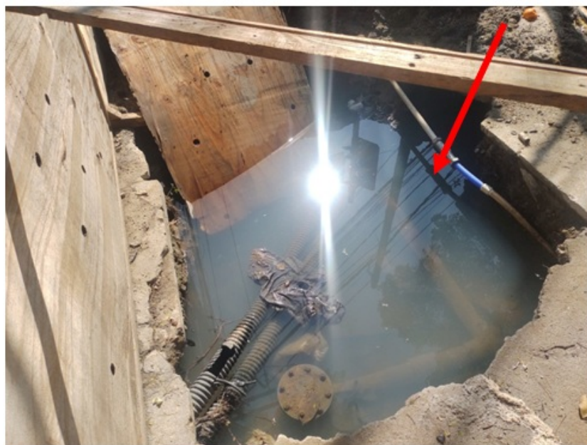
Foto 3 – Buraco Rua Aquidabã esquina Rua Vilela Tavares
