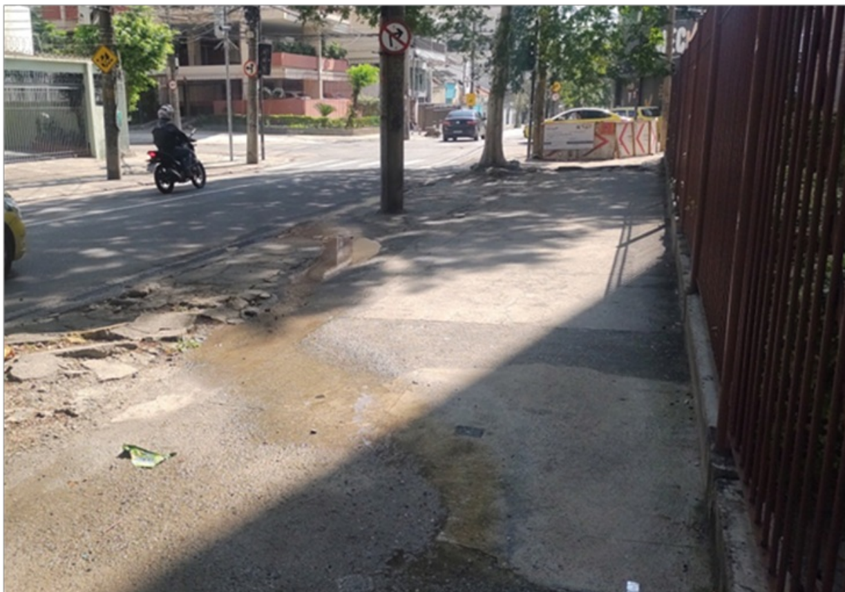
Foto 4 – Vazamento água potável Rua Vilela Tavares
