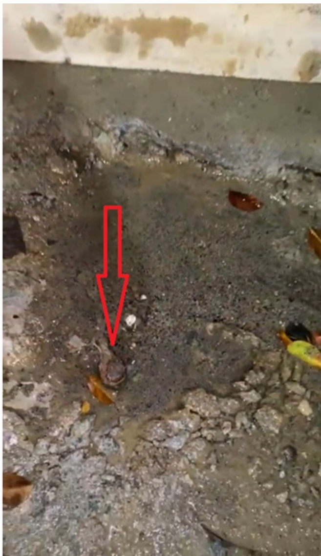
Foto 1 – Ponto exato do vazamento de água potável
