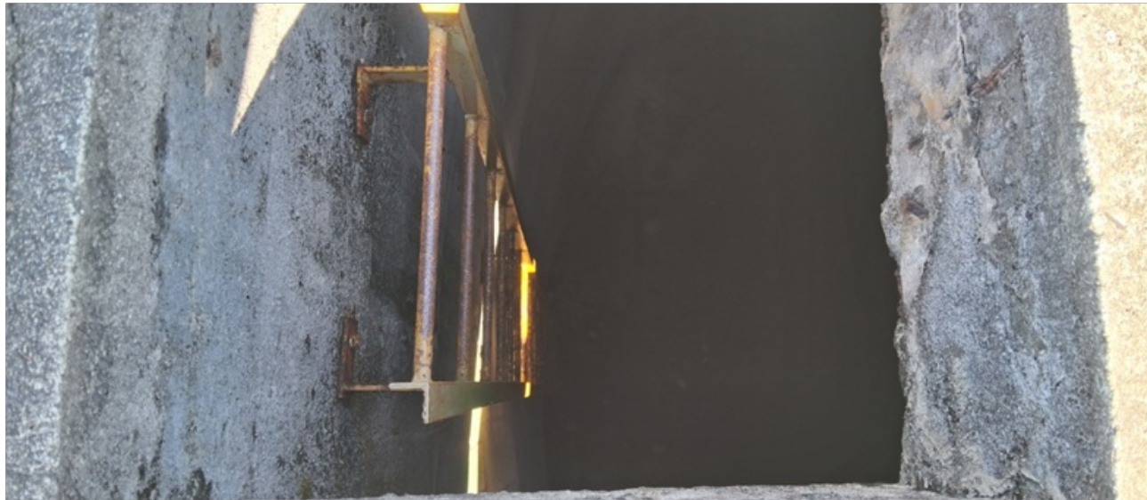
Foto 1 – Reservatório sem a presença de água. O acesso da está sem tampa, oferecendo risco de acidente grave.
