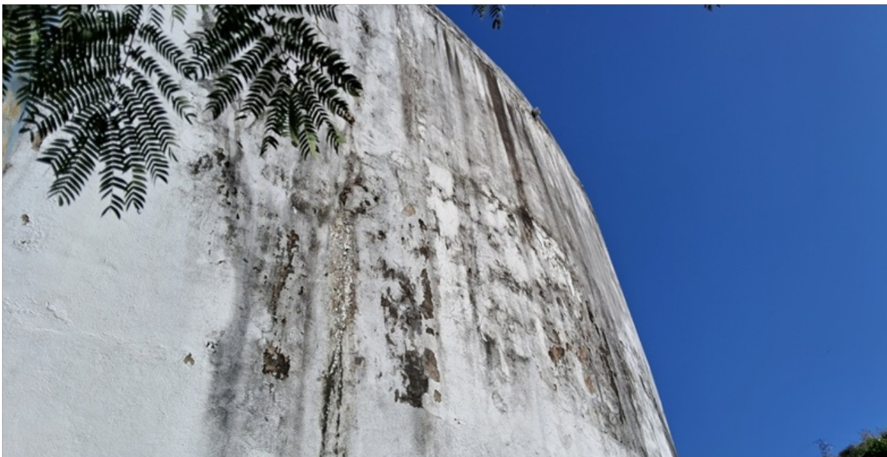
Foto 11 – Reservatório com pintura deteriorada
