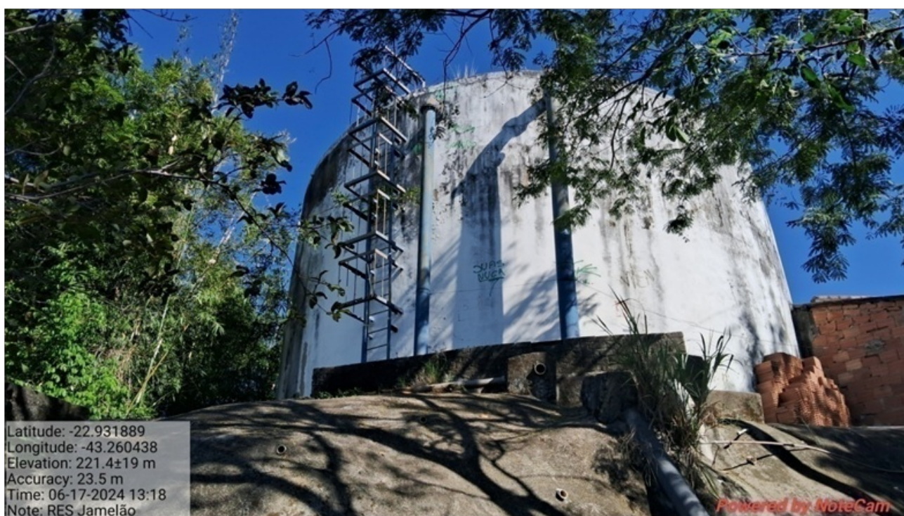
Foto 10 – Reservatório sem identificação, placa de restrição e cerca de proteção
