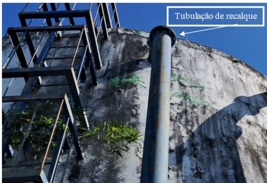
Foto 4 – Tubulação de recalque
