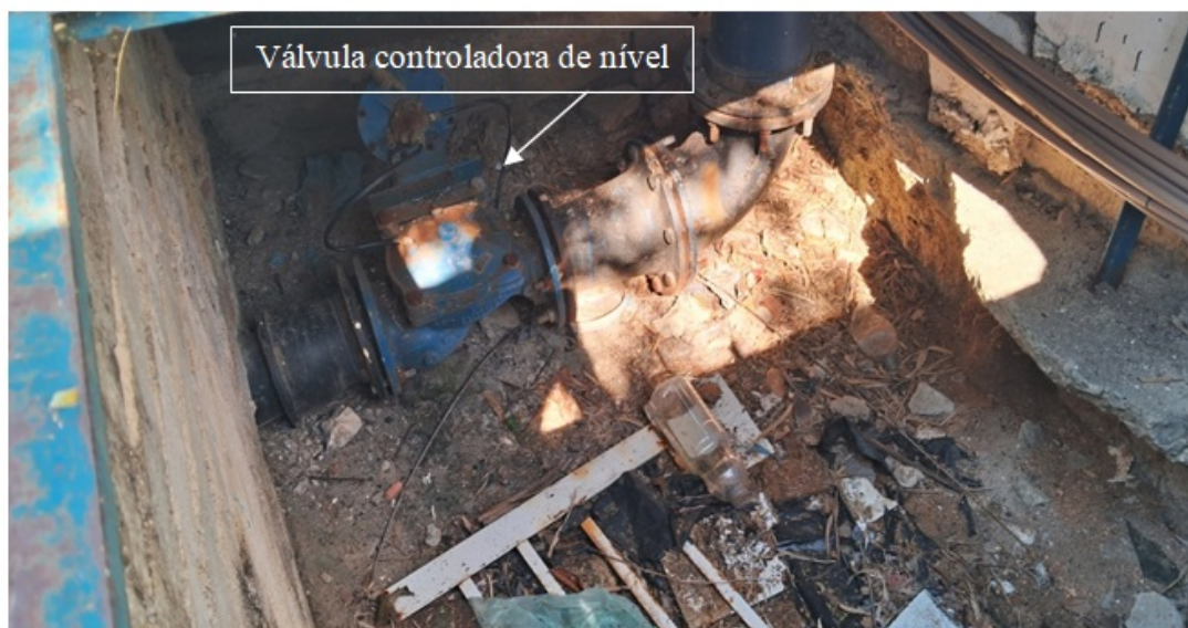
Foto 7 – Válvula controladora de nível
