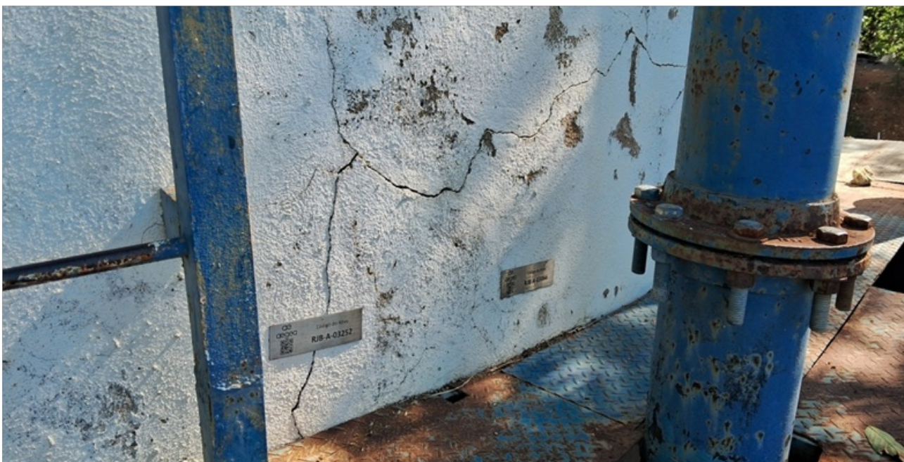
Foto 12 – Rachaduras na célula
