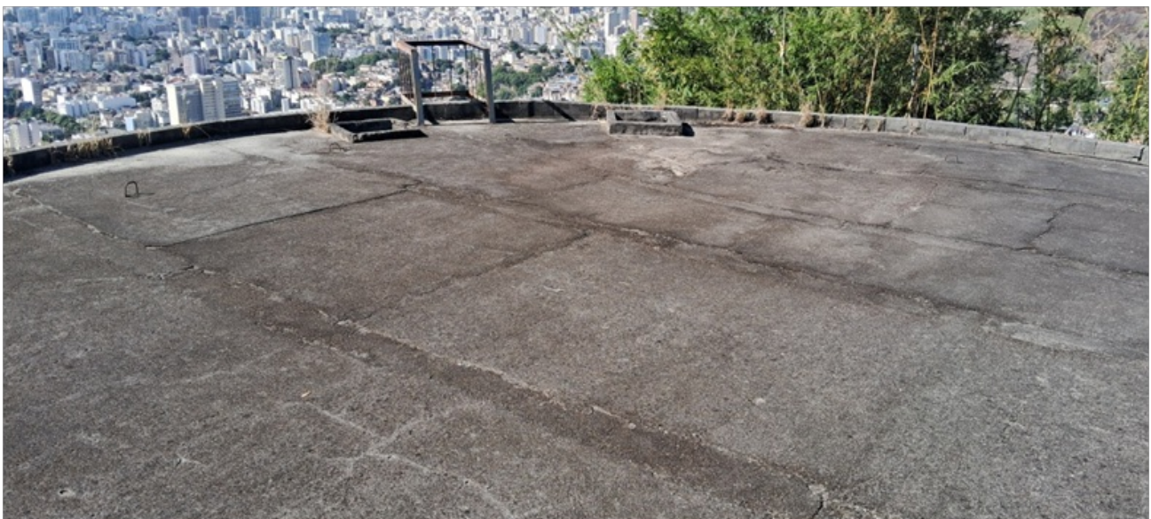
Foto 14 – Parte superior não provida de grade de proteção
