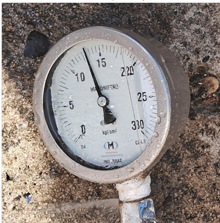
Foto 8 – Manômetro marcando pressão do recalque em Kgf/cm2
