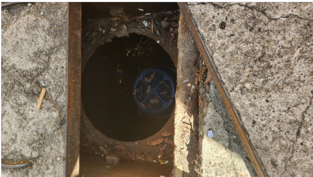
Foto 3 – Vista do abrigo da bomba internamente
