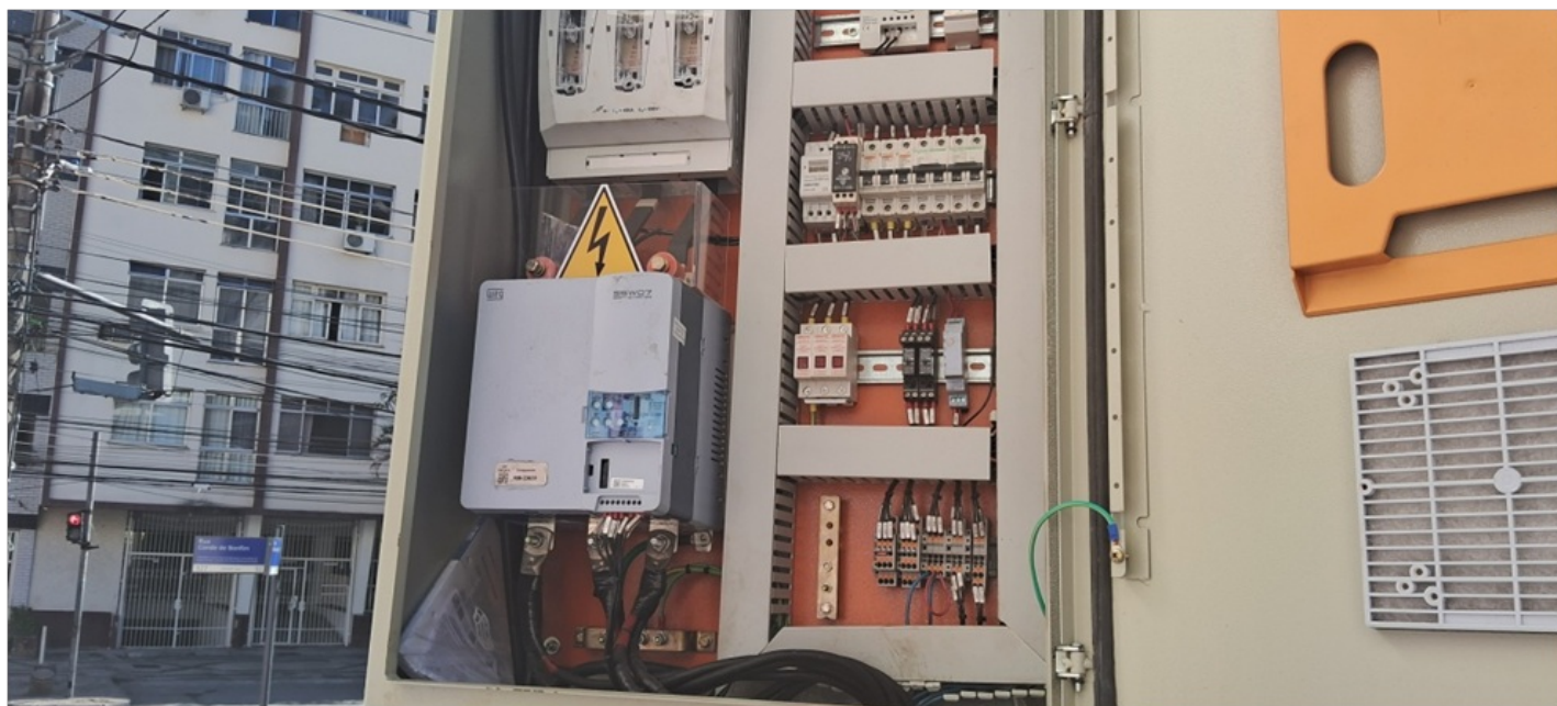
Foto 2 – Vista interna do painel elétrico
