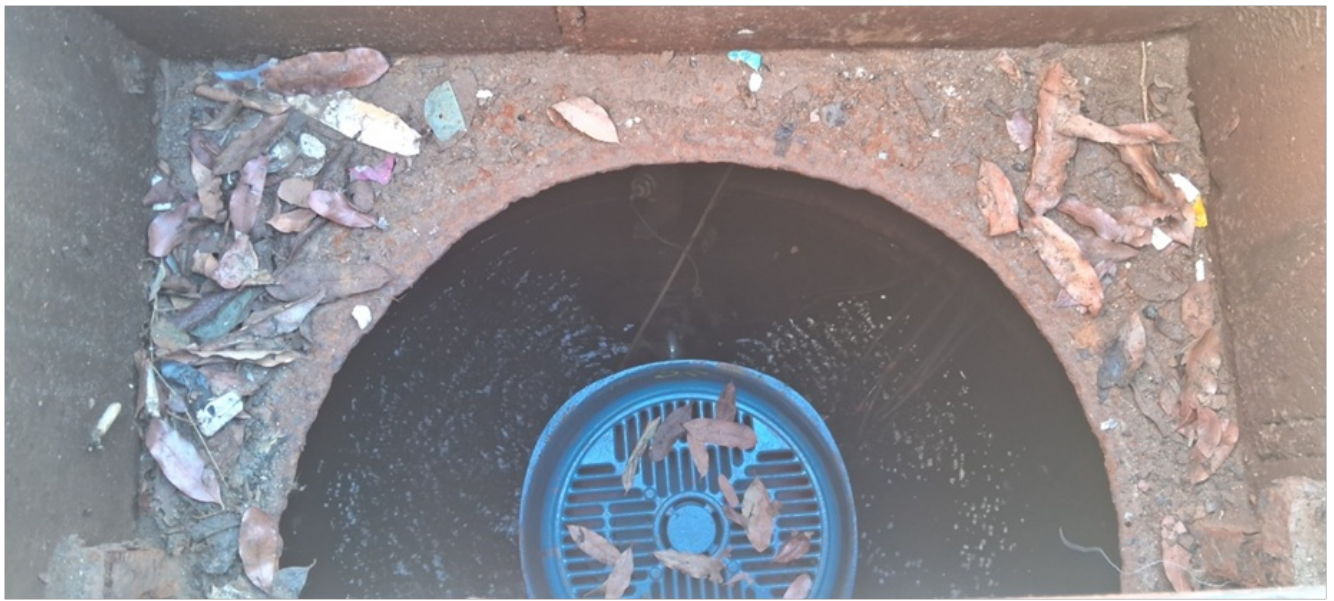
Foto 5 – Água no interior do abrigo
