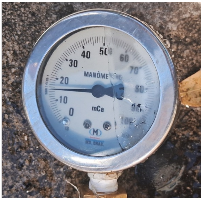
Foto 7 – Manômetro marcando pressão da retaguarda em MCA
