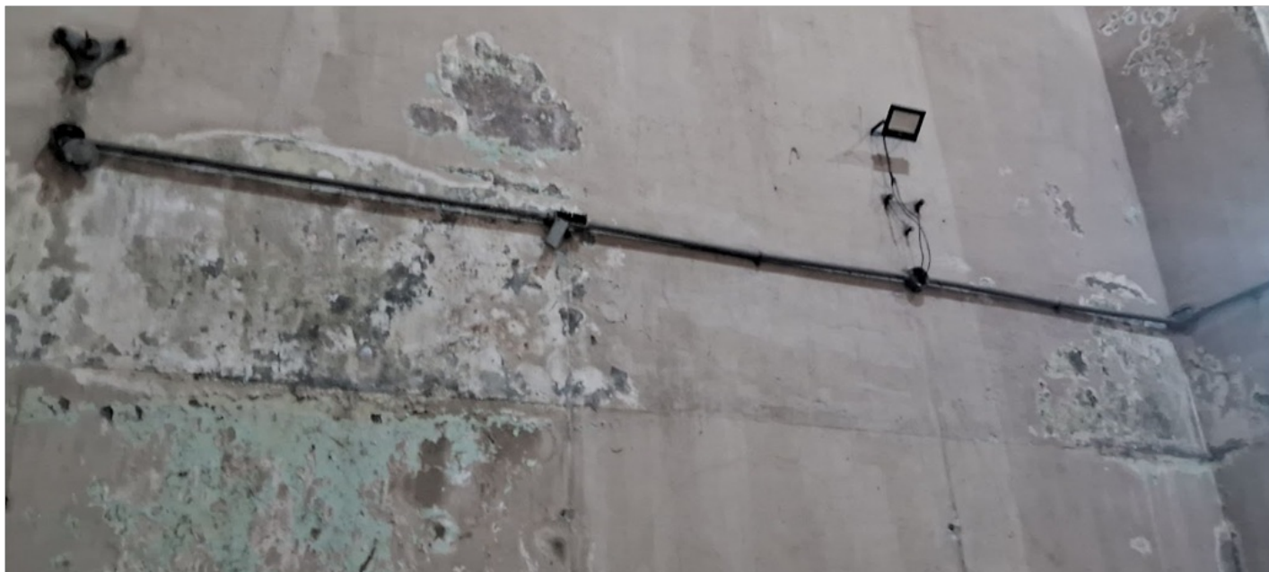
Foto 15 - Revestimento descascado na parede da casa de bombas.
