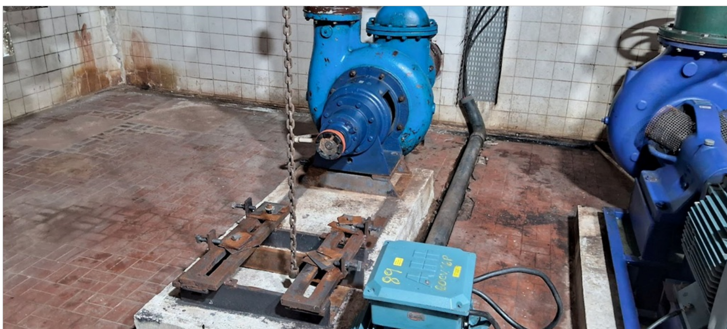
Foto 14 - Conjunto motobomba que não estava operando por motivo de manutenção.
