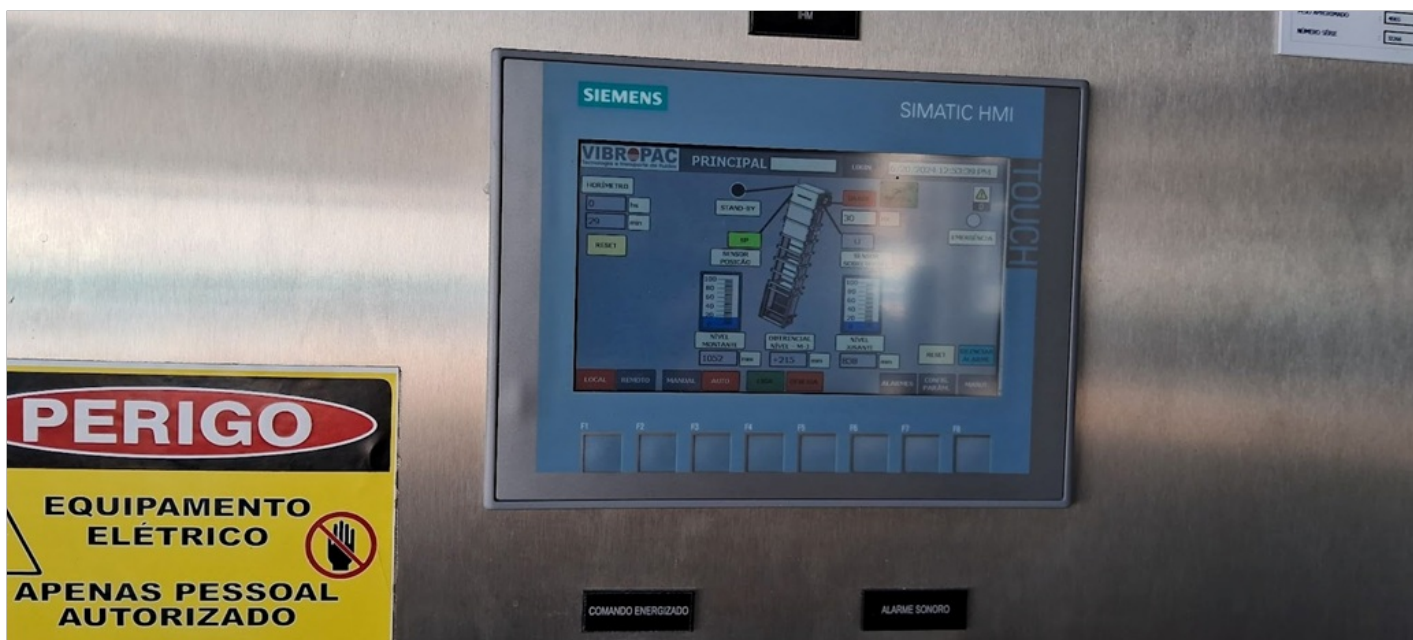
Foto 4 - Paineleletrônico de monitoramento e controle do gradeamento.
