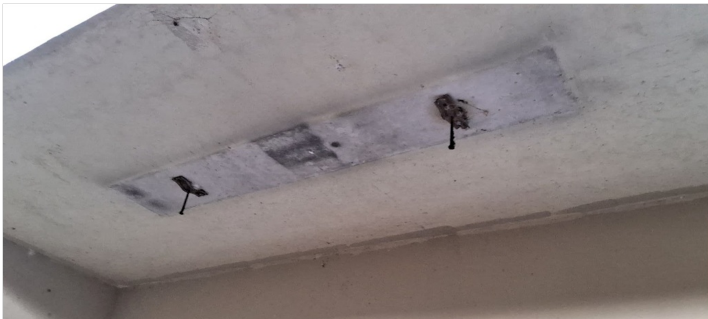
Foto 7 - Ausência de luminária.
