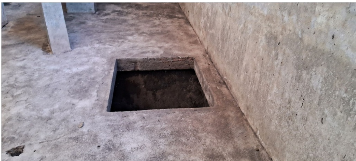
Foto 8 - Visita do poço de sucção sem tampa.
