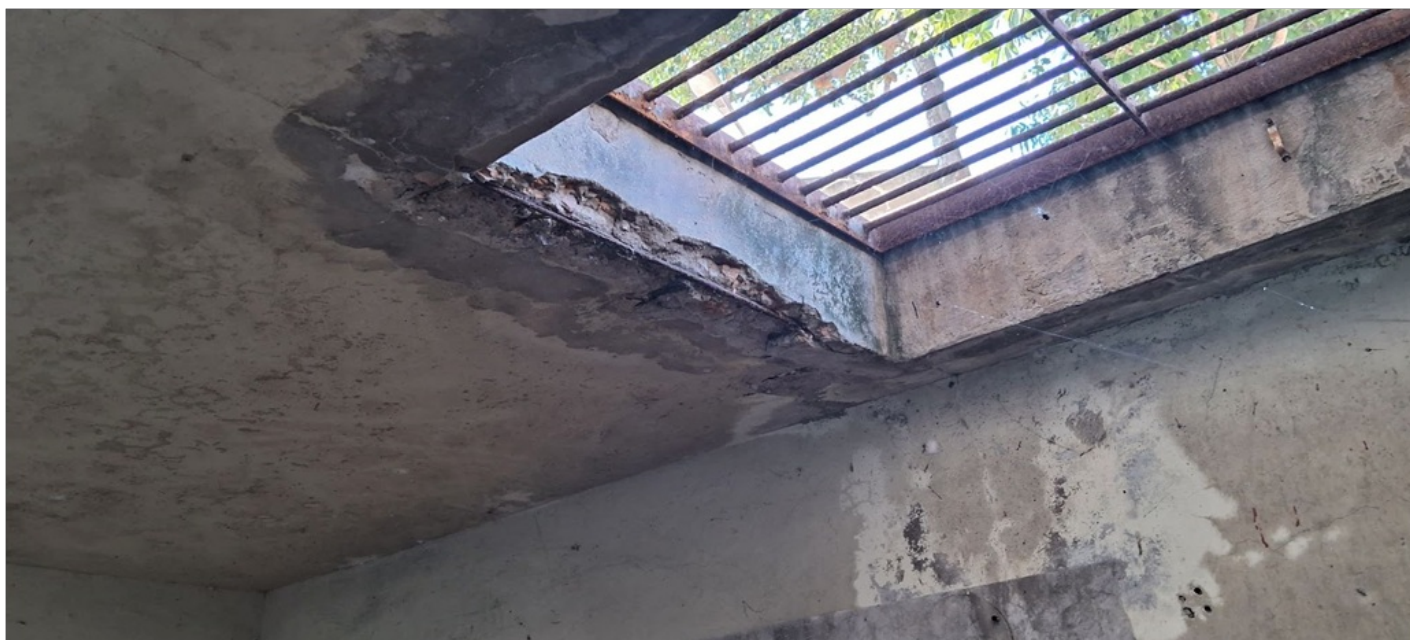
Foto 6 - Armadura exposta na laje sobre o barrilete de recalque
