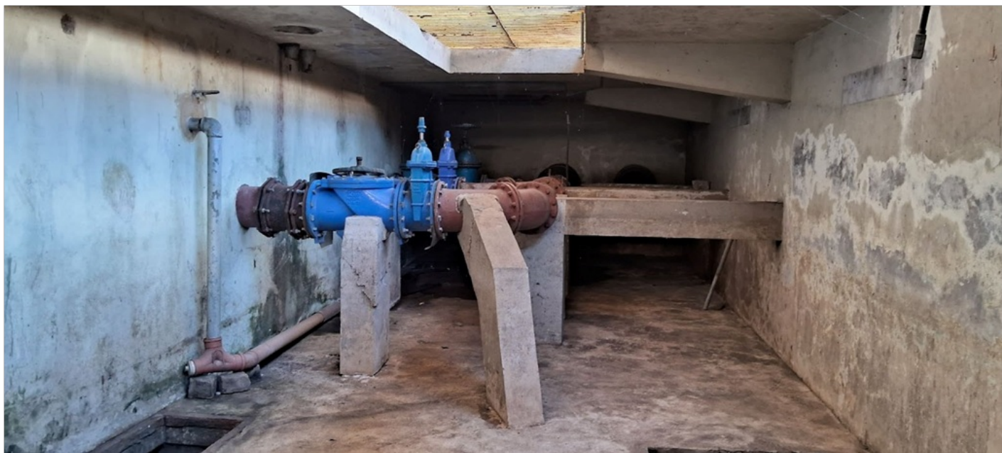
Foto 5 - Barrilete de recalque.
