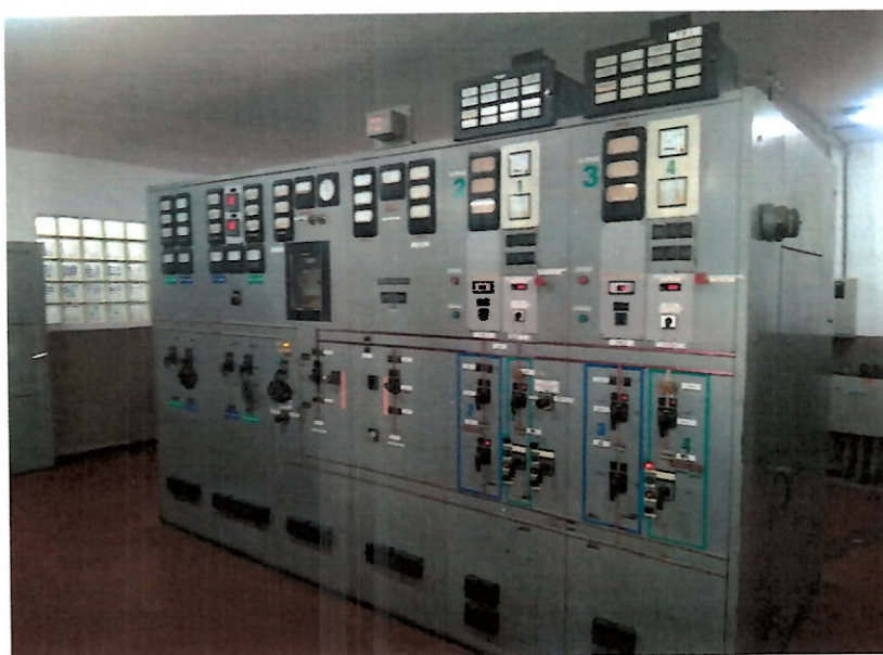
Foto 4 – painéis elétricos do COSEG.
