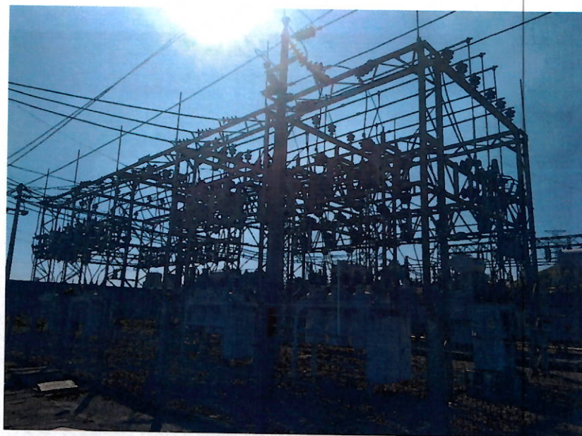
Foto 2 – Subestação Externa Principal.
