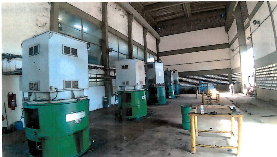
Foto 7 – Grupos motor bombas do NBRG.
