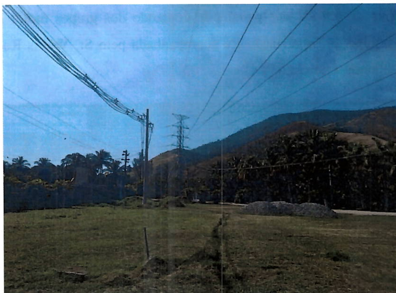
Foto 1: rede de distribuição de 138 kV à direita (entrada na subestação) e rede de 25kV à esquerda (saída da subestação).
