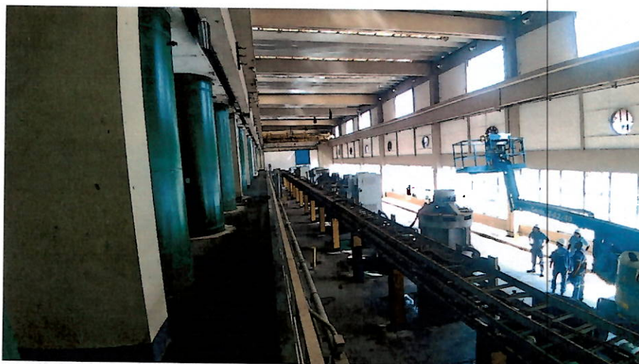
Foto 5 – Grupos motor bombas do BRG.
