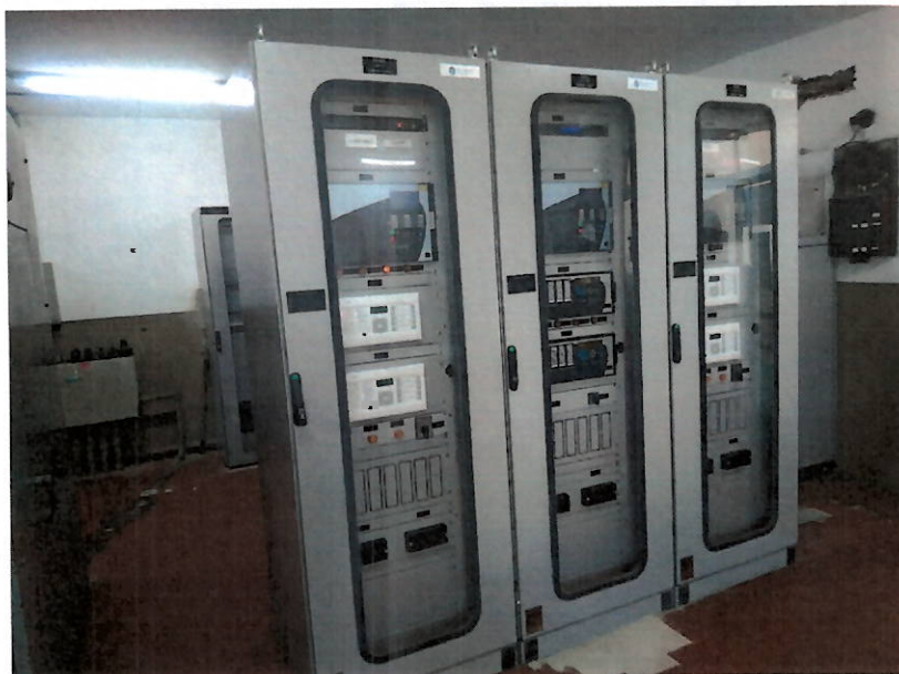
Foto 3 – painéis elétricos do COSEG.
