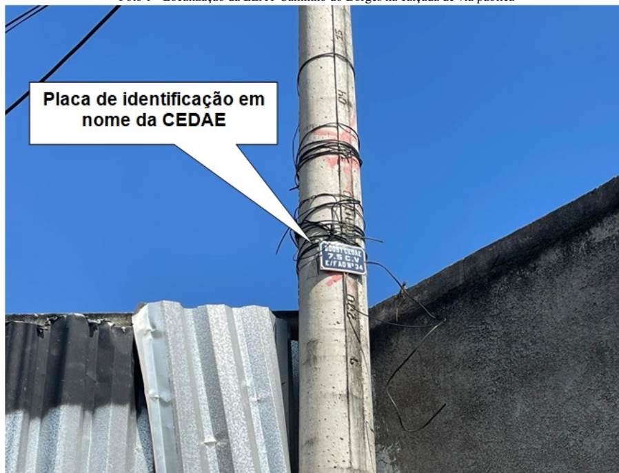
Foto 2 – Pequena placa de identificação da EEAT em nome da antiga distribuidora
