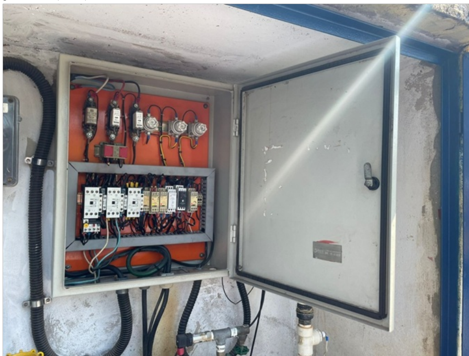
Foto 6 – Abrigo do painel de automação aberto sem sinalização de risco de choque elétrico.
