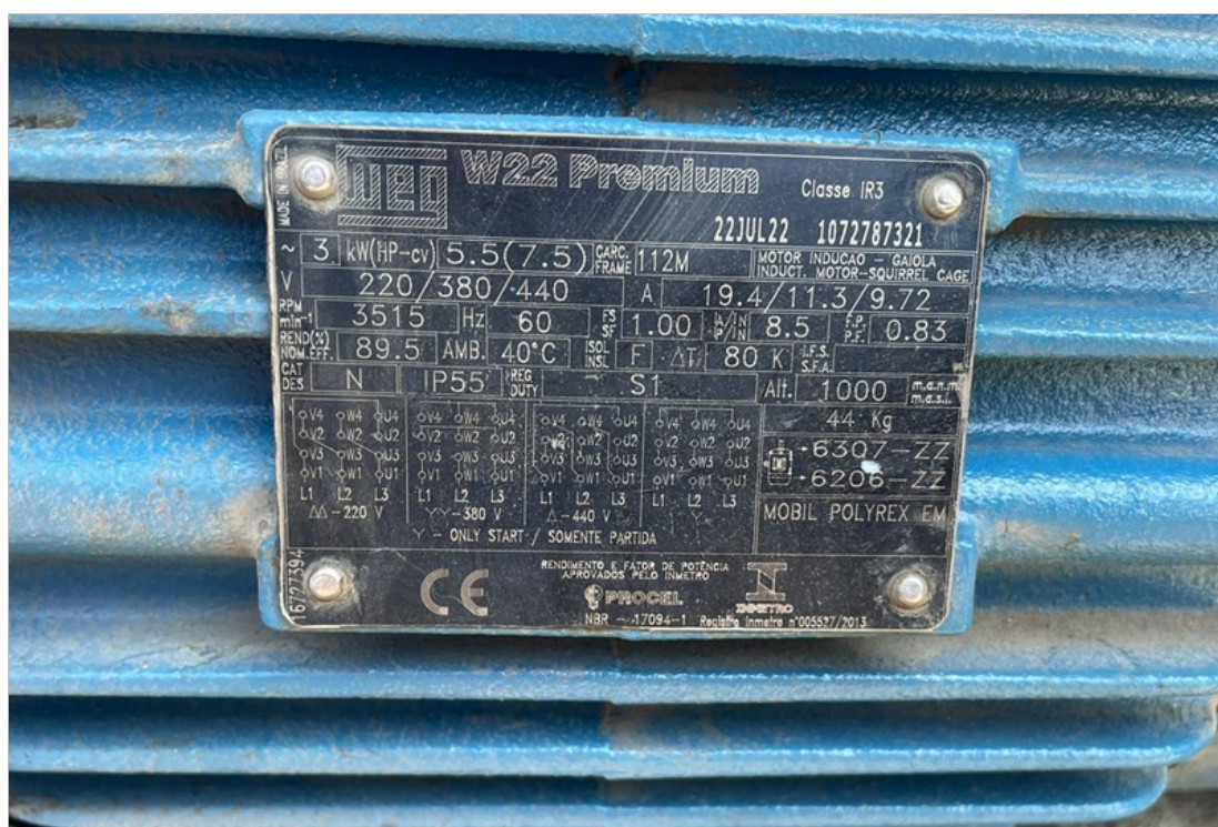
Foto 4 – Placa de identificação da bomba da EEAT
