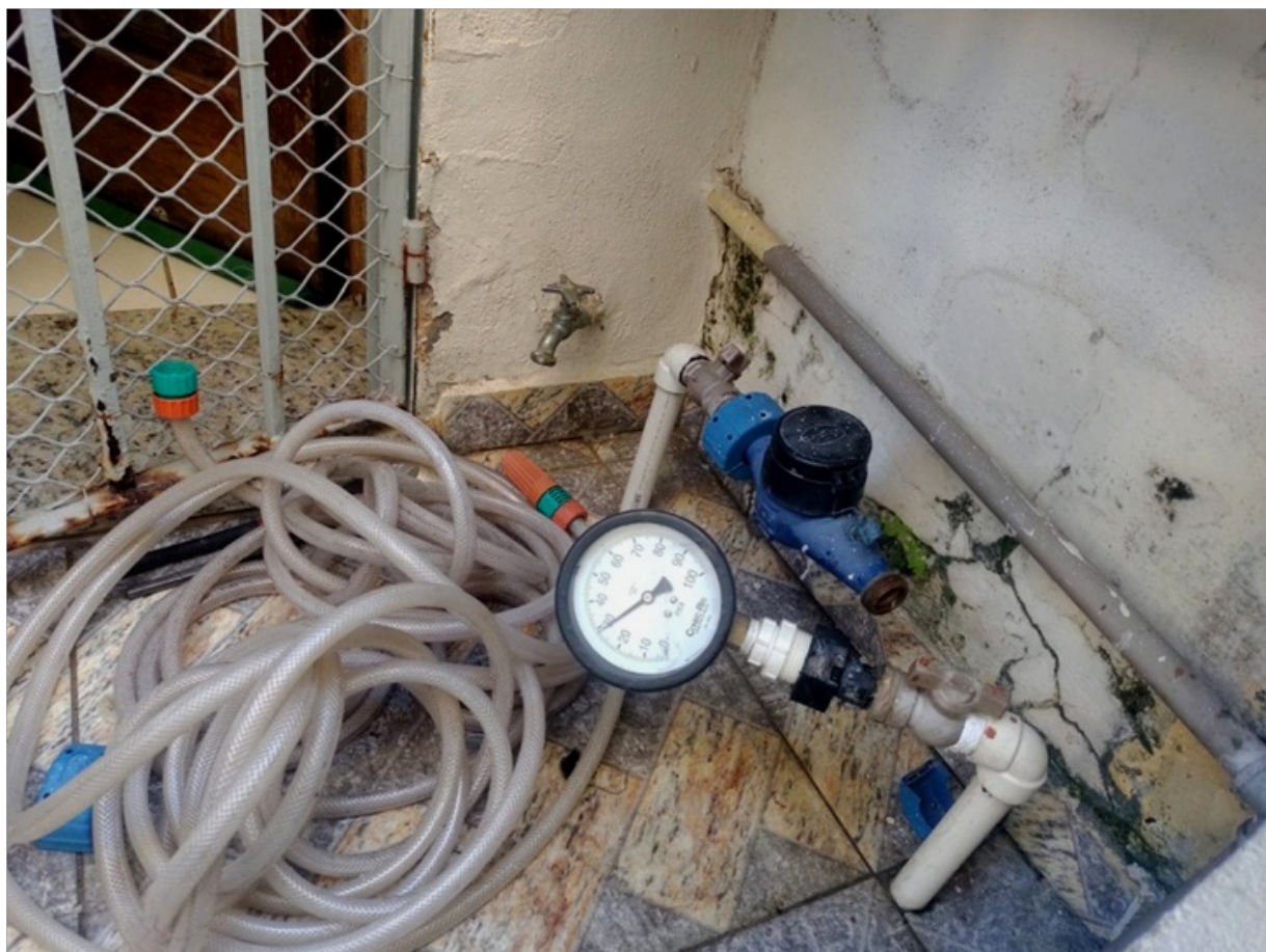
Foto 7 – Pressão averiguada casa 6 (28 mca)
