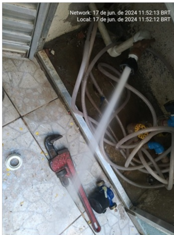
Foto 5 – Fluxo saída de água casa 12
