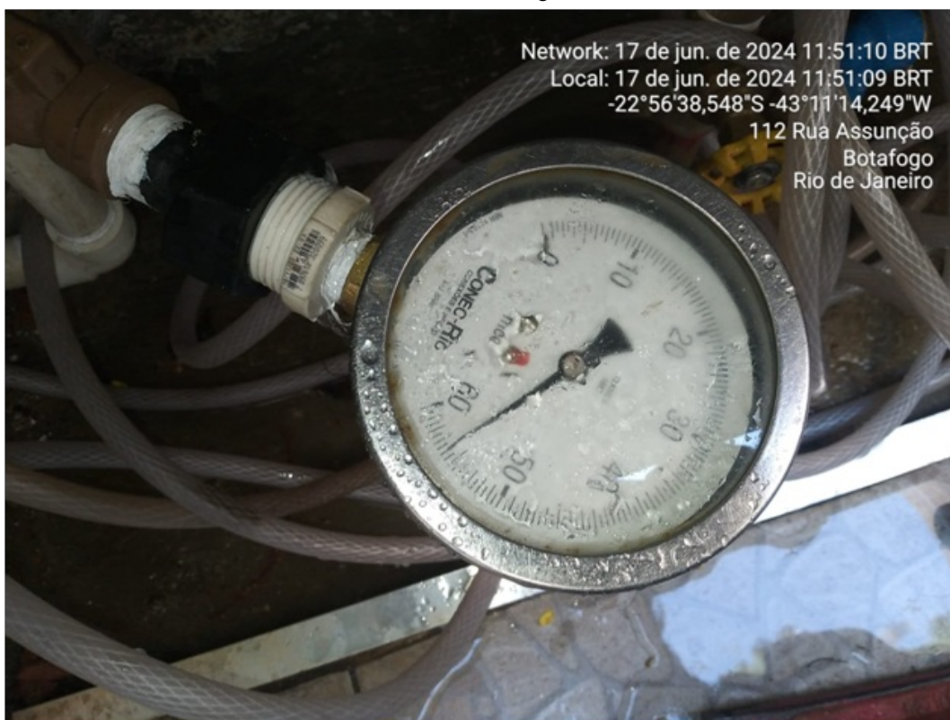
Foto 6 – Pressão averiguada casa 12 (56 mca)
