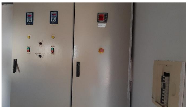
Painel elétrico vista externa
