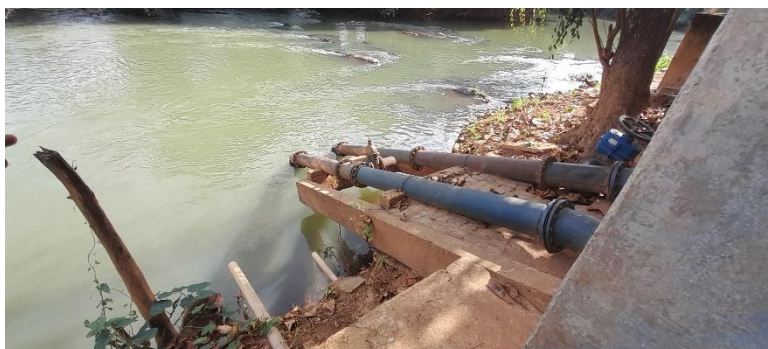
Dutos de adução vista 1
