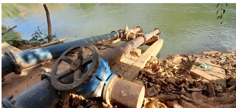
Dutos de adução vista 2
