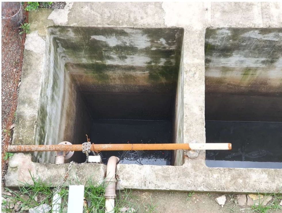
Elevatória da ETE
